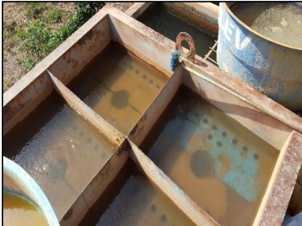
Figura 137. Floculador tipo bandeja da ETA de Baús
