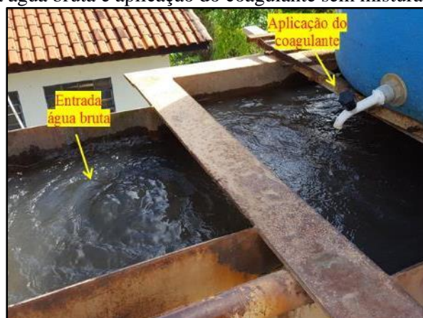
Figura 136. Entrada da água bruta e aplicação do coagulante sem mistura rápida na ETA de Baús
