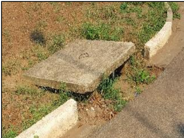
Figura 78. Boca de lobo inoperante devido ao assoreamento na Av. Nossa Senhora das Brotas no bairro Vó Geová
