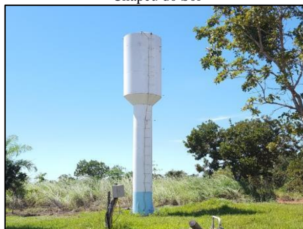
Figura 167. Reservatório (3) tipo taça de 6,0 m 3 para atendimento de parte da comunidade de Chapéu do Sol
