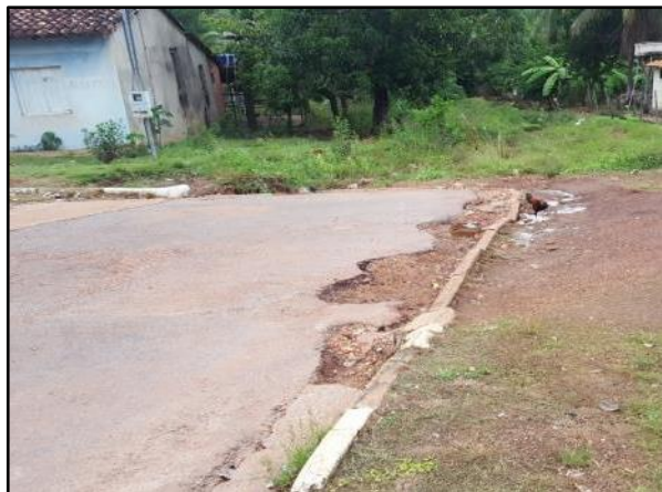
Figura 174. Asfalto deteriorado na Rua Gentil Corrêa Ventura em frente ao Posto de Saúde Aldeias
