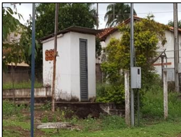
Figura 152. Cerca de proteção e abrigo do Quadro de comando da captação subterrânea do distrito de Aldeia
