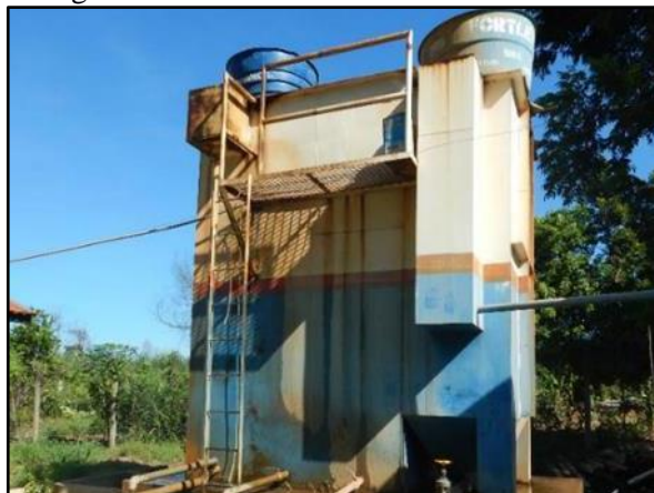
Figura 135. Floculador e decantador da ETA
