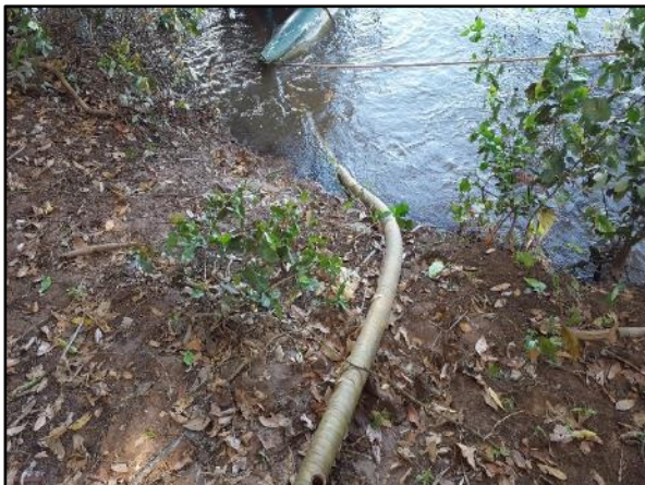
Figura 132. Mangote flexível conectando o conjunto motobomba da captação com a adutora em Baús
