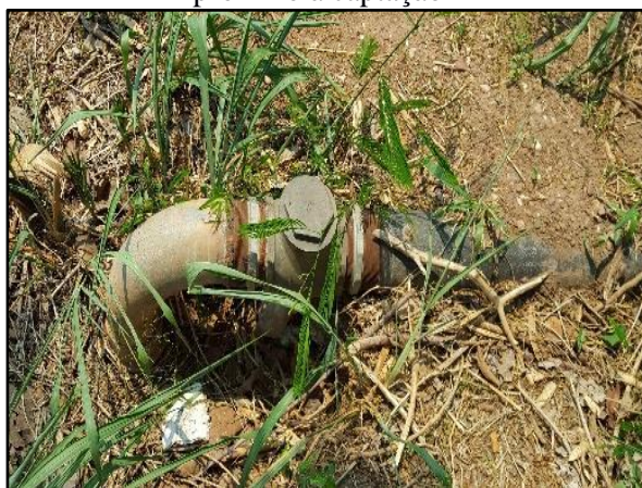
Figura 18. Válvula de retenção na adutora próximo à captação
