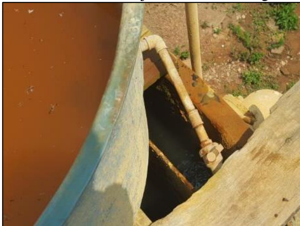
Figura 60. Dosagem da solução de sulfato de alumínio feito com ajuste manual no registro
