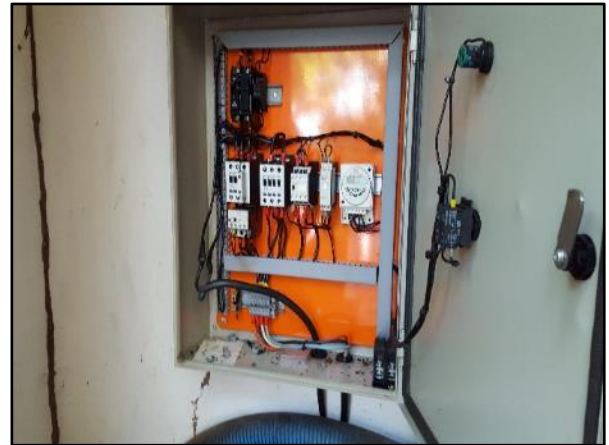
Figura 131. Quadro de comando da captação do distrito de Baús
