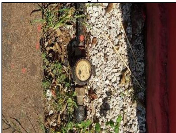
Figura 46. Hidrômetro com vida útil avançada instalado em ligação comercial
