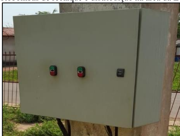
Figura 20. Caixa de proteção do quadro de comando do conjunto motobombas de recalque e distribuição na área da ETA
