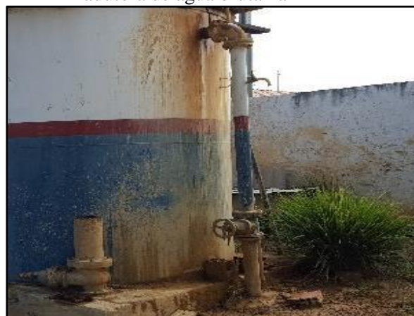
Figura 19. Registro de gaveta na entrada da adutora de água bruta na ETA
