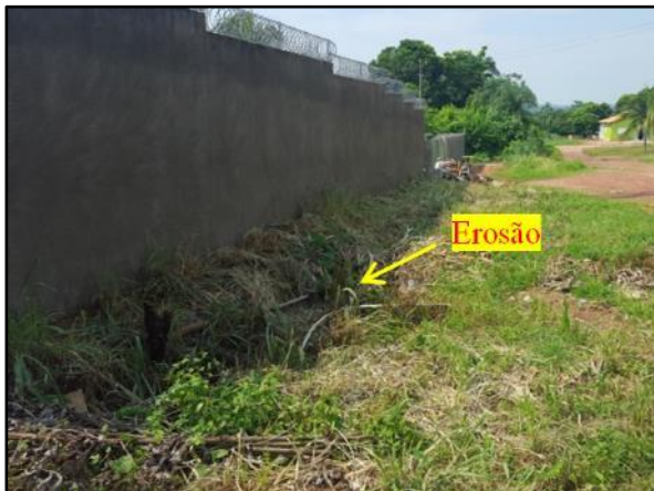
Figura 85. Erosão (1) formada próximo à Rua Honorato Pedroso de Barros no bairro Centro-
