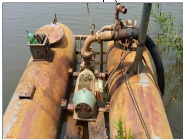
Figura 11. Conjunto motobomba instalado na balsa de captação
