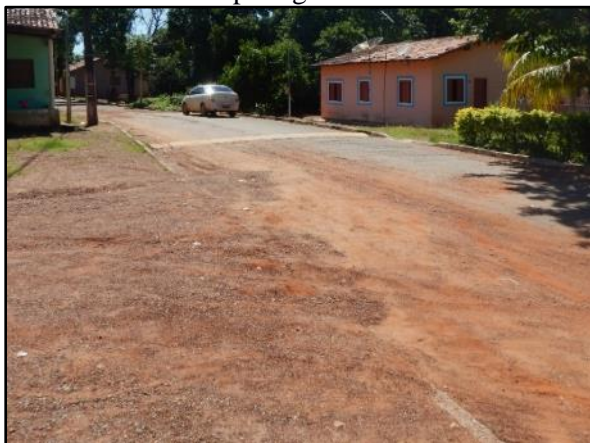
Figura 171. Material carregado por água de chuva na área urbana de Baús
