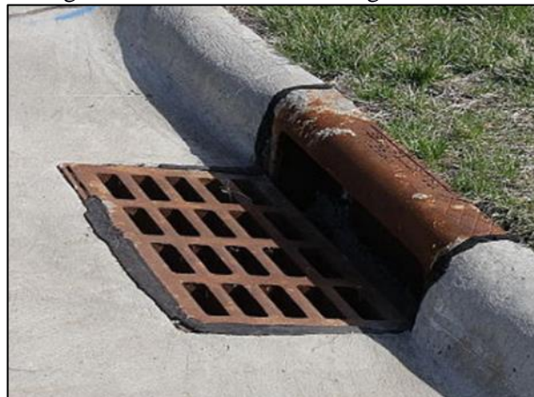
Figura 218. Boca de lobo com gradeamento
