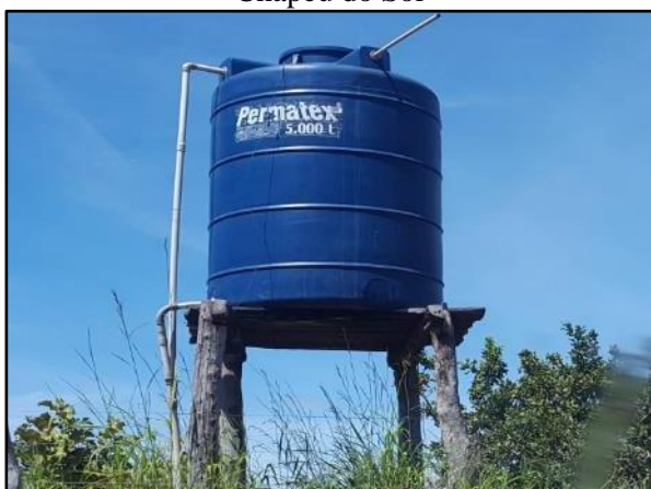
Figura 166. Reservatório (1) elevado de 5,0 m 3 para atendimento de parte da comunidade de Chapéu do Sol
