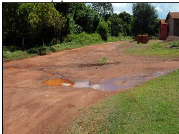
Figura 180. Erosão e empoçamento na área urbana do distrito de Aldeia
