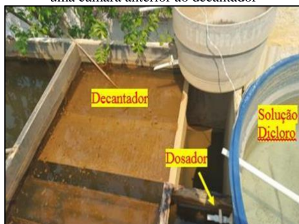
Figura 32. Ponto de aplicação da solução de cloro em uma câmara anterior ao decantador
