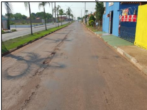
Figura 87. Trecho da Av. Nossa Senhora de Brotas onde ocorre alagamento
