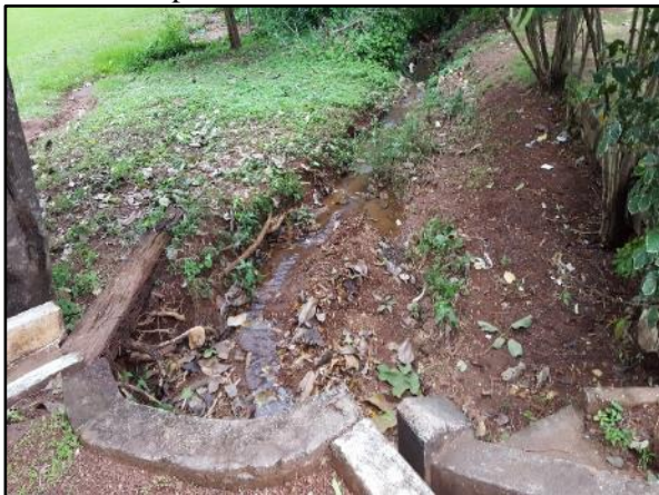
Figura 178. Erosão na saída rápida das águas pluviais da via de Aldeia
