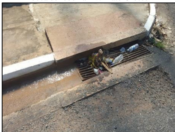
Figura 103. Resíduos acumulados na grade da boca de lobo na Av. Mato Grosso
