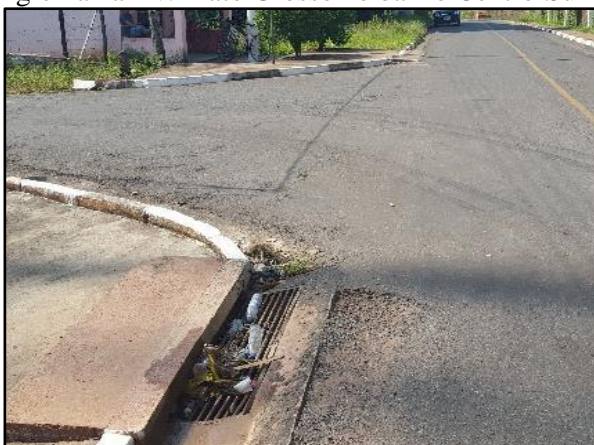
Figura 70. Boca de lobo com lixo acumulado na grelha na Av. Mato Grosso no bairro Centro-Sul
