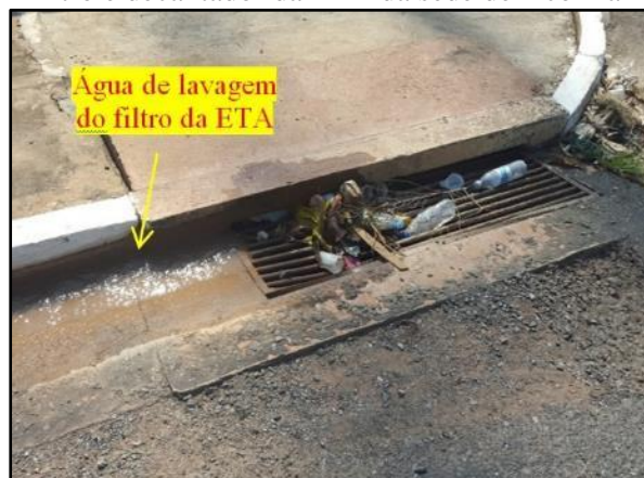
Figura 30. Boca de lobo coletora do efluente da lavagem do filtro e decantador da ETA da sede de Acorizal
