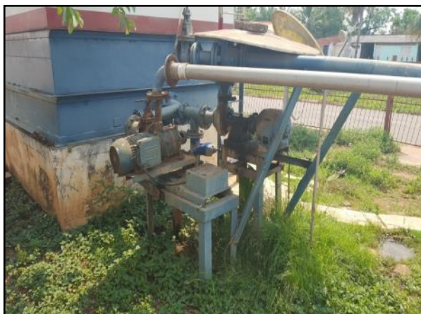
Figura 37. Conjunto motobomba conectados no filtro para recalque da água tratada para os reservatórios
