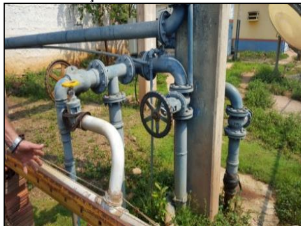
Figura 43. Barrilete do reservatório elevado para setorização da distribuição localizado abaixo do REL-01
