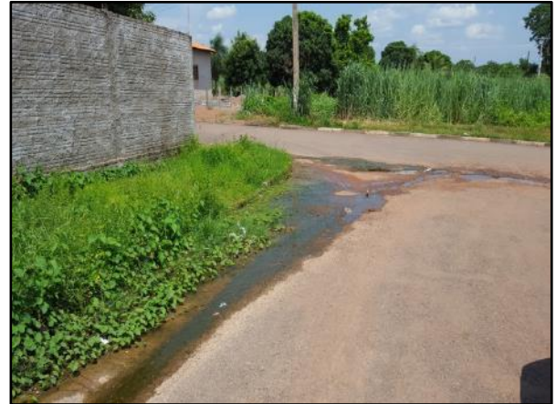
Figura 63. Lançamento de efluente no cruzamento da Rua Amâncio Ramos com a Av. Hermelando Pereira de Sá
