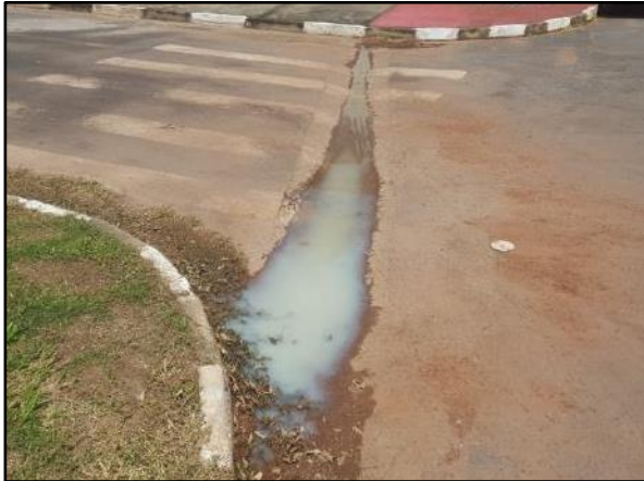
Figura 62. Lançamento de efluente no cruzamento da Av. Honorato Pedroso com a Rua Benedito Craveiro Teixeira
