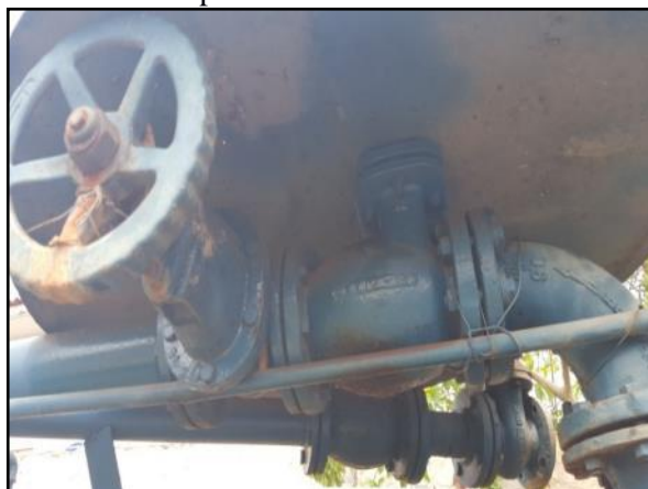
Figura 38. Válvula de retenção e registro de gaveta nas tubulações de recalque de água tratada para os reservatórios
