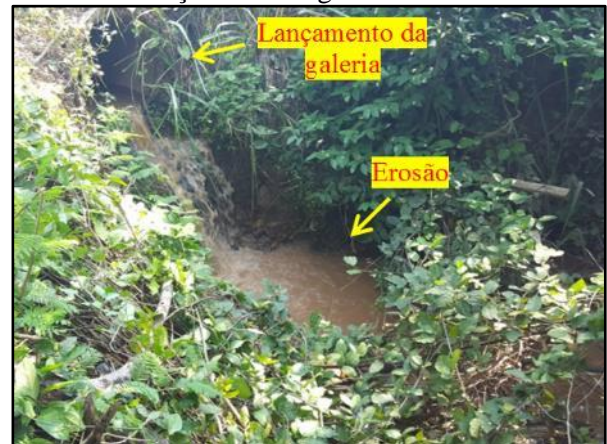
Figura 86. Erosão (2) formada na margem do rio Cuiabá no lançamento da galeria da Av. Beira Rio
