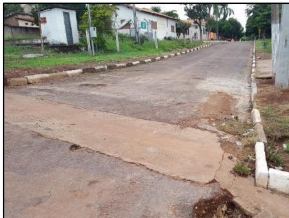
Figura 175. Asfalto deteriorado na Av. Nossa Senhora Santana em frente ao poço de Aldeia
