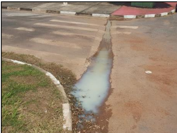
Figura 82. Lançamento de águas residuais no cruzamento da Rua Benedito Craveiro Filho com a Rua Honorato Pedroso de Barros
