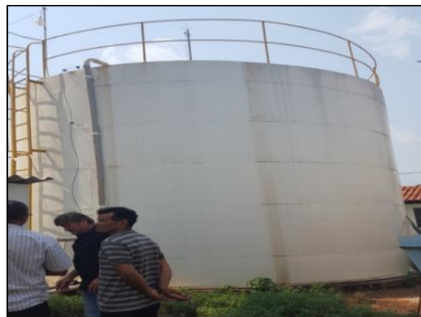
Figura 36. Reservatório apoiado (RAP-01) de 150 m 3 na área da ETA
