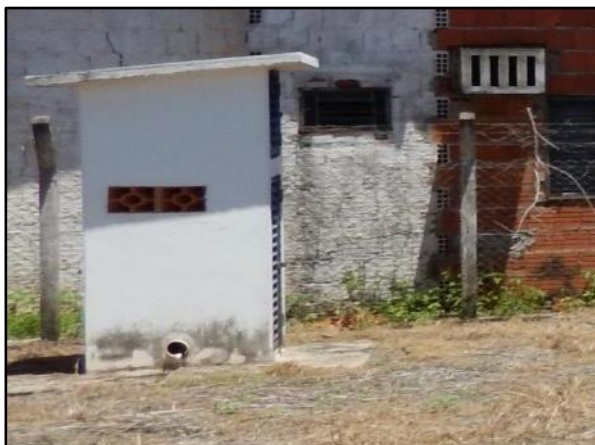
Figura 153. Abrigo do clorador do distrito de Aldeia
