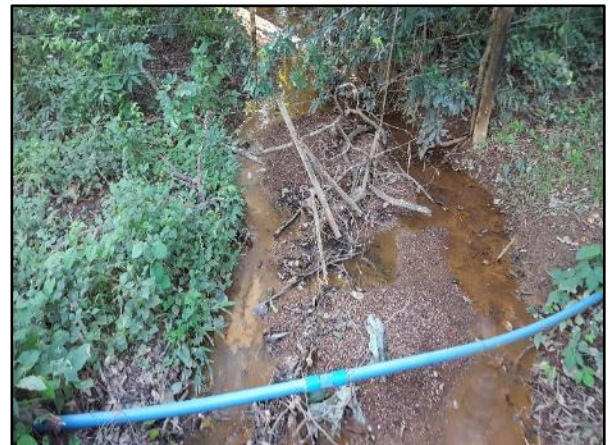
Figura 133. Travessia da adutora de água bruta DN 75 mm no distrito de Baús
