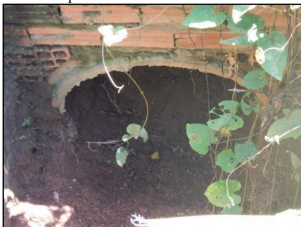
Figura 170. Travessia de águas pluviais assoreada sob rua pavimentada na área urbana de Baús
