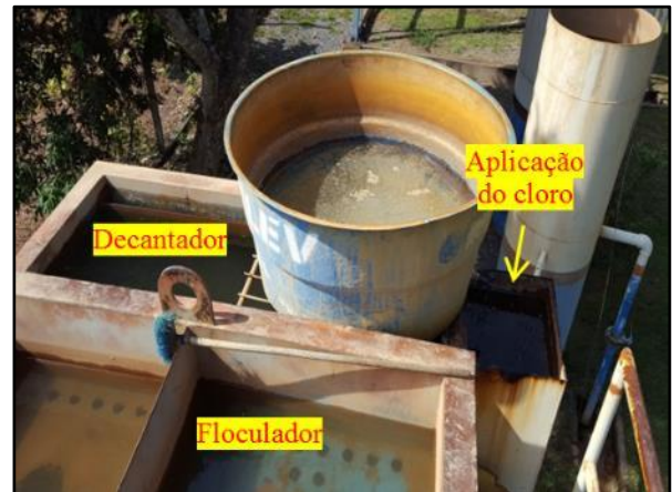
Figura 138. Ponto de aplicação do cloro no decantador
