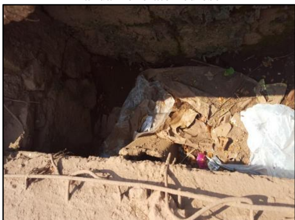
Figura 102. Resíduos acumulados na boca de lobo na rua Honorato Pedroso
