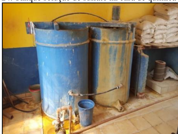
Figura 24. Tanque solução de sulfato na casa de química da ETA
