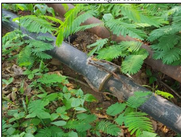
Figura 16. Tubulação de ferro fundido DN 100 mm da adutora de água bruta
