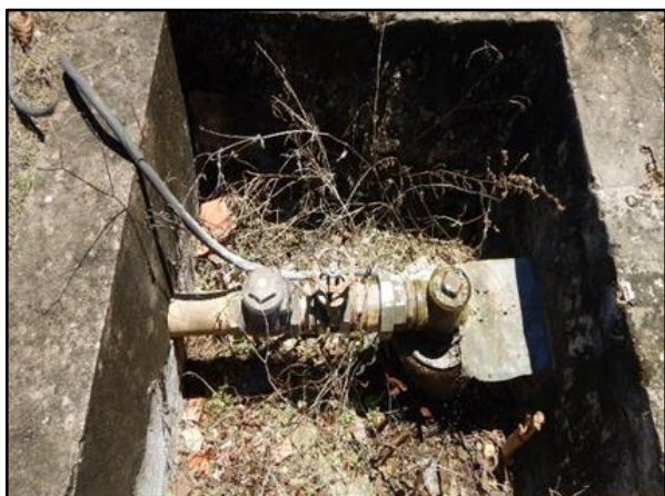
Figura 151. Poço tubular do distrito de Aldeia
