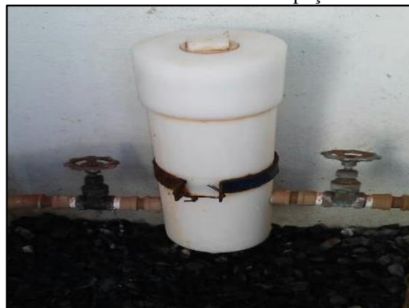
Figura 154. Clorador tipo passagem inativo conectado na adutora do poço
