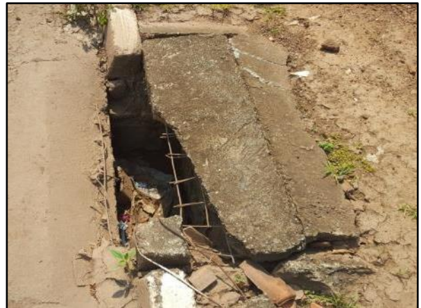
Figura 79. Lixo acumulado e tampa danificada na boca de lobo na Av. Honorato Pedroso de Barros no bairro Centro-Norte
