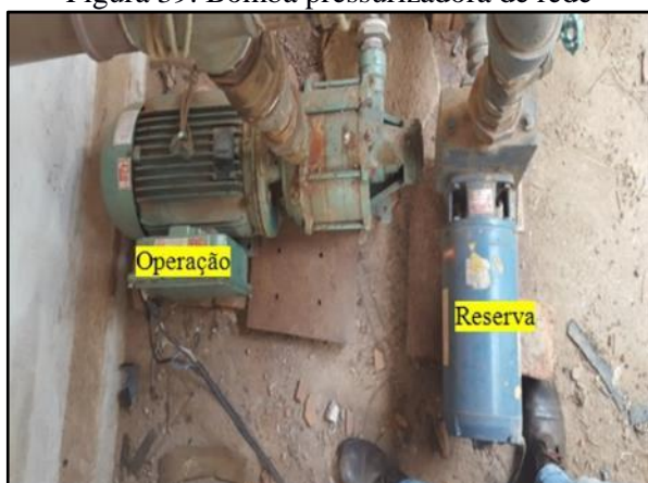
Figura 39. Bomba pressurizadora de rede
