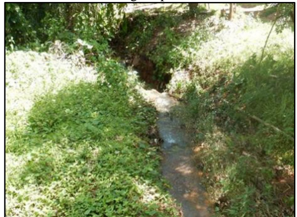
Figura 179. Trecho da erosão formada pelo escoamento das águas pluviais em Aldeia
