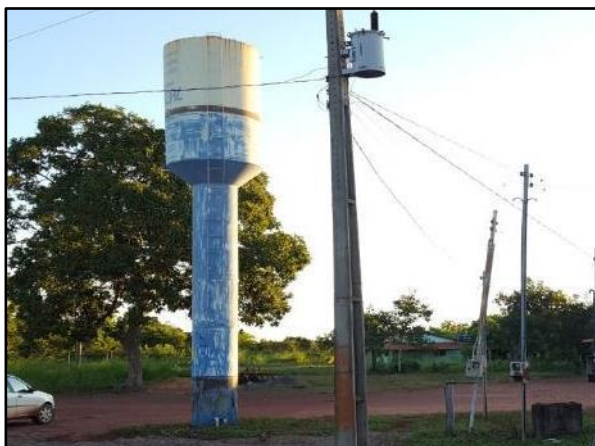
Figura 164. Reservatório de 6,0 m 3 da comunidade de Aleixo
