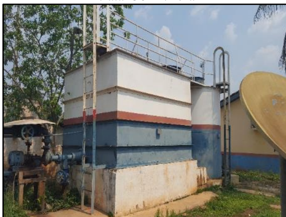
Figura 21. ETA metálica com capacidade para tratar 50 m 3 /hora
