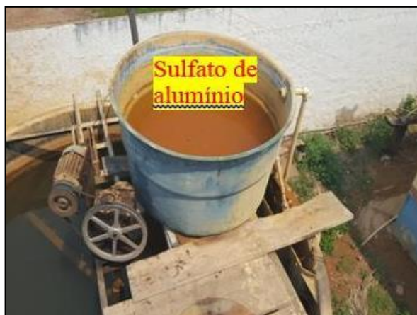
Figura 23. Reservatório com solução de sulfato de alumínio sobre a câmara de floculação
