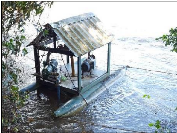
Figura 130. Captação superficial no rio Cuiabá do distrito de Baús
