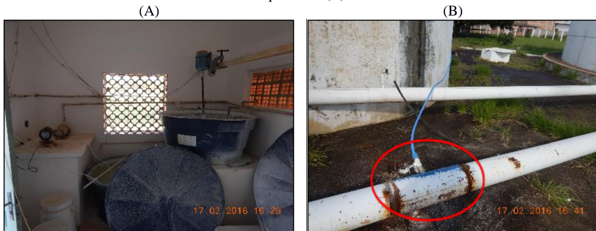
Figura 15. Caixa d'água com a solução de hipoclorito (A) e orifício de dosagem da solução de hipoclorito (B)
