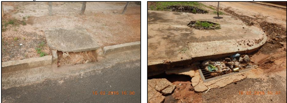
Figura 42. Acúmulo de resíduos nas bocas de lobo devido ausência de manutenção
