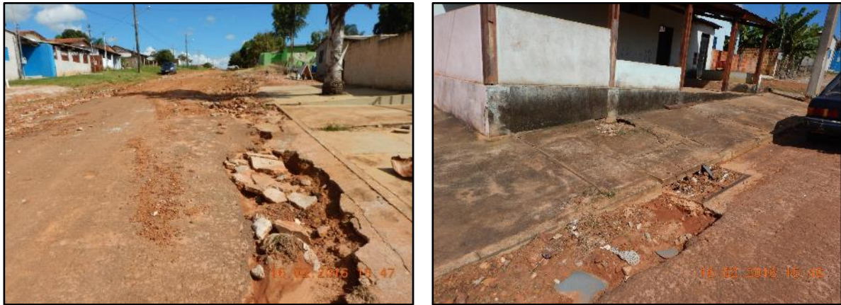
Figura 43. Meio-fio e sarjeta danificados (A) e boca de lobo obstruída (B) (A) (B)
