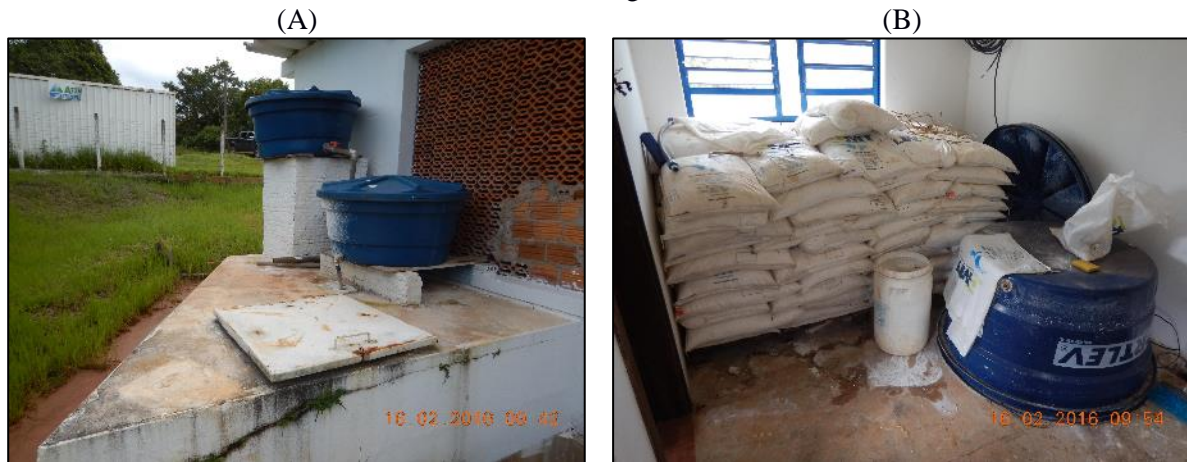
Figura 14. Caixas d'água com solução de sulfato (A) e acondicionamento do sulfato de alumínio (B) no abrigo
