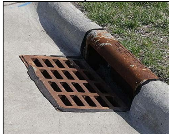
Figura 85. Boca de lobo com gradeamento na sarjeta
