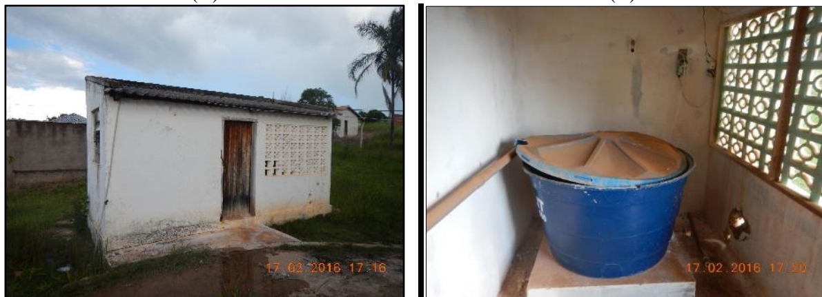
Figura 17. Abrigo sistema de cloração (A) e caixa d'água com a solução de hipoclorito de cálcio (B)
