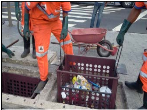
Figura 84. Cesta acoplada a boca do bueiro
