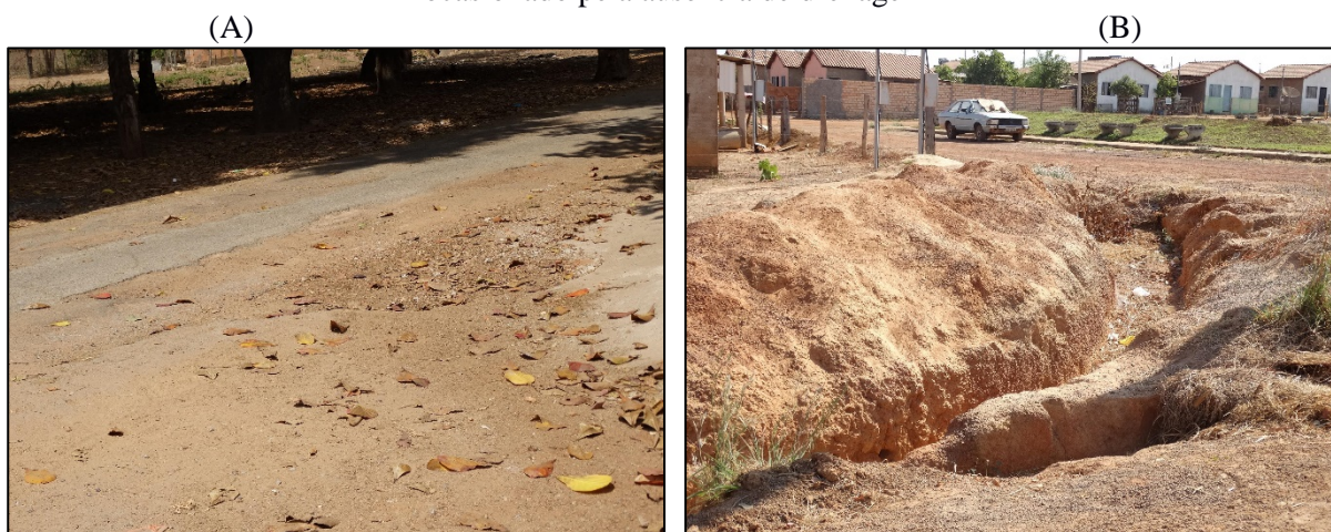
Figura 26. (A) Rua pavimentada coberta por erosão e sedimentos (B) Rua sem pavimento com erosão ocasionado pela ausência de drenagem
