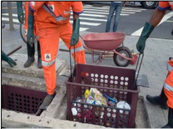
Figura 56. Cesta acoplada a bueiro
