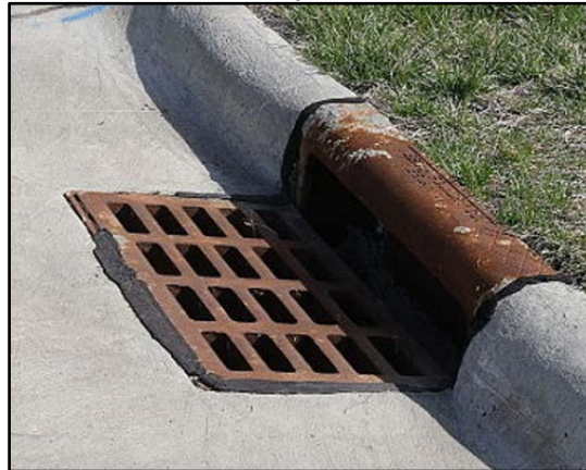
Figura 57. Boca de lobo com gradeamento na sarjeta
