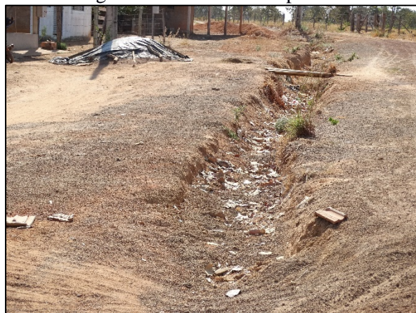
Figura 24. Erosão na via pública
