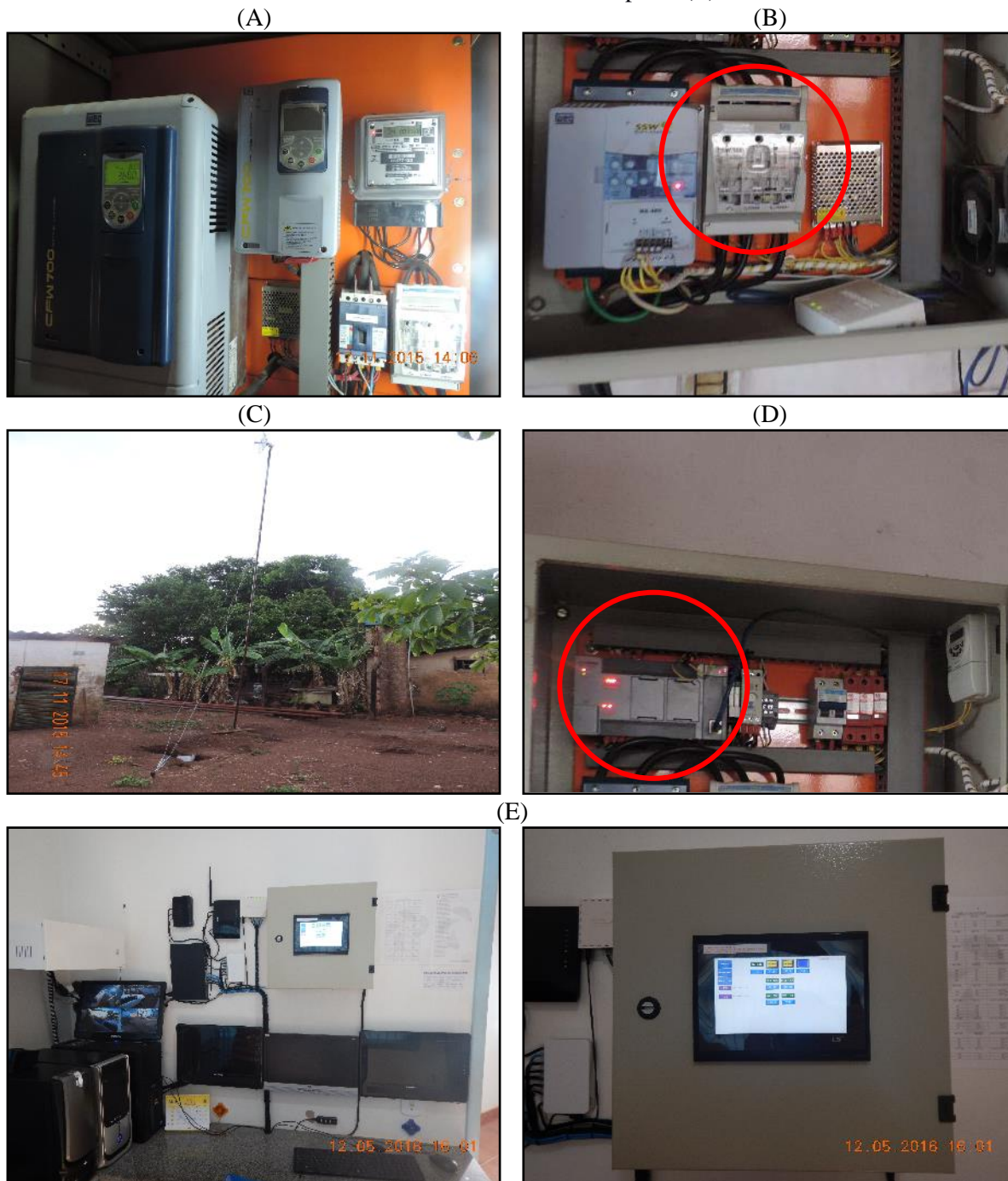
Figura 9. Chave soft-start (A), chave seccionadora (B), antena de telemetria (C), CLP (D) e controlador IHM na sede da empresa (E)
