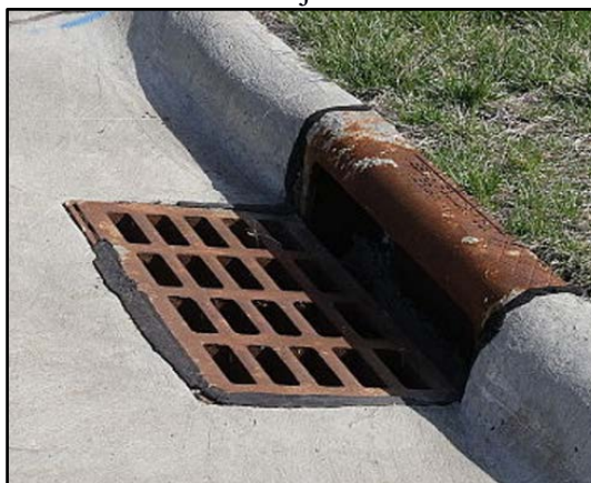
Figura 83. Boca de lobo com gradeamento na sarjeta
