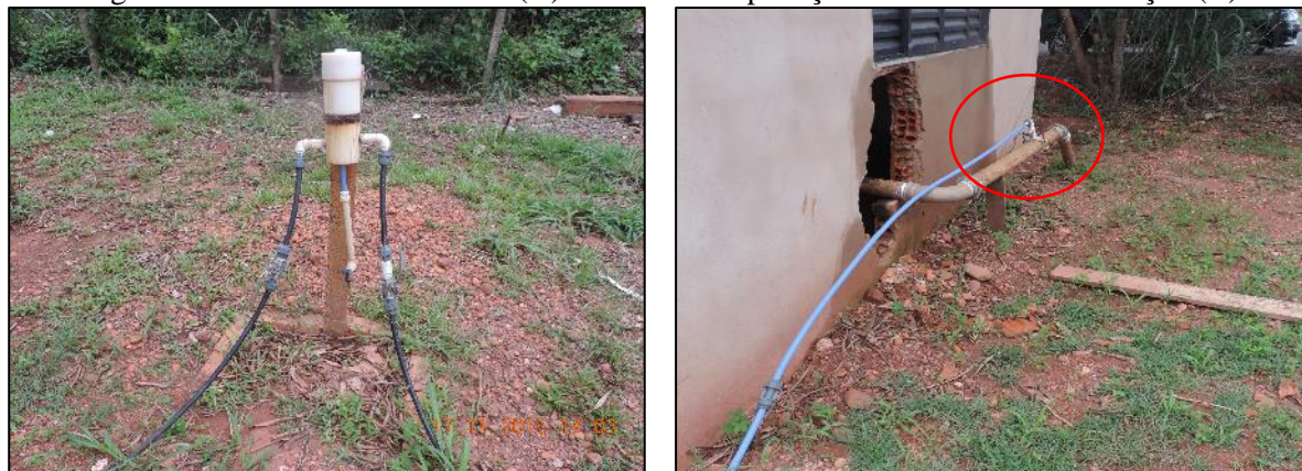
Figura 10. Cloradores de contato (A) e detalhe da aplicação diretamente na tubulação (B)
