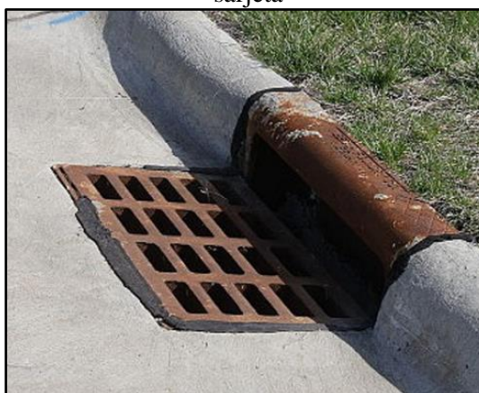
Figura 126. Boca de lobo com gradeamento na sarjeta
