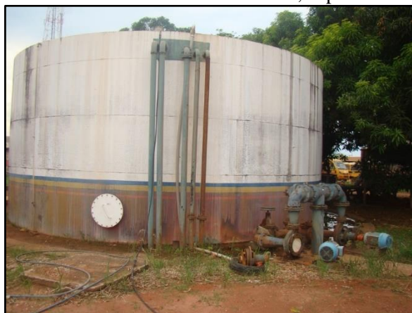
Figura 19. Reservatório elevado REL – 01, capacidade de 75 m 3
