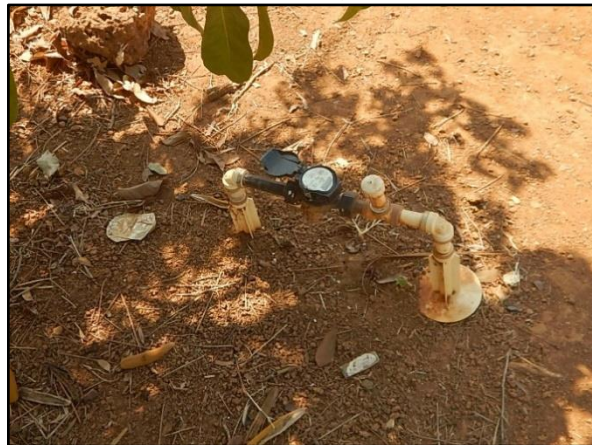
Figura 92. Cavalete com hidrômetro, Mundo Novo, Brasnorte-MT
