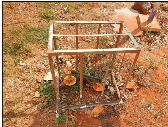
Figura 71. Cavalete sem hidrômetro, São Bento, Brasnorte-MT
