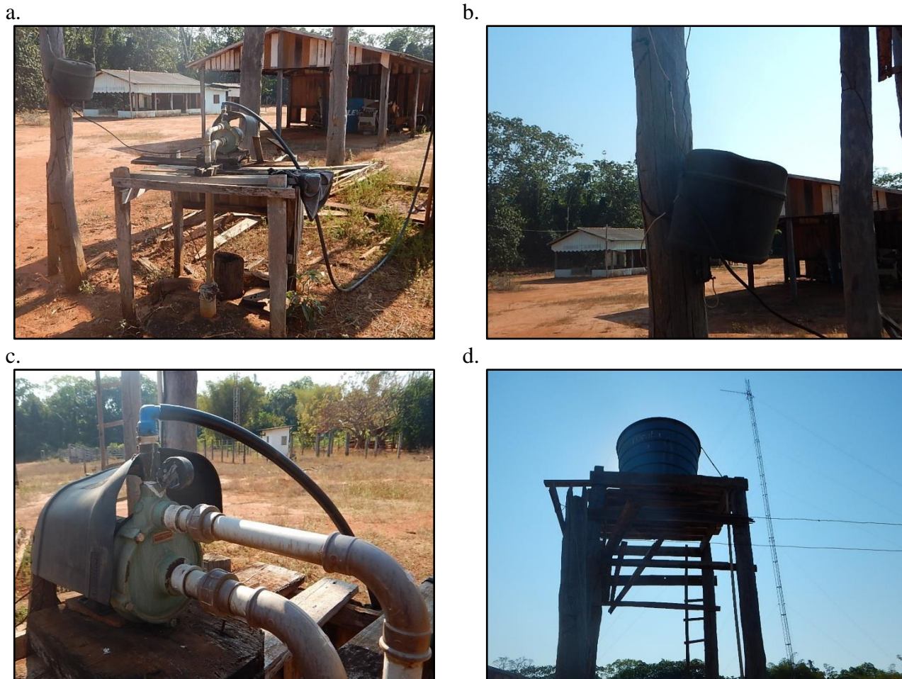
Figura 101. Vista da boca do poço tubular (a), quadro de comando (b), bomba de eixo horizontal (c) e reservatório (d), Bom Futuro, Brasnorte-MT
