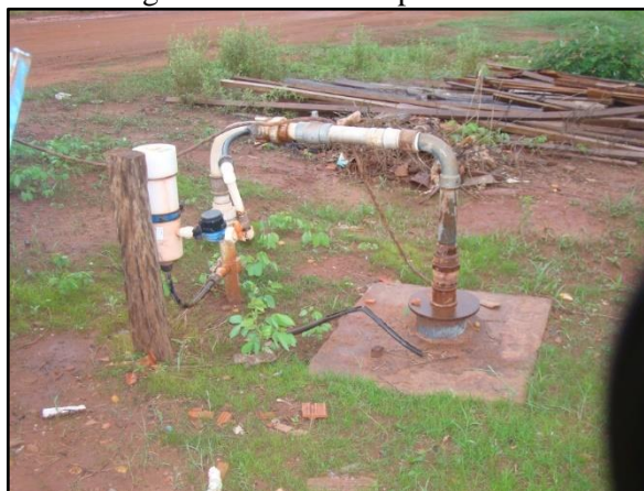
Figura 20. Clorador tipo contacto
