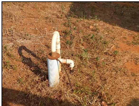
Figura 72. Poço tubular individual com bomba submersa, São Bento, Brasnorte-MT
