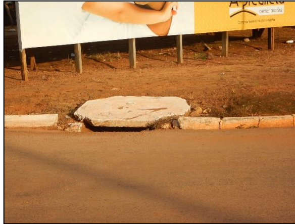
Figura 30. Situação dos dispositivos de microdrenagem de Brasnorte
