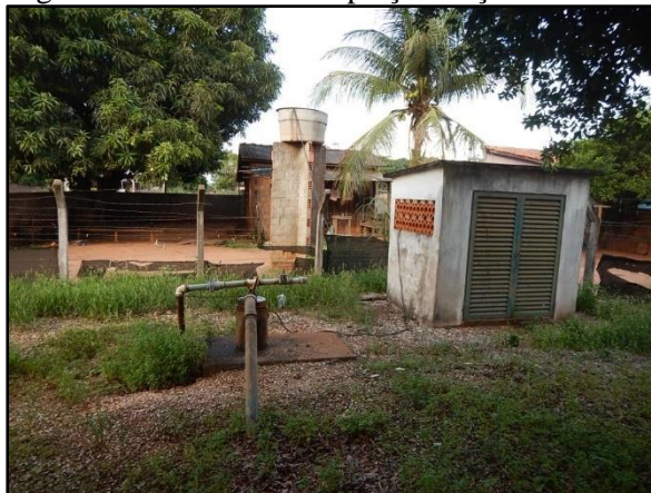
Figura 15. Estrutura de captação Poço Tubular 08
