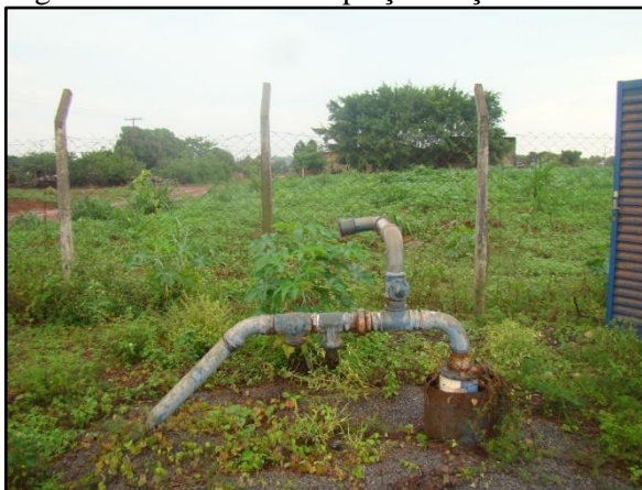
Figura 16. Estrutura de captação Poço Tubular 09
