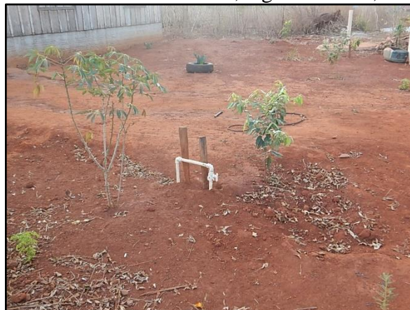
Figura 81. Cavalete sem hidrômetro, Água da Prata, Brasnorte-MT
