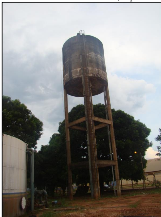
Figura 18. Reservatório elevado REL – 01, capacidade de 150 m 3
