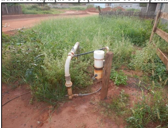
Figura 13. Estrutura de captação do poço tubular 06 e dispositivo de cloração
