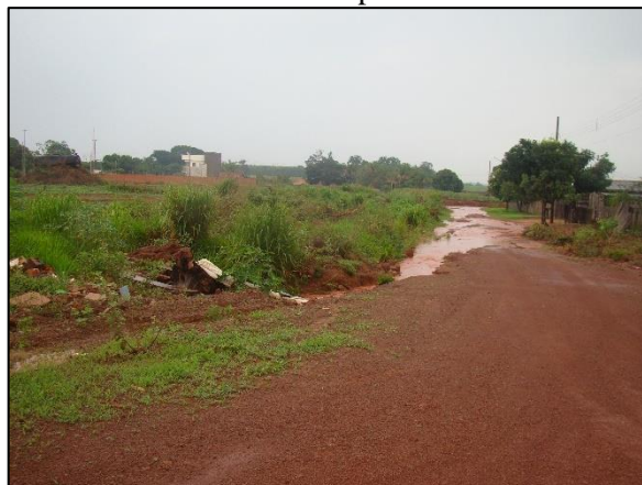
Figura 32. Erosão nas vias não pavimentadas de Brasnorte
