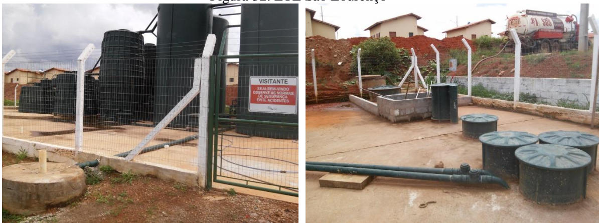
Figura 32. ETE São Lourenço
