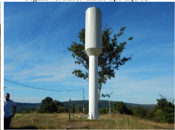
Figura 76. Reservatório tipo taça 02
