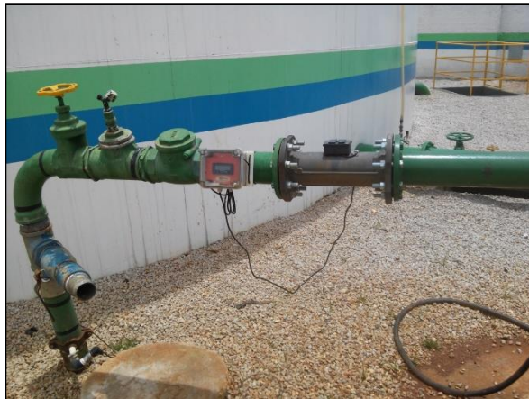
Figura 18. Instrumento de automação na saída do cavalete
