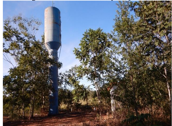
Figura 74. Reservatório tipo taça 01
