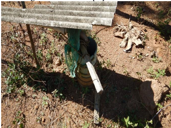
Figura 91. Cavalete poço tubular 02
