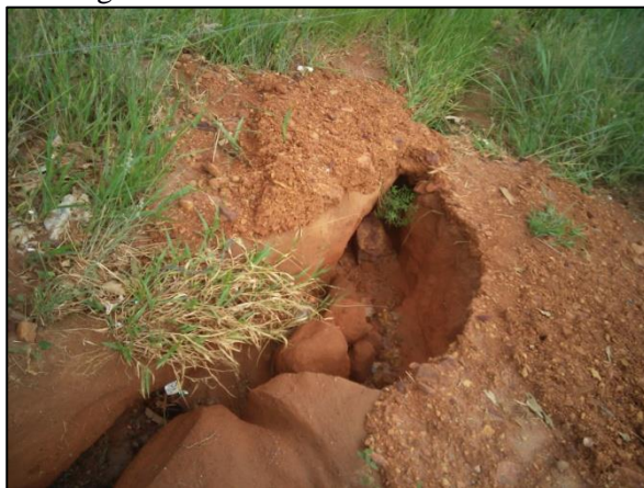
Figura 45. Ponto com início de erosão
