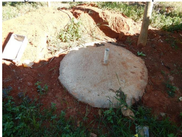
Figura 87. Tampa da fossa com o suspeiro
