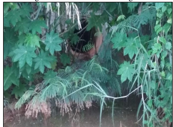
Figura 38. Emissário de drenagem
