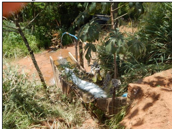
Figura 35. Ponto de desague da EEE.
