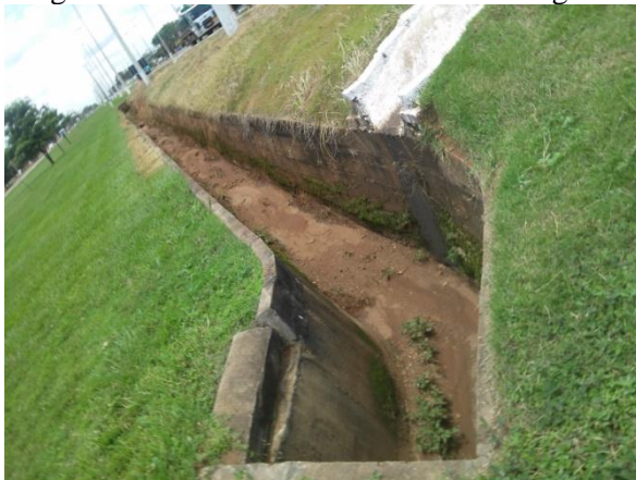
Figura 37. Canal de escoamento de drenagem
