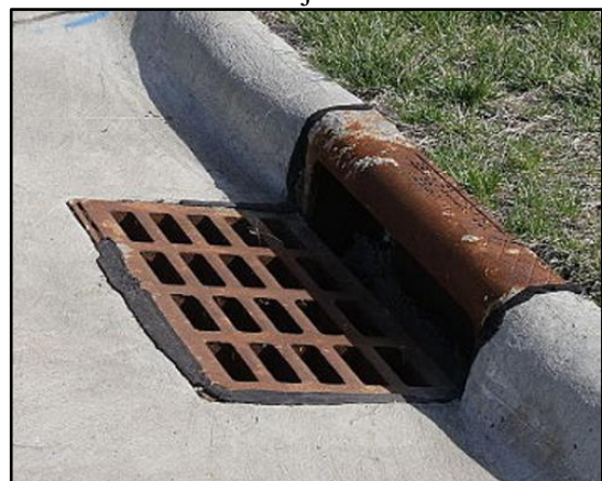
Figura 52. Boca de lobo com gradeamento na sarjeta
