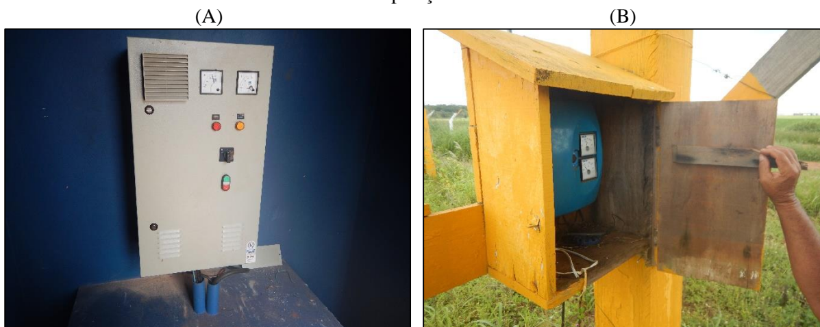
Figura 9. (A) Abrigo para o quadro de comando (B) Quadro de comando do PT-04 no parque de exposições
