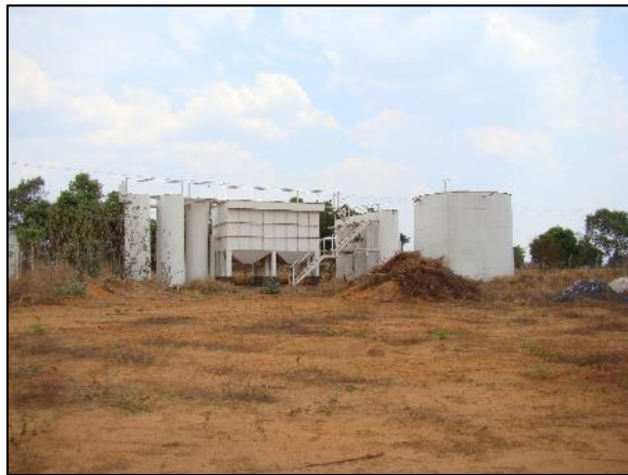
Placas do decantador da ETA danificadas
