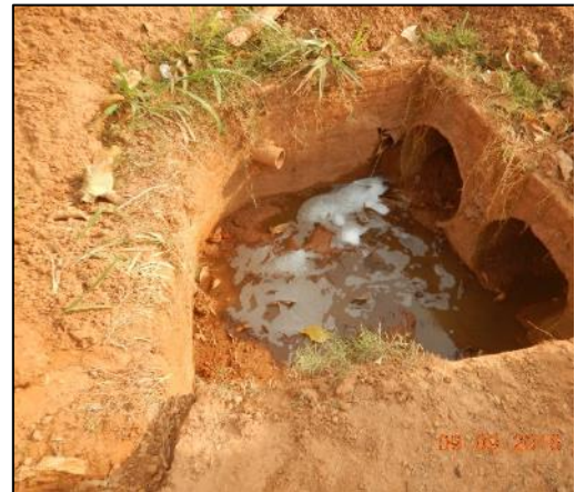
Figura 34. Lançamento de esgoto na travessia urbana
