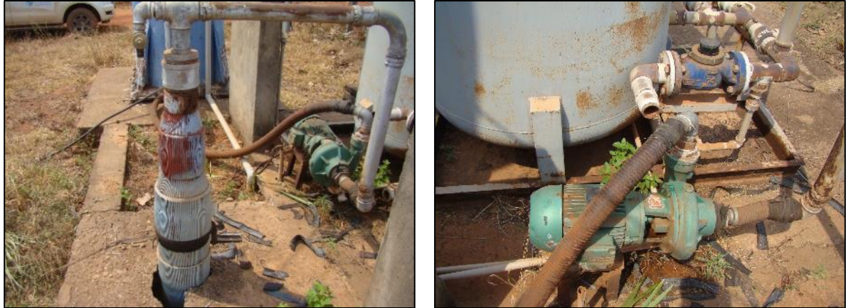
Figura 54. Vista do poço tubular profundo (esq.) e bomba de recalque utilizada (dir.)
