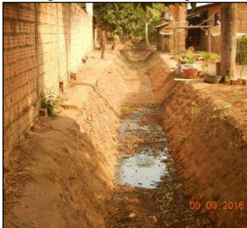
Figura 33. Ligação clandestina de esgoto no canal de drenagem
