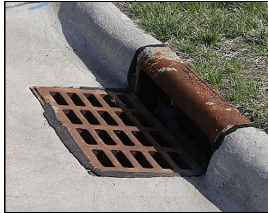
Figura 85. Boca de lobo com gradeamento na sarjeta
