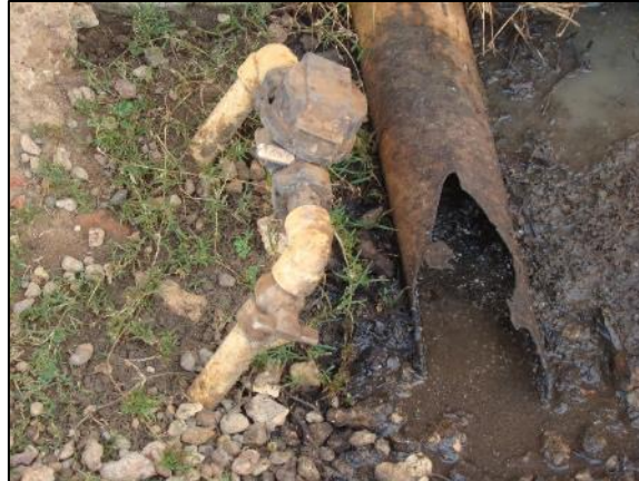
Figura 25. Ligação domiciliar de água próxima ao ponto de lançamento de esgoto a céu aberto
