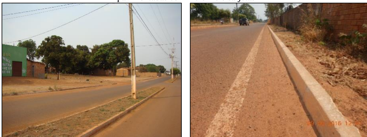
Figura 31. Dispositivos de microdrenagem existentes no núcleo urbano de Canabrava do Norte, vias pavimentadas com meio-fio e sarjetas
