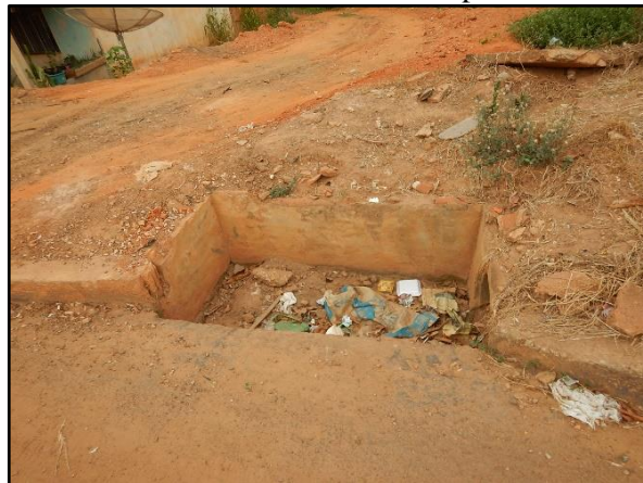
Figura 41. Boca de lobo com resíduos impedindo escoamento
