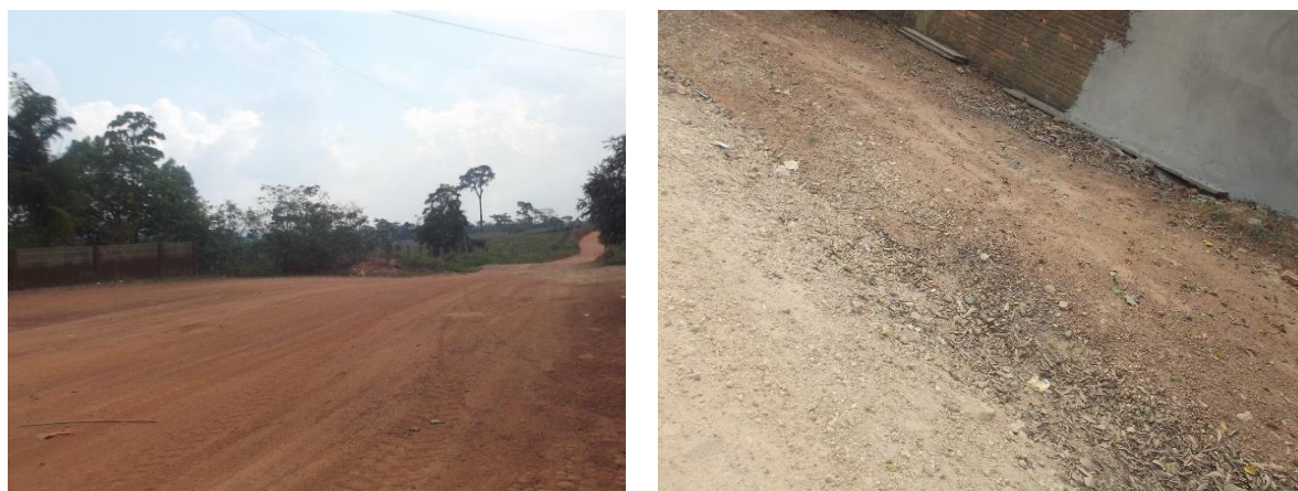
Figura 73. Via não pavimentada (a) e processo erosivos (b), Novo Horizonte, Castanheira-MT
