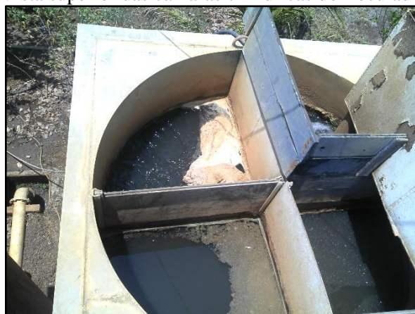
Figura 15. Vista superior das câmaras cilíndricas do floculador hidráulico
