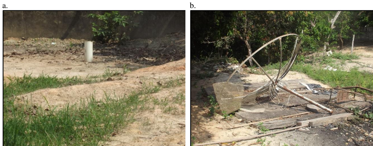
Figura 58. Vista exterior de fossa coberta com madeira (a) e fossa com suspiro (a), Nova Conquista, Castanheira-MT
