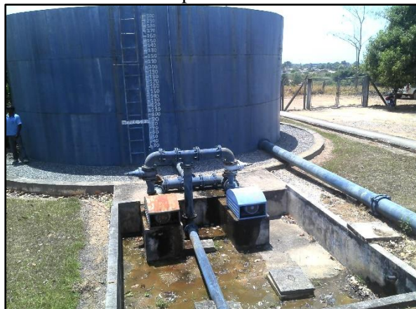
Figura 22. Reservatório apoiado metálico de 300 m 3 - R01
