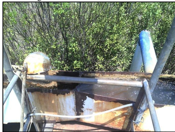
Figura 13. Calha Parshall metálica
