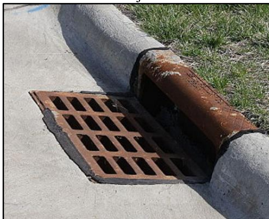
Figura 113. Boca de lobo com gradeamento na sarjeta
