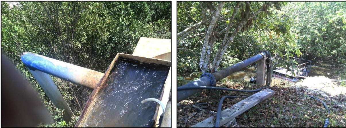
Figura 11. Adutora de água bruta em ferro fundido de 200 mm
