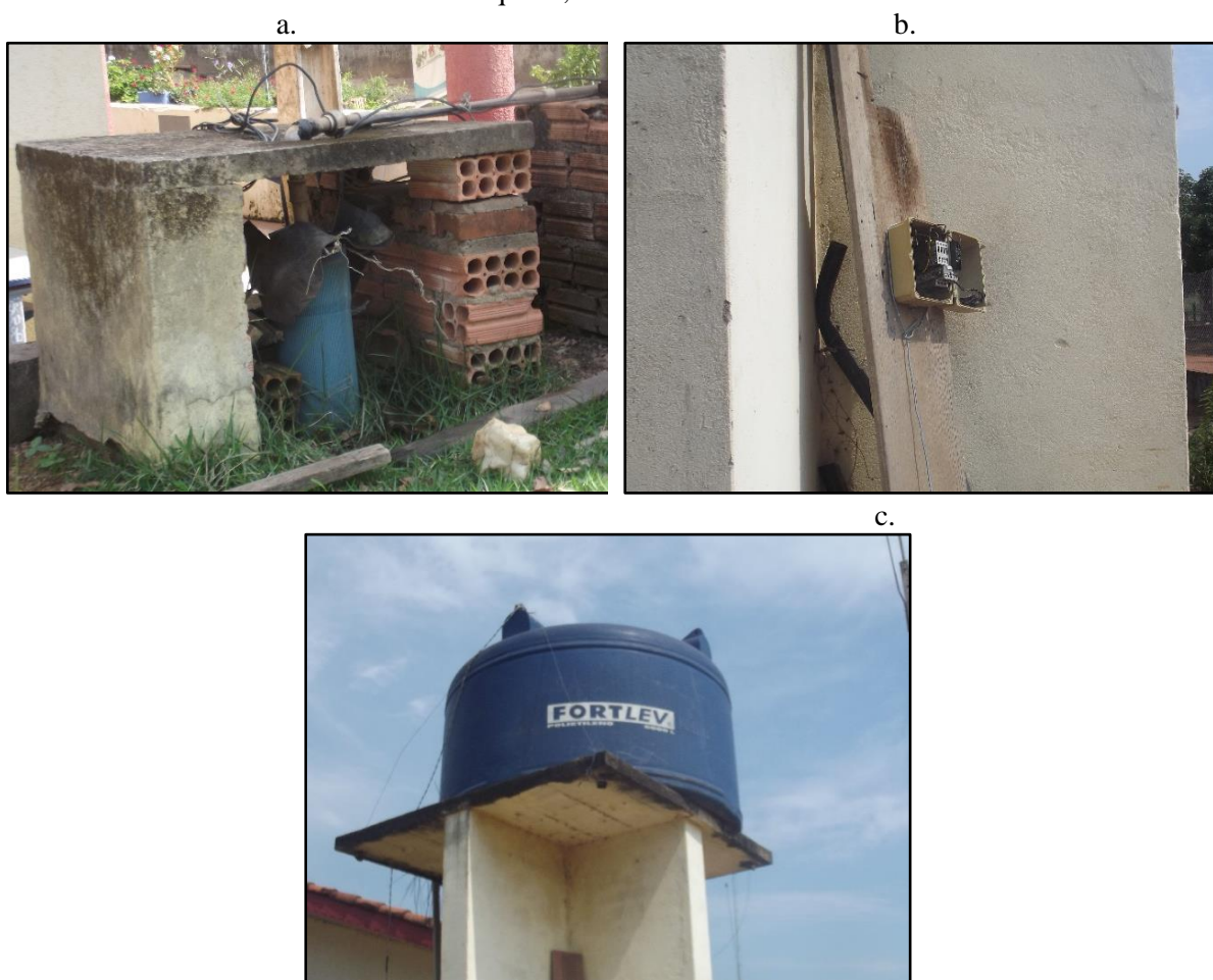
Figura 55. Vista da boca do poço tubular (a), quadro de comando (b) e reservatório (c), Nova Conquista, Castanheira-MT
