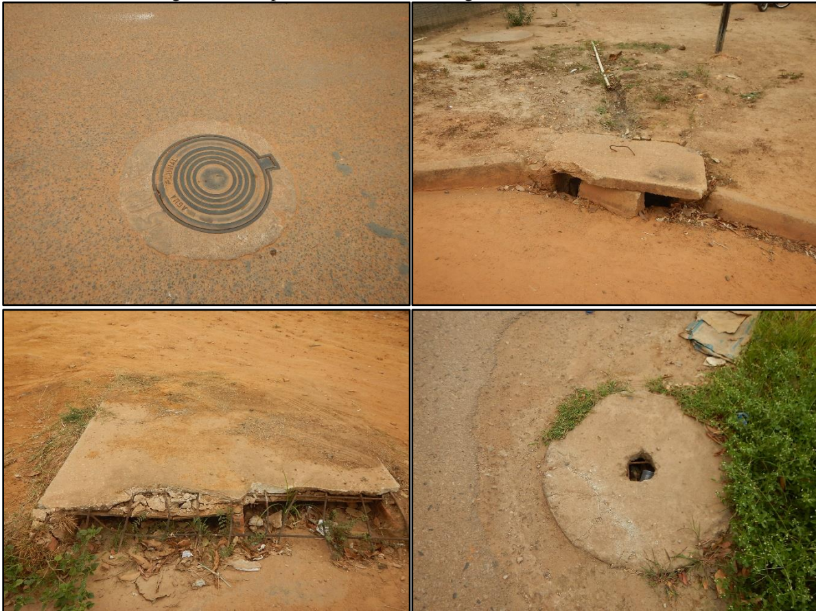
Figura 30. Dispositivos de microdrenagem em Castanheira-MT
