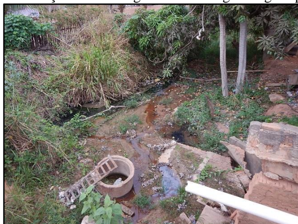
Figura 32. Lançamento de esgoto em descarga de águas pluviais
