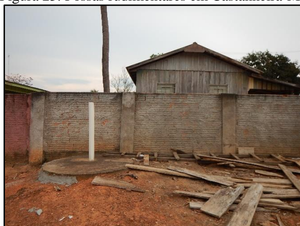
Figura 25. Fossas rudimentares em Castanheira-MT
