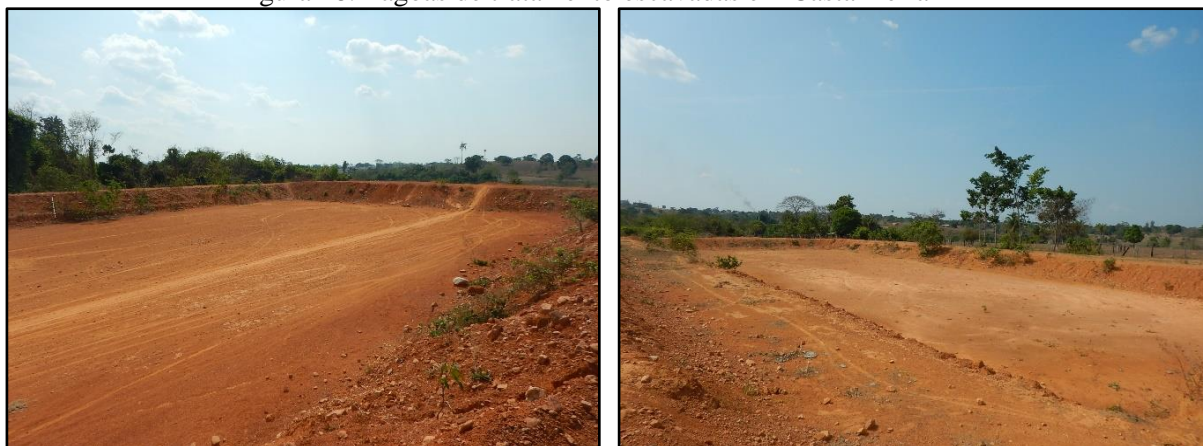
Figura 28. Lagoas de tratamento escavadas em Castanheira-MT
