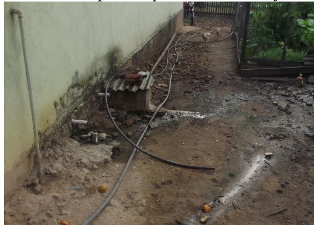
Figura 91. Disposição de efluente de pia e tanque a céu aberto, Projeto Casulo, Castanheira-MT
