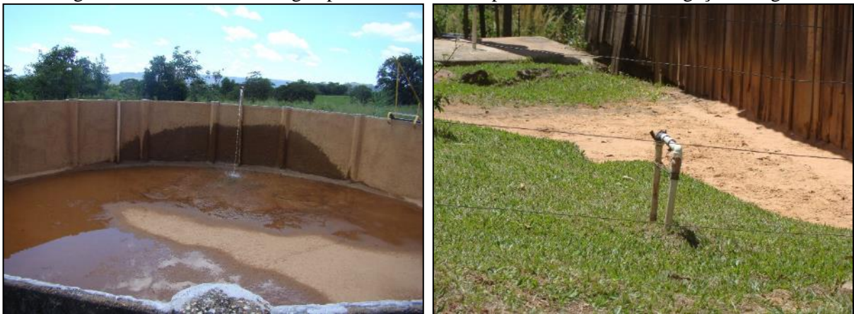
Figura 60. Reservatório de água para abastecimento publico e cavalete de ligação de água
