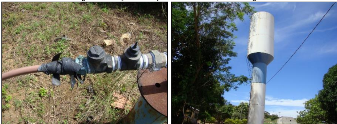
Figura 64. Poço tubular profundo e reservatório de água
