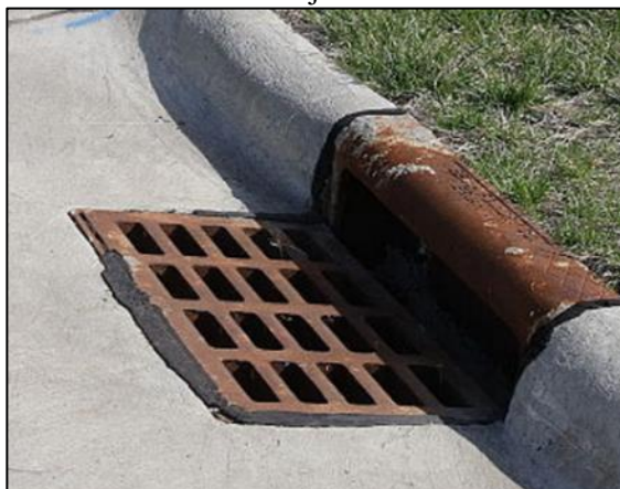
Figura 107. Boca de lobo com gradeamento na sarjeta
