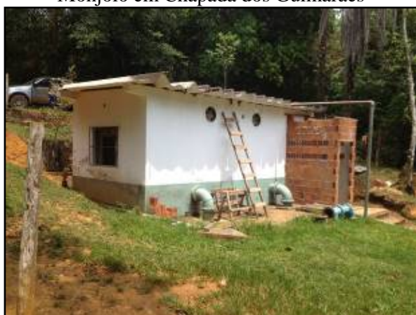
Figura 12. Casa de bombas da captação do Monjolo em Chapada dos Guimarães
