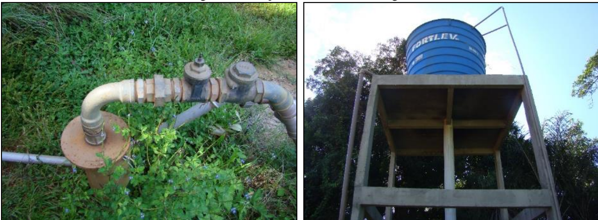
Figura 84. Poço e reservatório de água
