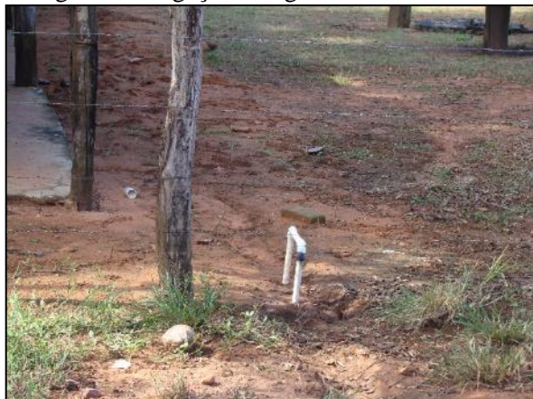
Figura 85. Ligação de água não hidrometrada
