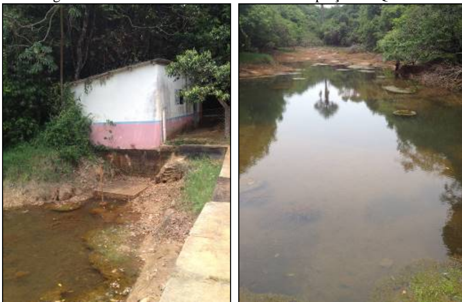
Figura 16. Casa de bombas e manancial da captação do Quineira
