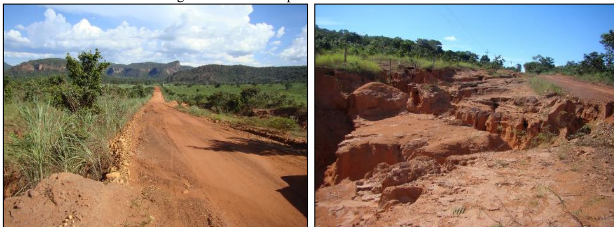
Figura 86. Vias não pavimentadas e com erosões
