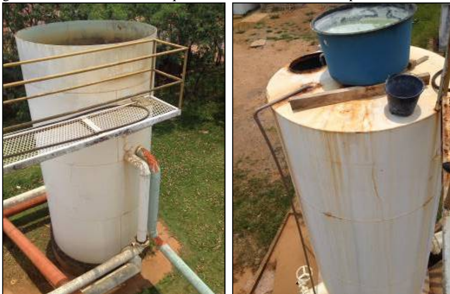
Figura 22. Filtro da ETA e tanque de contato da ETA de Chapada dos Guimarães
