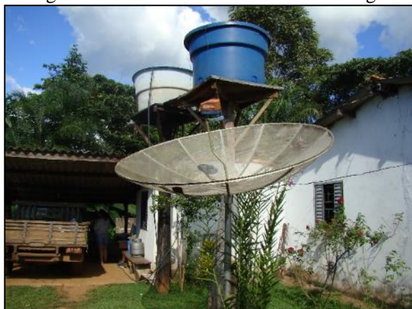
Figura 78. Reservatórios individuais de água
