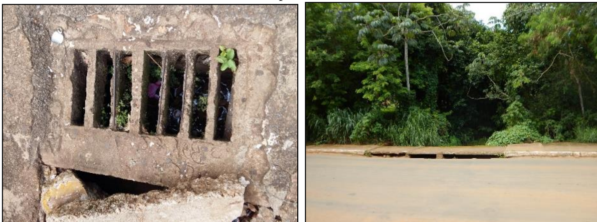
Figura 34. Bocas de lobo com e sem grelha, componentes do sistema de microdrenagem de águas pluviais
