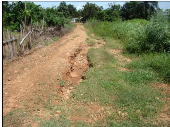
Figura 82. Traços de erosão em via não pavimentada
