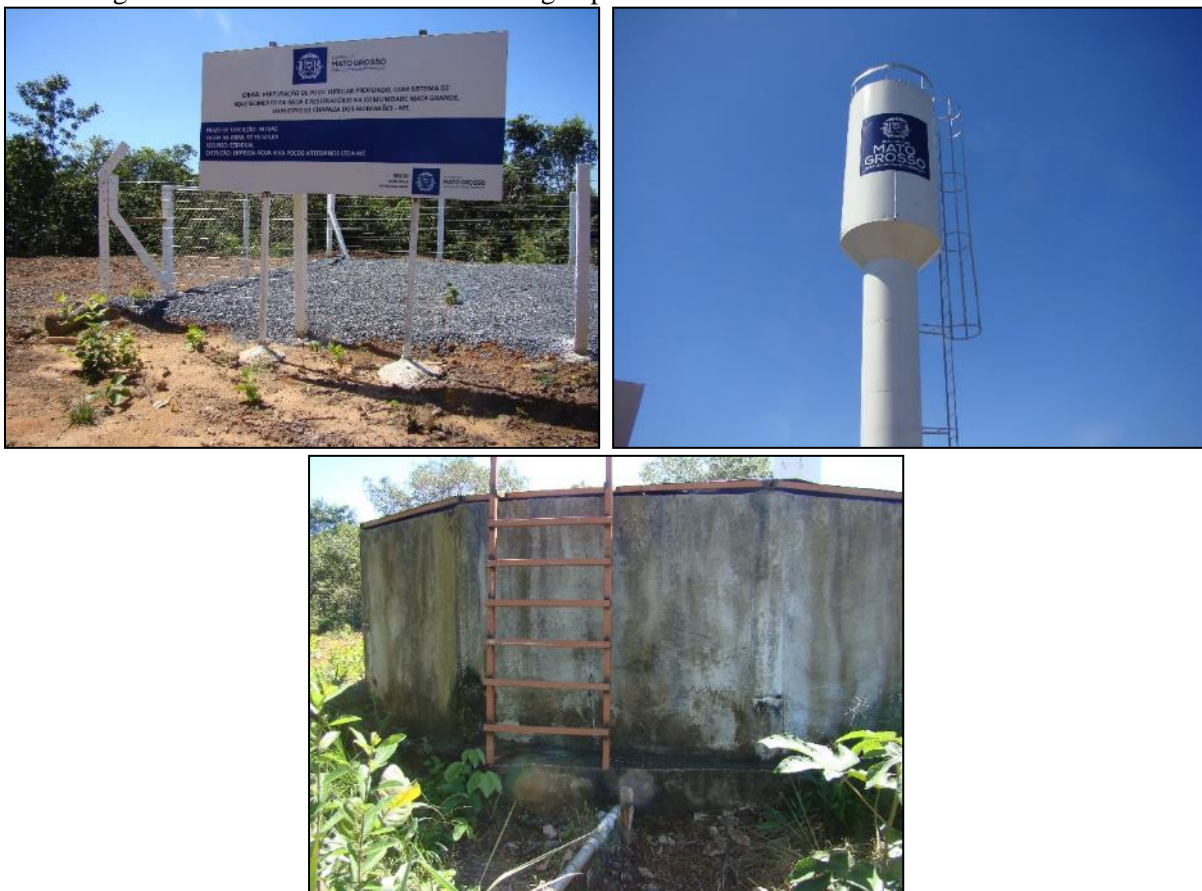
Figura 69. Obra de abastecimento de água paralisada e reservatório atualmente utilizado
