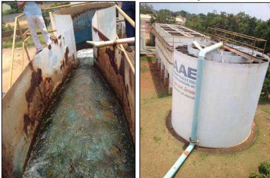
Figura 21. Calha Parshall e floculador da ETA de Chapada dos Guimarães
