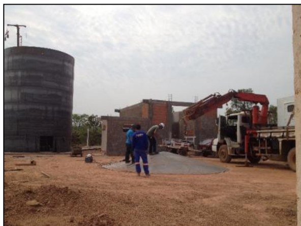
Figura 28. EEAB 2 da nova captação de água bruta e construção de nova ETA em Chapada dos Guimarães
