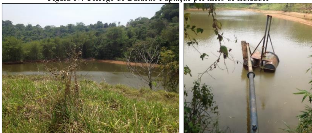
Figura 17. Córrego do Buracão e aptação por meio de flutuador
