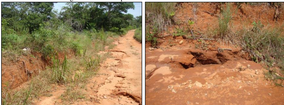
Figura 77. Vias não pavimentadas e com início de erosão
