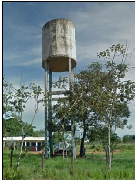
Figura 24. Reservatório elevado de concreto não utilizado pelo SAAE
