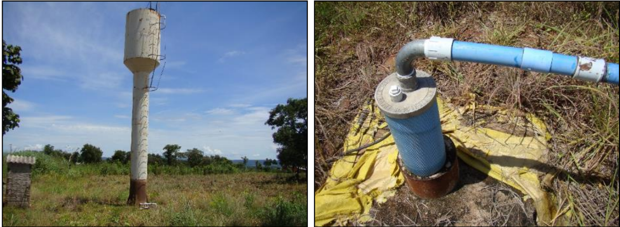
Figura 81. Reservatório e poço do sistema de abastecimento de água
