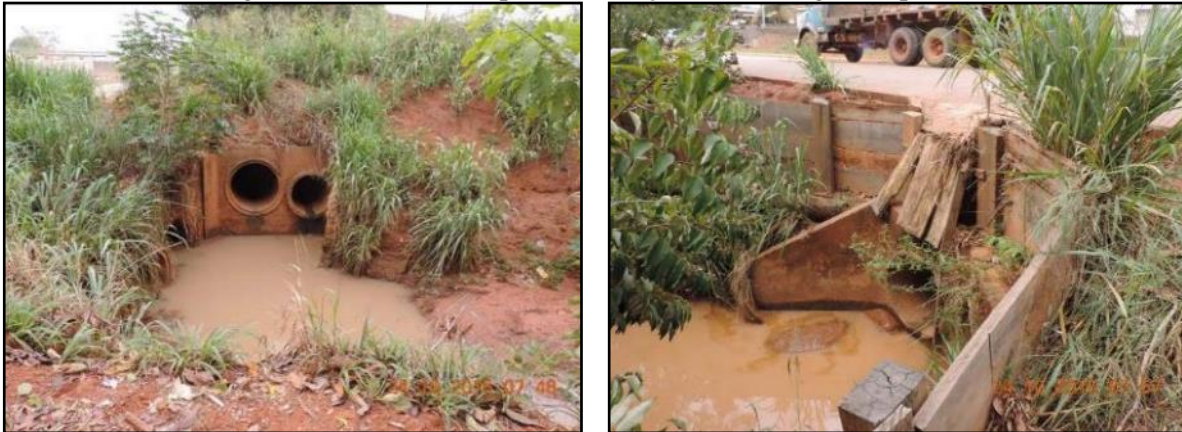
Figura 71. Falta de dissipador no lançamento das águas captadas
