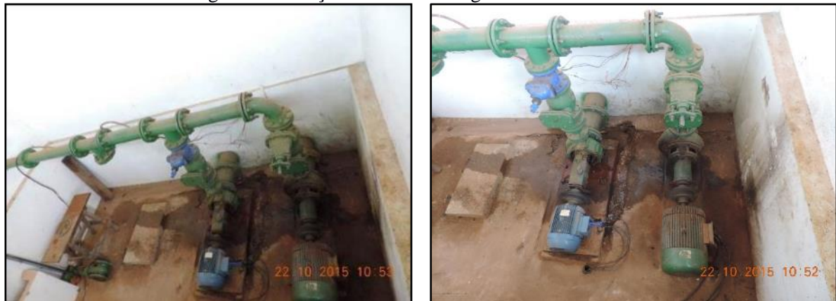
Figura 22. Estação elevatória de água tratada - EEAT01
