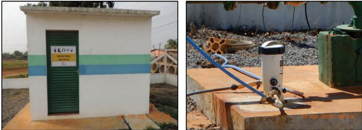
Figura 17. Depósito para armazenamento das pastilhas de cloro (A) e clorador de contato (B)
