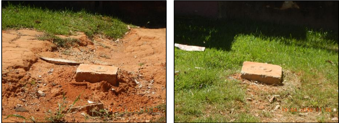
Figura 36. Ligações domiciliares de esgoto
