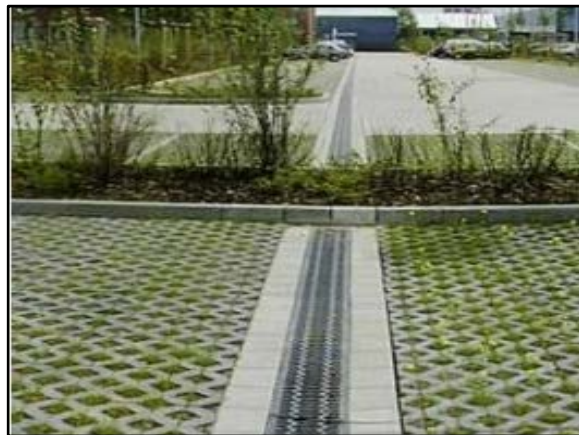
Figura 141. Trincheira de infiltração no estacionamento
