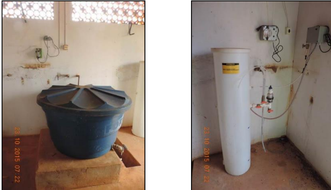
Figura 15. Tanque de cloração (A) e tanque de fluoretação (B) para a água captada no PT-04
