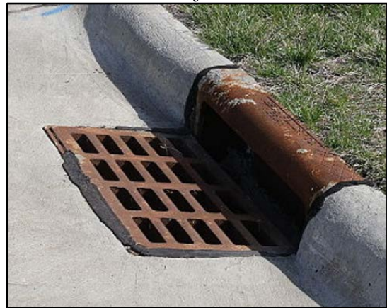
Figura 133. Boca de lobo com gradeamento na sarjeta
