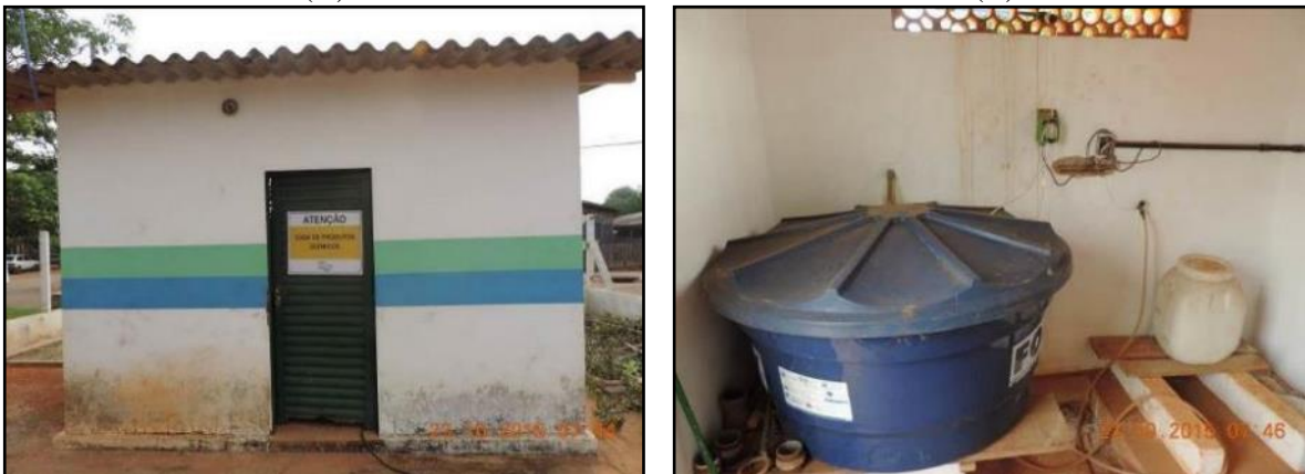
Figura 16. Casa de química (A) e tanque de cloração (B) para a água captada do PT-06
