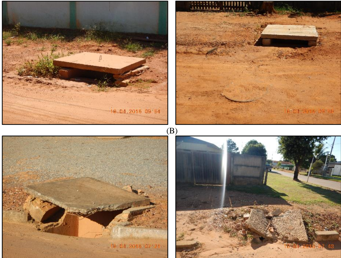
Figura 64. Bocas de lobo em vias não pavimentadas (A) e bocas de lobo danificadas (B)
