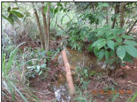
Figura 51. Tubulação aparente do emissário
