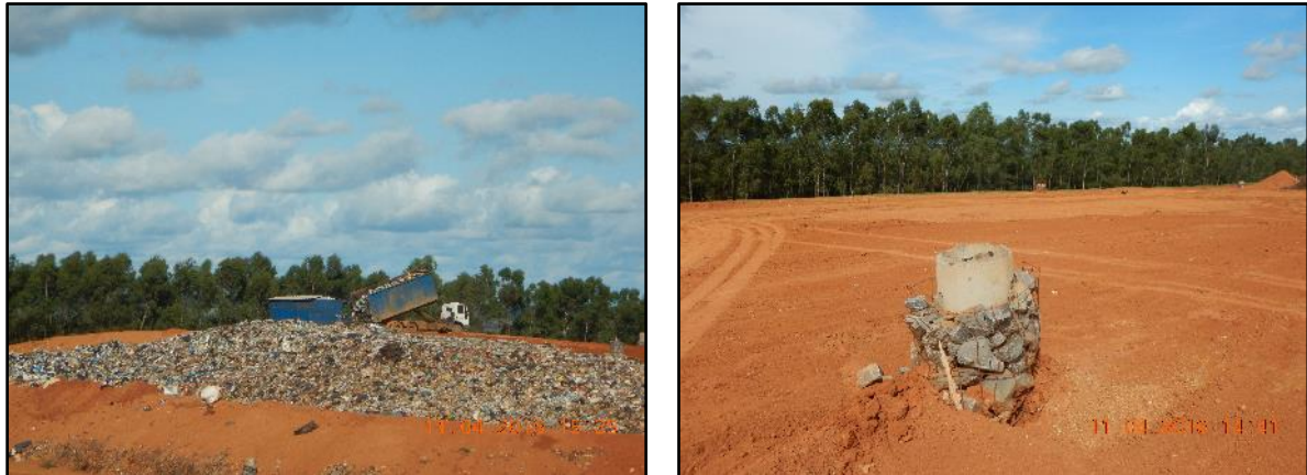
Figura 82. Maciço em uso com compactação dos resíduos (A) e queimador dos gases produzidos (B)
