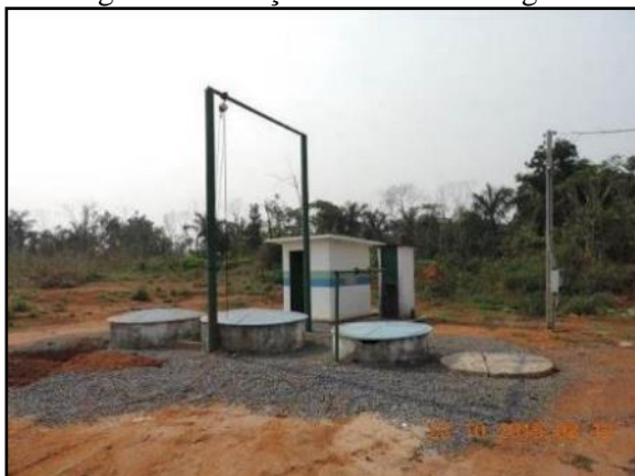
Figura 37. Estação elevatória de esgoto
