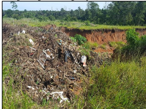
Figura 47. Resíduos sólidos acumulados no deságue da galeria de águas pluviais (Erosão – 5)
