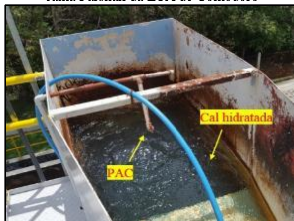
Figura 18. Aplicação do PAC e cal hidratada na calha Parshall da ETA de Comodoro
