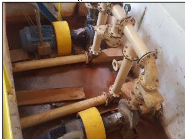
Figura 10. Conjuntos motobomba de captação no córrego Cascalheira
