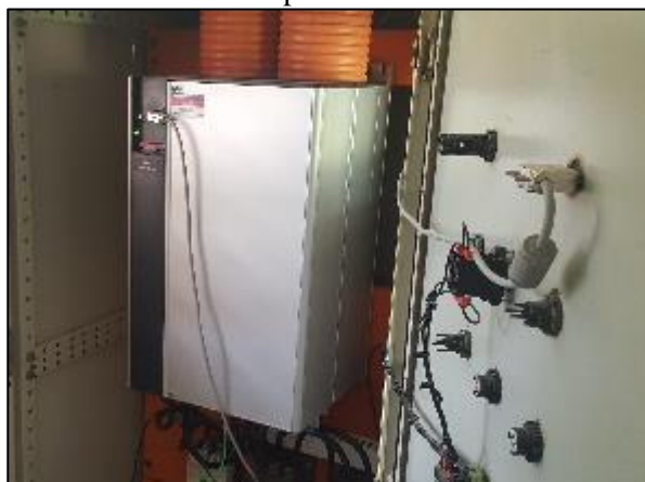
Figura 15. Inversor de frequência VLT Aqua Drive no quadro de comando da captação superficial
