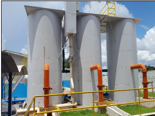
Figura 19. Filtros de fluxo descentes com múltiplas camadas
