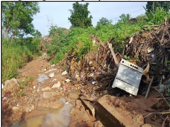
Figura 46. Resíduos sólidos acumulados no deságue da galeria de águas pluviais (Erosão – 1)
