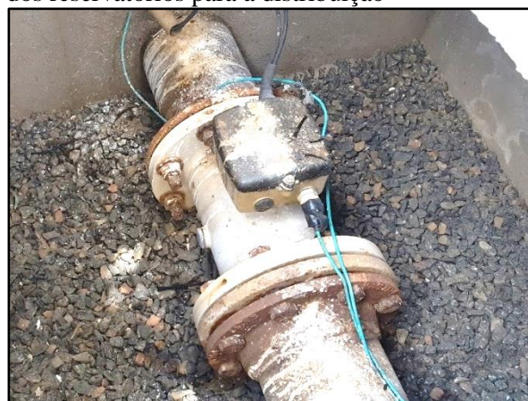
Figura 26. Macromedidor na tubulação na saída dos reservatórios para a distribuição
