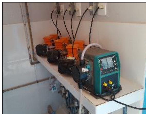
Figura 16. Inversor de frequência das bombas dosadoras de produtos químicos na ETA
