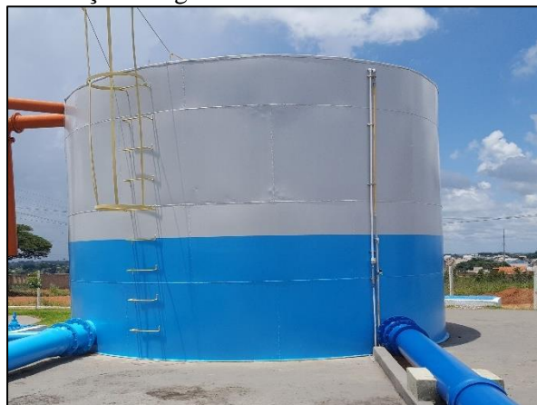
Figura 23. Câmara de contato para desinfecção e fluoretação da água tratada da ETA de Comodoro
