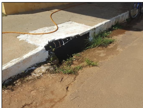
Figura 43. Boca de lobo com tampa danificada na Av. Pref. Valdir Masutti no Centro
