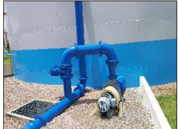
Figura 20. Conjunto motobomba interligado ao reservatório de água tratada para lavagem dos filtros
