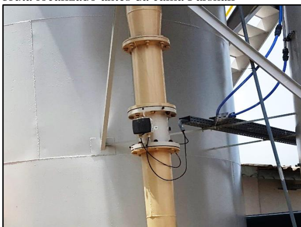
Figura 25. Macromedidor na tubulação de água bruta localizado antes da calha Parshall
