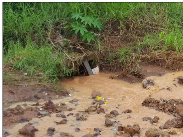
Figura 45. Boca de lobo coberta com mato e sem sarjetas para direcionamento das águas pluviais na Rua Minas Gerais no bairro São Francisco
