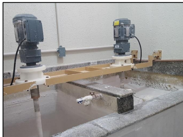
Figura 24. Tanque de preparação da solução de cal hidratada na sala de química na ETA de Comodoro
