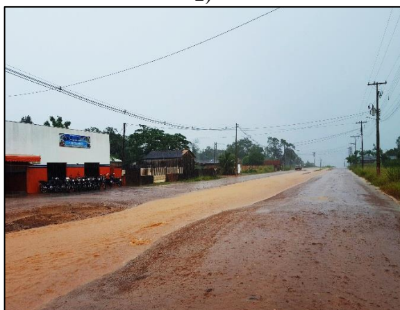
Figura 51. Alagamento da Av. Pref. Valdir Masutti no bairro Nova Vacaria (Via alagada – 2)
