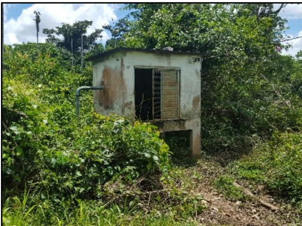
Figura 87. Abrigo da bomba de captação direta
