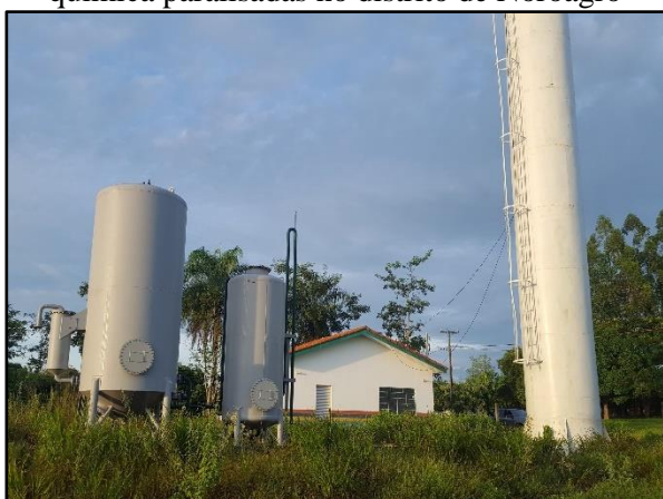
Figura 85. Obras da ETA, reservatório e casa de química paralisadas no distrito de Noroagro
