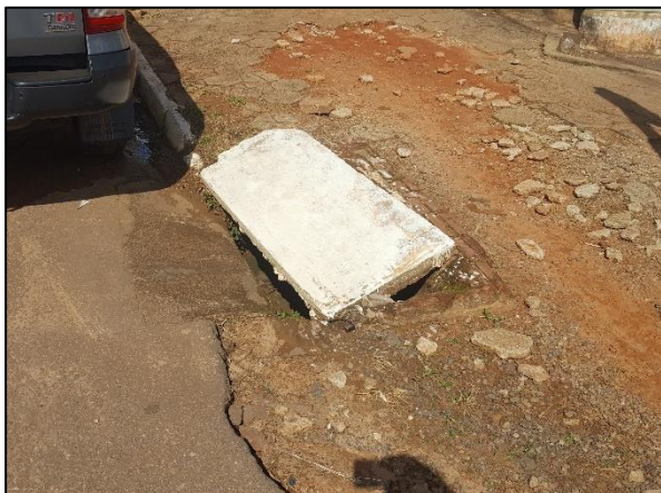
Figura 44. Boca de lobo assoreada e sarjeta danificada na Av. Pref. Valdir Masutti no Centro
