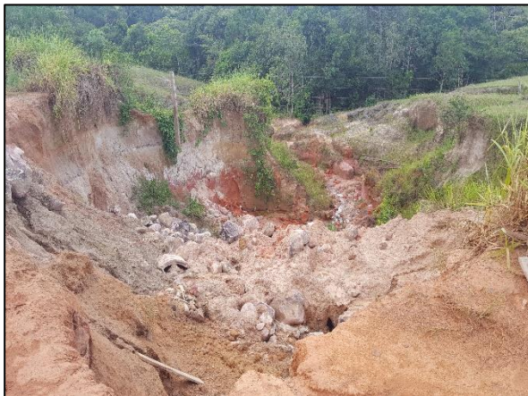
Figura 98. Erosão na estrada de acesso ao distrito de Nova Alvorada
