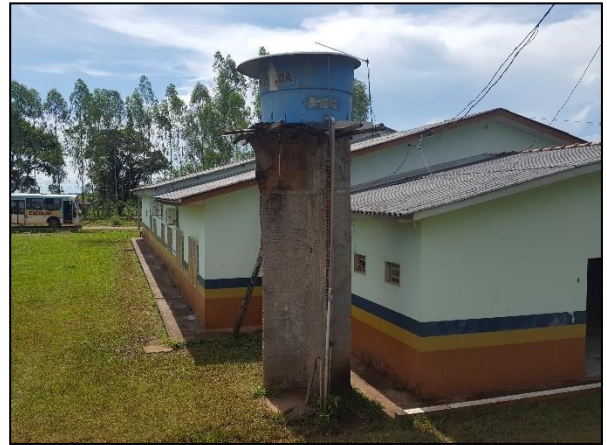
Figura 94. Reservatório elevado de PRFV na escola em Colônia dos Mineiros
