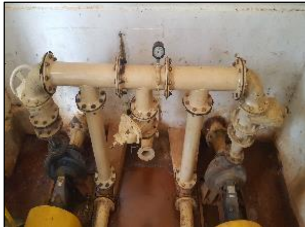
Figura 14. Barrilete da captação em ferro fundido DN 150 mm
