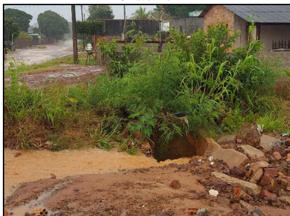
Figura 42. Boca de lobo sem tampa em via não pavimentada na Rua Minas Gerais no bairro Cristo Rei
