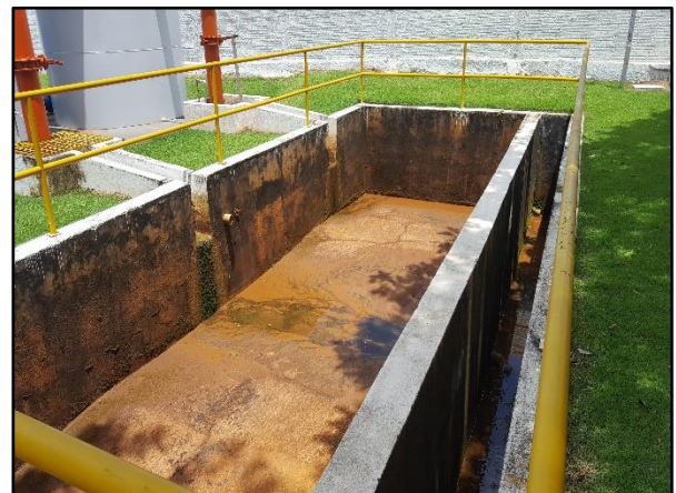
Figura 22. Tanque de secagem do lodo dos filtros
