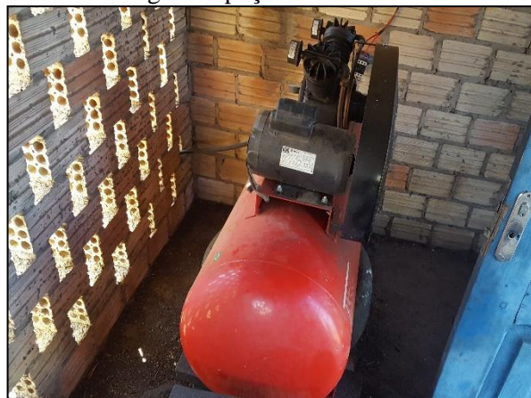
Figura 92. Compressor utilizado para recalque da água do poço de Padronal
