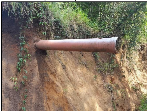
Figura 34. Emissário de esgoto danificado devido à evolução de um processo erosivo
