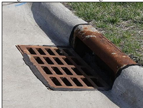
Figura 127. Boca de lobo com gradeamento
