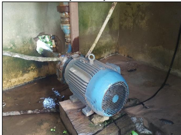
Figura 88. Conjunto motobomba de eixo horizontal com capacidade para recalcar 20 m 3 /h
