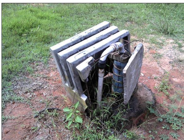
Figura 60. Cavalete do poço tubular na escola rural do Ena
