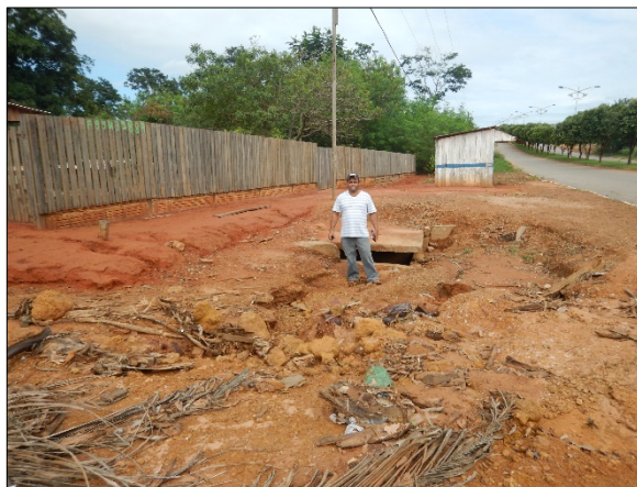
Figura 29. Boca-de-lobo locada fora da área pavimentada da Avenida Perimetral Norte.
