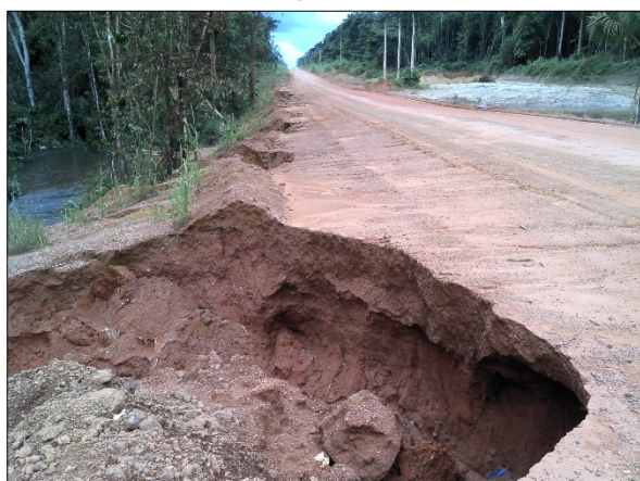
Figura 63. Erosão próxima ao rio Água do Quinze
