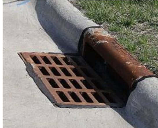
Figura 77. Boca de lobo com gradeamento
