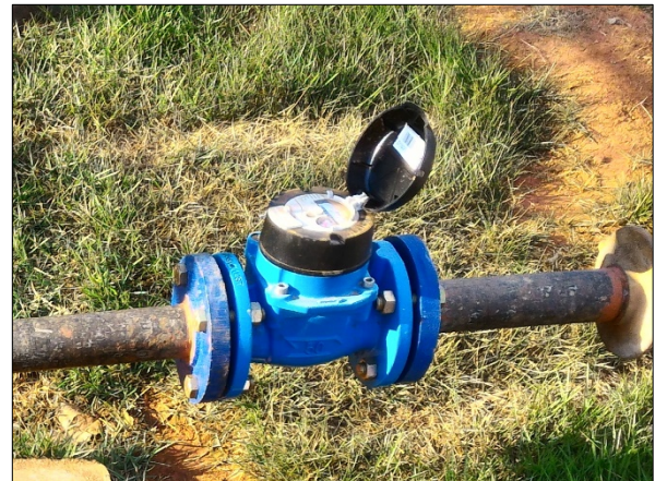
Figura 13. Macromedidor do PT-03A
