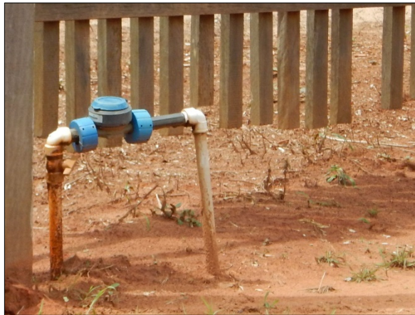
Figura 23. Hidrômetro instalado na ligação predial em Feliz Natal
