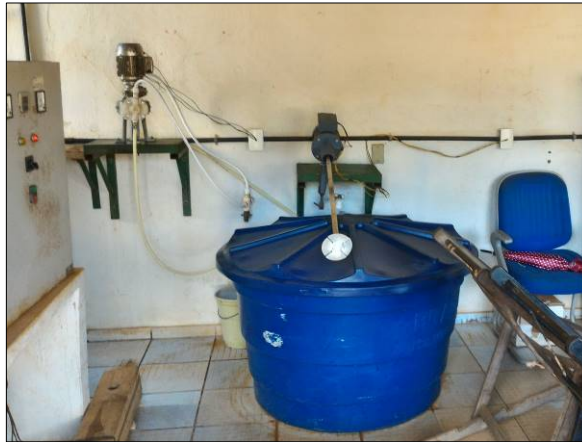
Figura 21. Tanque de diluição do cloro e bomba dosadora
