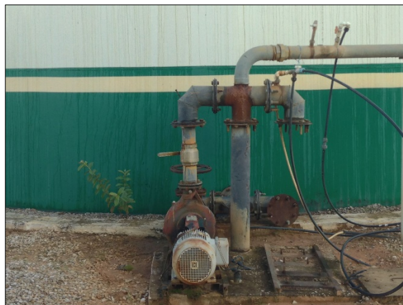
Figura 22. Bomba pressurizadora na saída do reservatório 01
