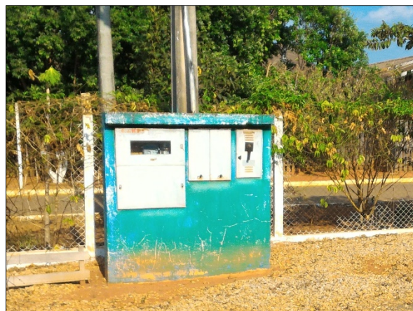
Figura 11. Quadro de comando do PT-01, na sede do SAE.
