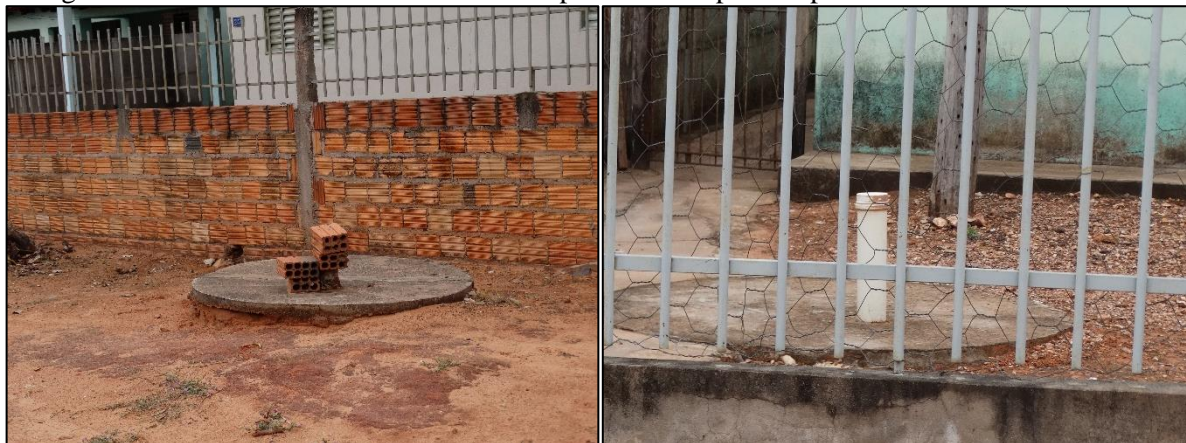
Figura 22. Sistema de tratamento individual por fossa em passeio público e dentro da residência
