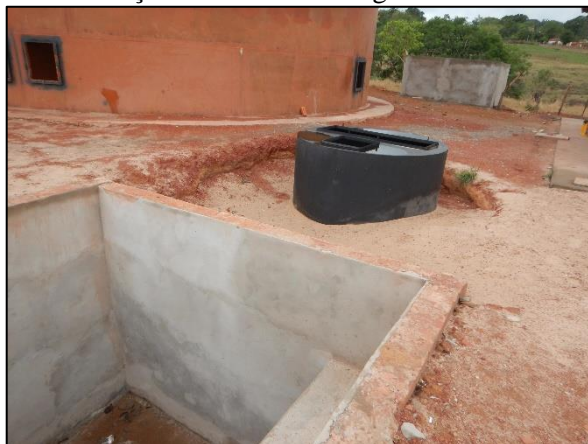
Figura 17. Estação Elevatória de Esgoto na entrada da ETE
