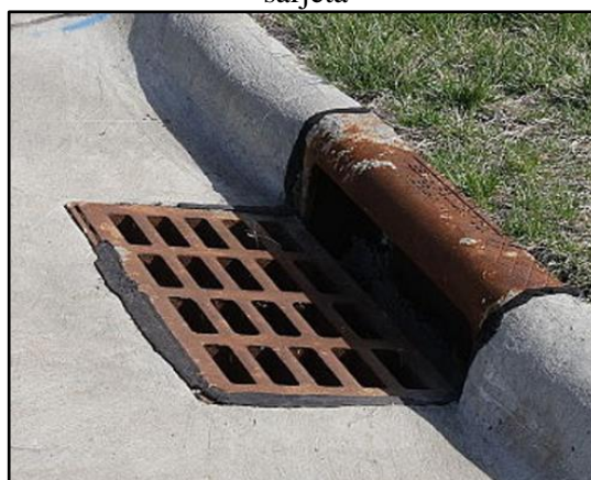
Figura 76. Boca de lobo com gradeamento na sarjeta
