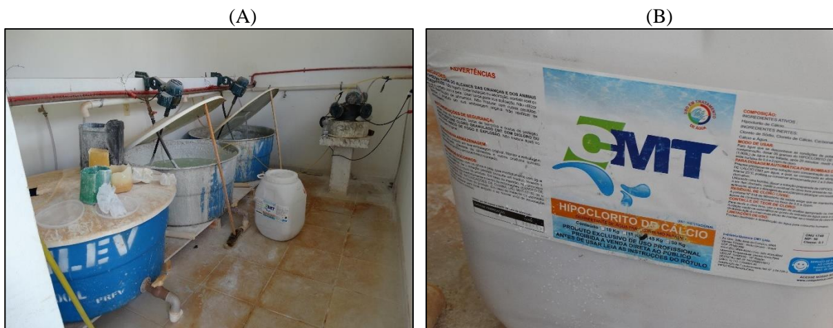
Figura 12. (A) Caixa d'água onde é preparada a solução de cloro, (B) Produto químico utilizado na desinfecção da água bruta, (C) Casa de química, (D) Casa de Química e condições do ambiente, (E) Bomba dosadora através de timer
