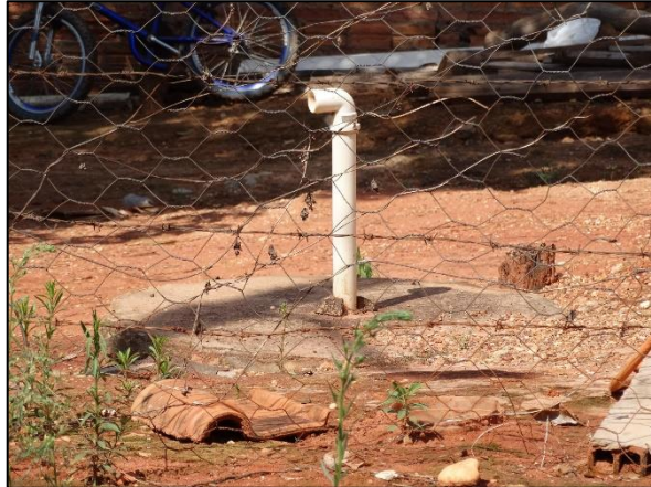
Figura 43. Fossa negra para disposição dos esgotos domésticos
