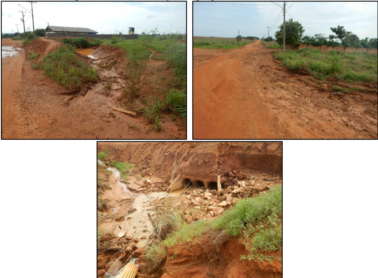
Figura 24. Bacia de contenção de água pluvial com erosão em vias
