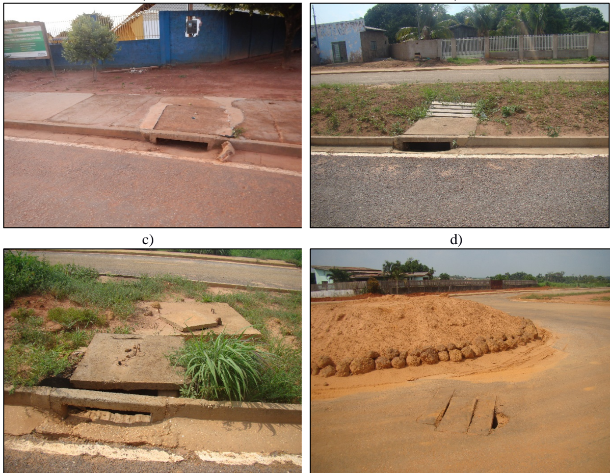
Figura 22. Dispositivos de microdrenagem: a) e b) Bocas de lobo em vias pavimentadas c) Boca de lobo danificada d) Poço de visita sem tampão com adaptação
