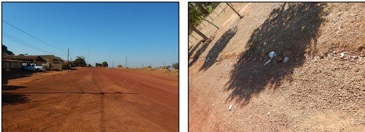
Figura 61. Via não pavimentada (a) e processo erosivos (b), Simione, Itanhanga-MT
