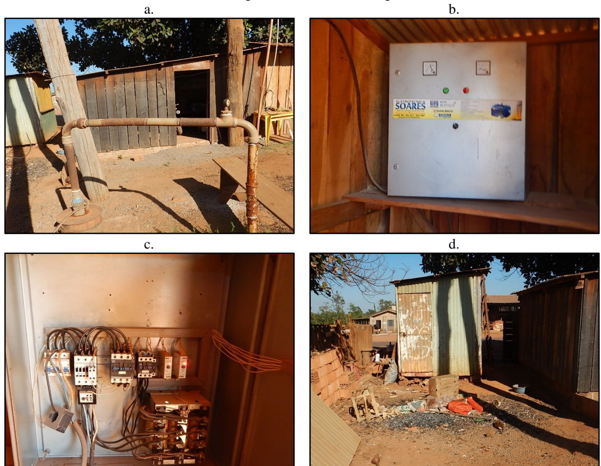
Figura 56. Vista da boca do poço tubular e cavalete (a), quadro de comando (b e c), precariedades do interior do abrigo (d), Simione, Itanhangá-MT
