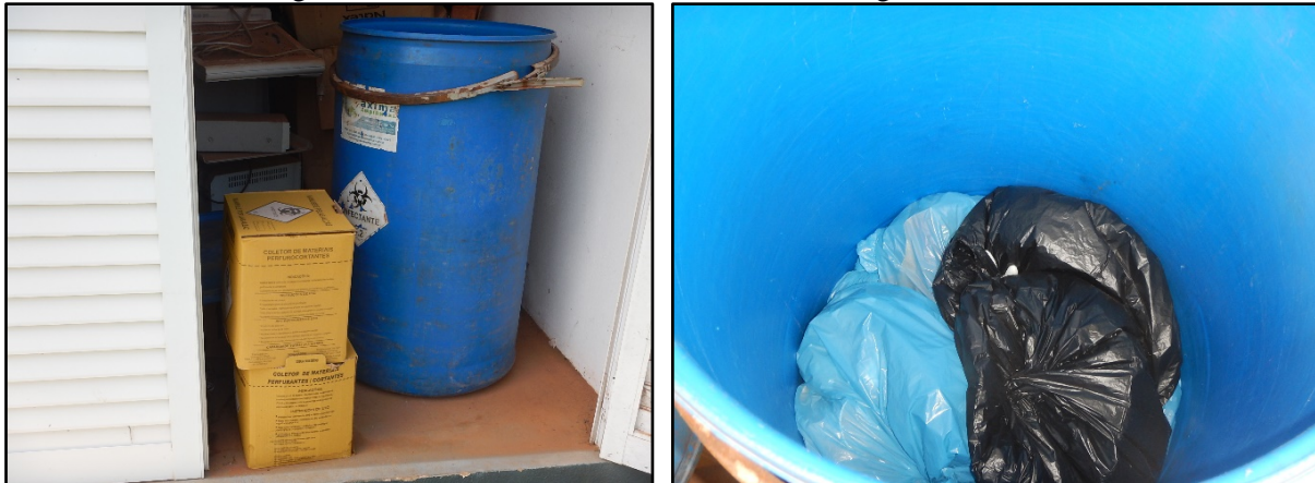
Figura 35. Acondicionamento dos RSS nos abrigos das USF's
