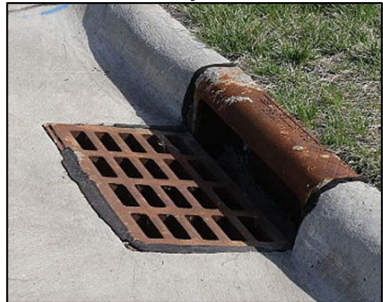
Figura 85. Boca de lobo com gradeamento na sarjeta
