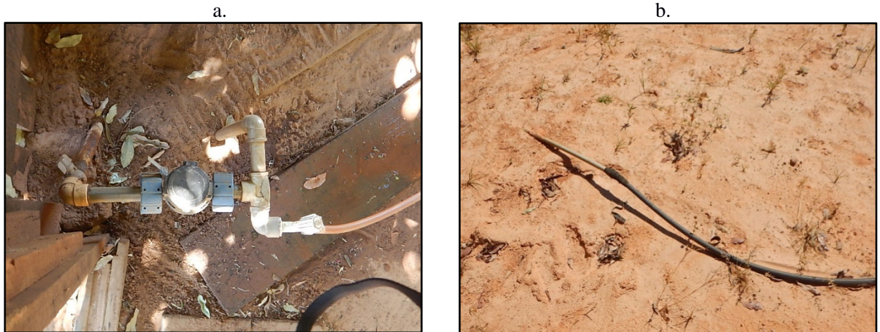
Figura 48. Cavalete com hidrômetro (a) e ligação da rede em mangueira para distribuição de água, Monte Alto, Itanhangá-MT
