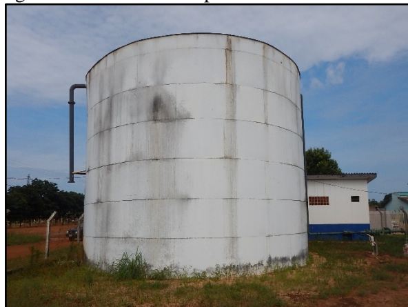
Figura 15. Reservatório apoiado metálico de 500 m 3
