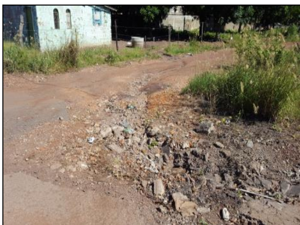
Figura 62. Ponto de empoçamento de águas pluviais na margem da BR-163 (Erosão 1)
