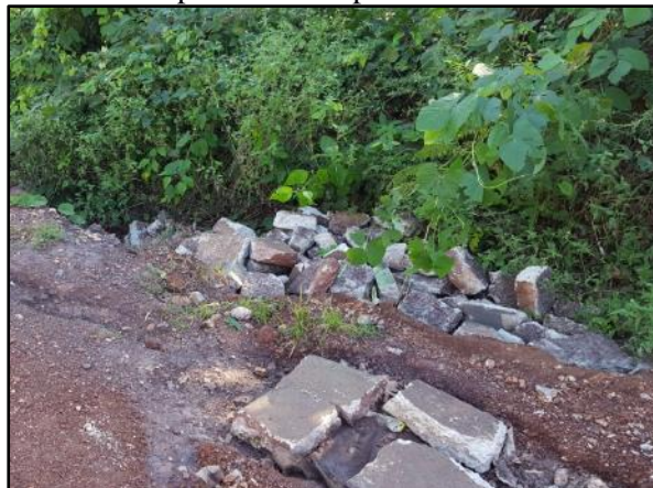
Figura 100. Erosão na margem da Rua 03 no trecho não pavimentado preenchido com RCD
