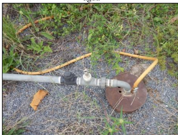
Figura 119. Mangueira de jardim ligada no compressor e conectada no poço para captação de água
