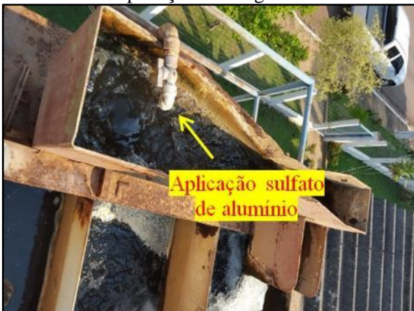
Figura 24. Entrada da água bruta na calha Parshall e aplicação do coagulante
