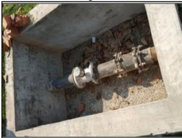
Figura 18. Macromedidor na adutora de água bruta na chegada da ETA
