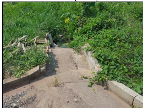
Figura 73. Saída rápida no meio-fio sem dissipador de energia no Altos das Jangada para escoamento das águas superficiais
