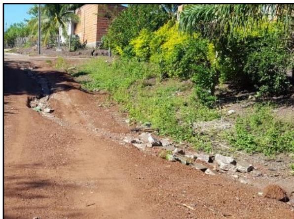
Figura 64. Erosão no leito da Rua 03 preenchida com resíduos da construção e demolição
