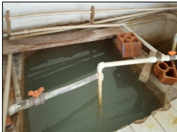
Figura 25. Tanque de preparo das soluções de sulfato de alumínio
