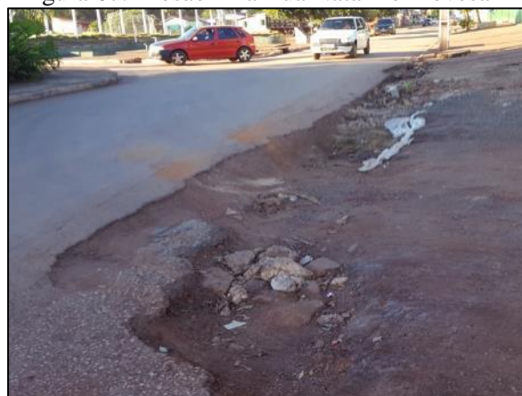
Figura 67. Erosão 4 na Rua Natalino Piovesan
