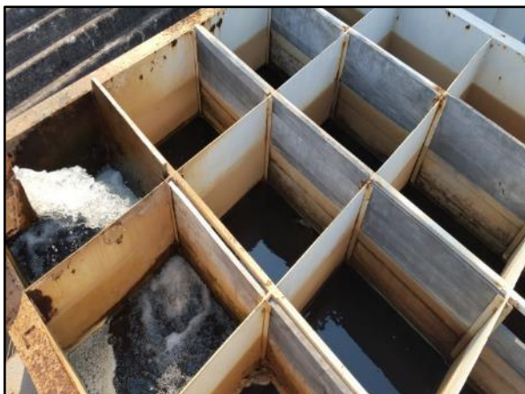
Figura 26. Floculadores hidráulicos de fluxo vertical
