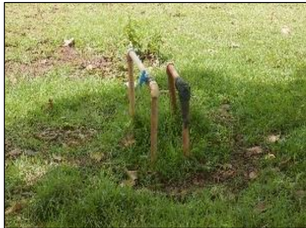
Figura 125. Cavalete sem hidrômetro na comunidade Novo Mato Grosso
