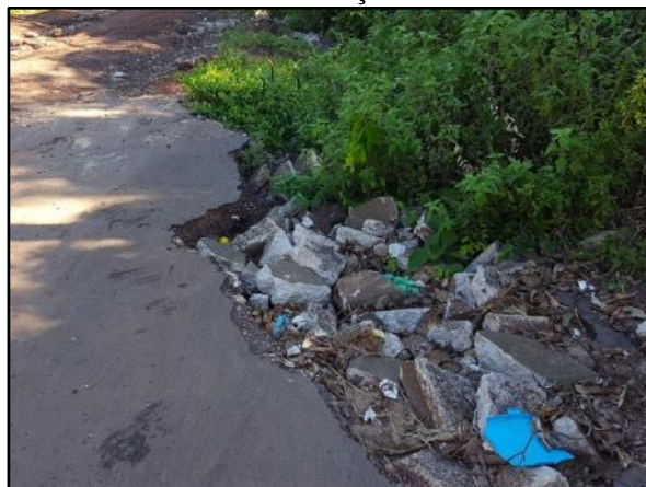
Figura 65. Erosão na margem da Rua 03 preenchida com resíduos da construção e demolição
