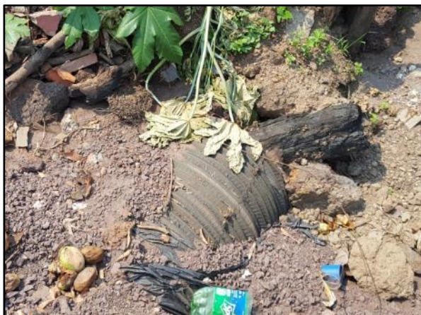
Figura 72. Deságue da galeria de águas pluviais assoreada e sem dissipadores de energia na Rua Natalino Piovesan
