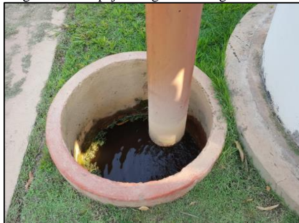
Figura 30. Despejo da água de lavagem do filtro
