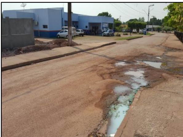
Figura 49. Lançamento de efluente na sarjeta da rua em frente ao Pronto Atendimento
