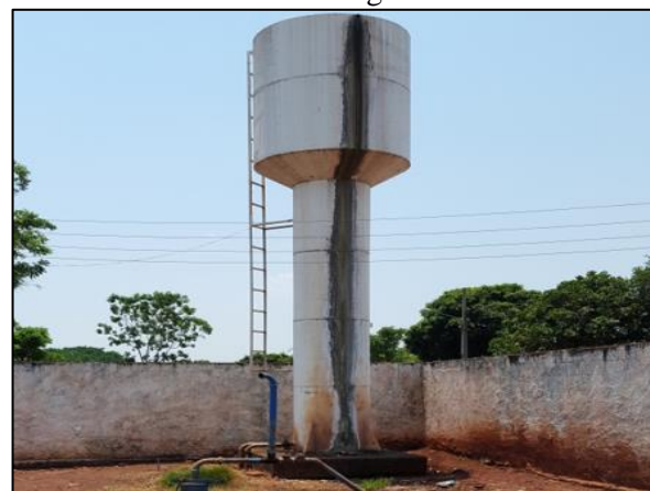
Figura 123. Reservatório (R-01) de 10,0 m 3 de Nova Jangada
