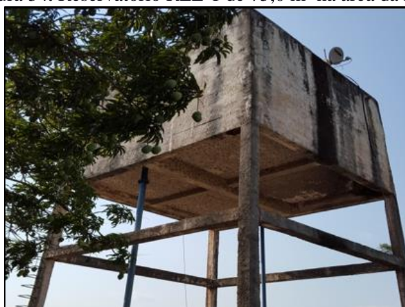
Figura 34. Reservatório REL-1 de 75,0 m 3 na área da ETA
