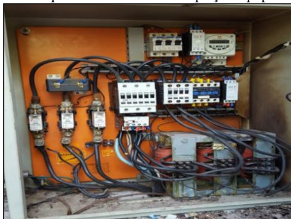
Figura 20. Detalhe do quadro de comando da captação equipado com horímetro
