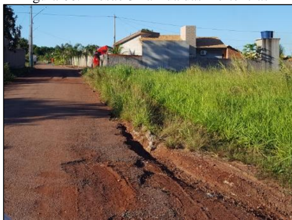
Figura 66. Erosão 3 na Rua das Hortências
