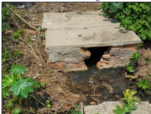
Figura 52. Extravasamento do esgoto na ETE no bairro Altos da Jangada
