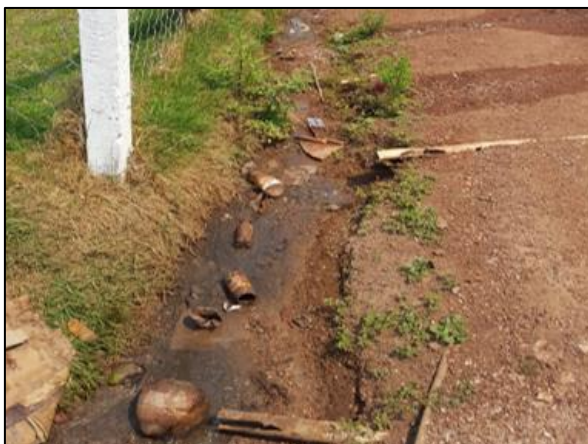
Figura 51. Valeta umidificada com esgotos domésticos
