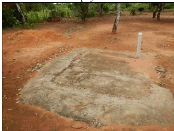
Figura 127. Fossa rudimentar na comunidade Vaquejador
