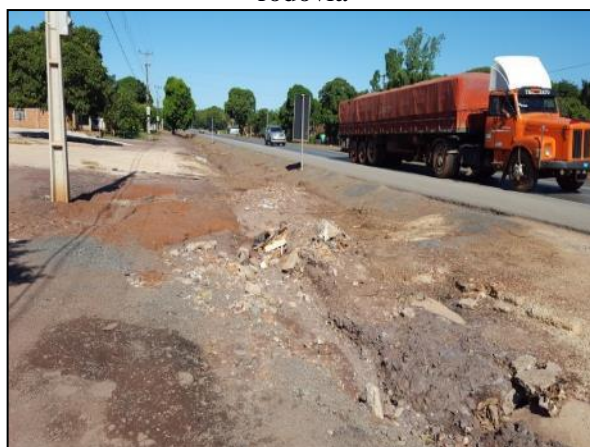
Figura 63. Erosão 1 na margem da BR-163 e ausência de dispositivos de microdrenagem na rodovia
