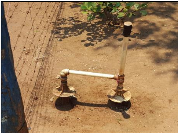
Figura 124. Cavalete sem hidrômetro na comunidade Nova Jangada
