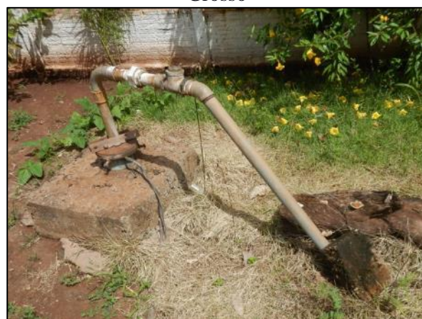
Figura 117. Poço na comunidade de Novo Mato Grosso
