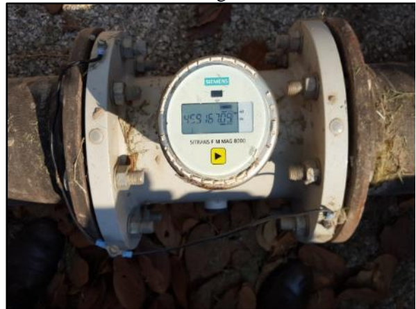
Figura 19. Macromedidor em operação na adutora de água bruta
