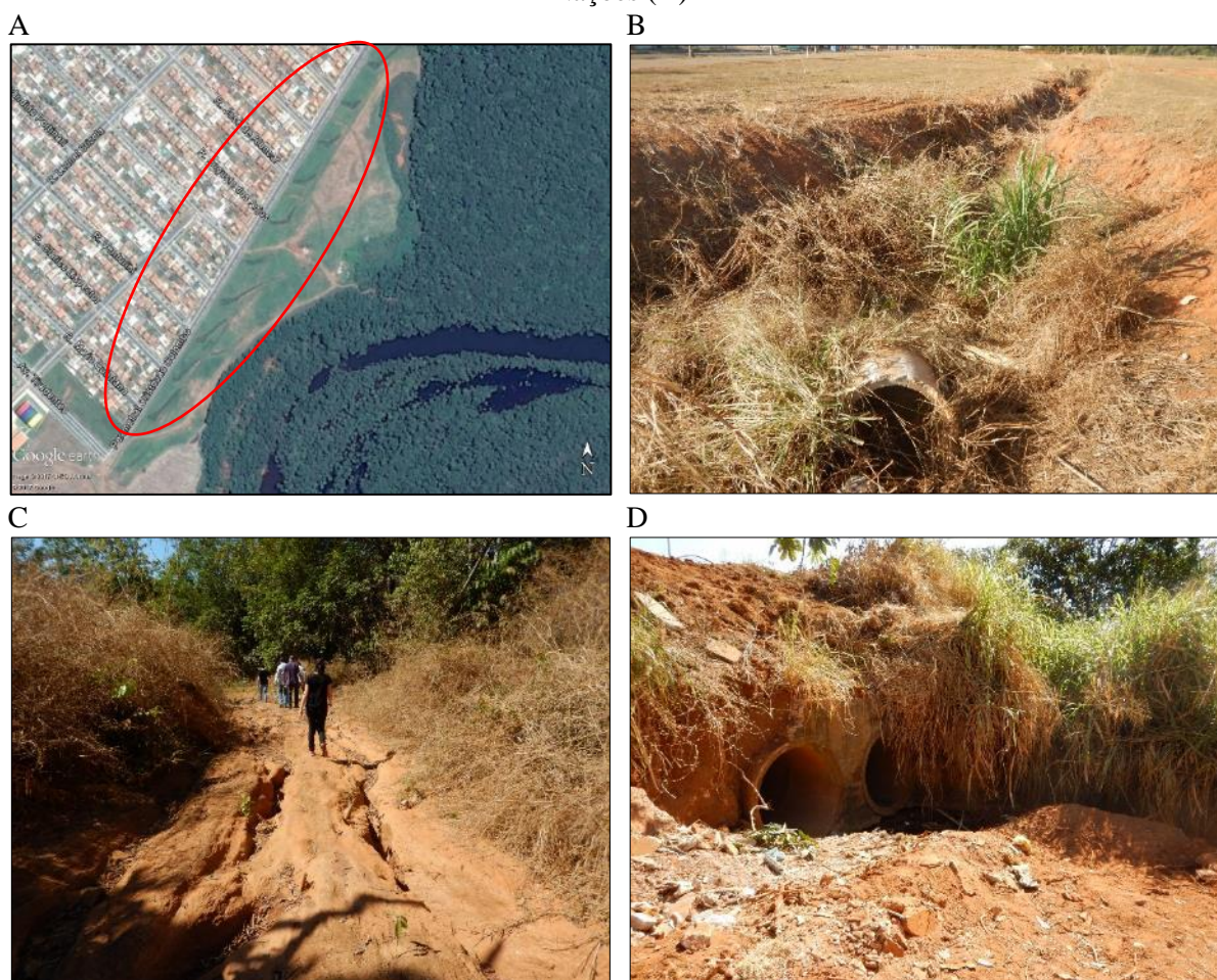
Figura 46. Processos erosivos na área urbana do município, no bairro Parque das Américas (A, B) e próximo ao novo loteamento habitacional no bairro Vida Nova I (C) e outra próxima da Avenida das Nações (D)
