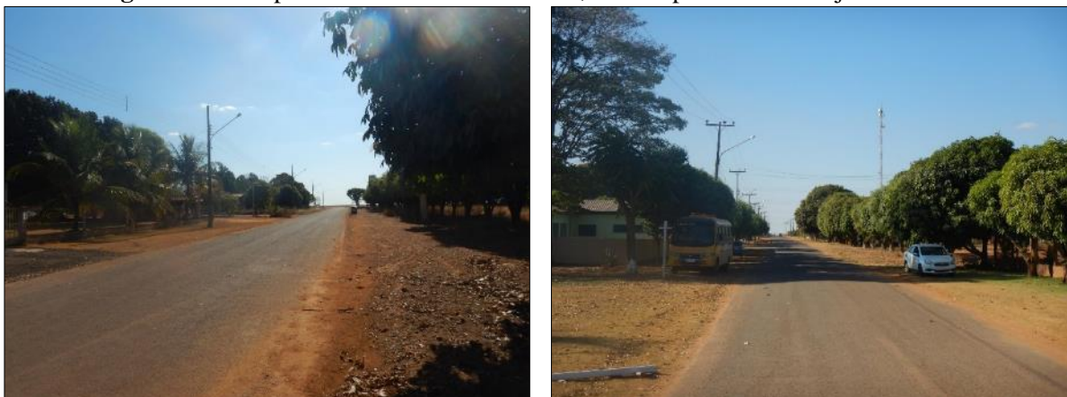
Figura 76. Vias pavimentadas em Groslândia, sem dispositivos de sarjeta e meio-fio
