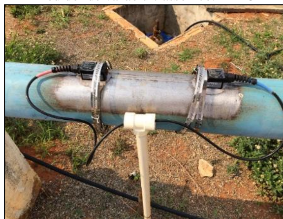
Medidor de vazão ultrassônico: PT-13
