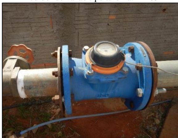
Figura 13. Tipos de medidores de vazão instalados nos poços do SAA de Lucas do Rio verde Medidor de vazão tipo turbina: PT-05
