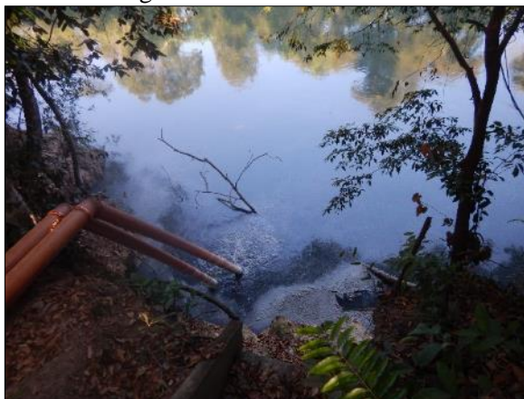
Figura 34. Ponto de deságue do efluente tratado das ETEs UASB e MBBR
