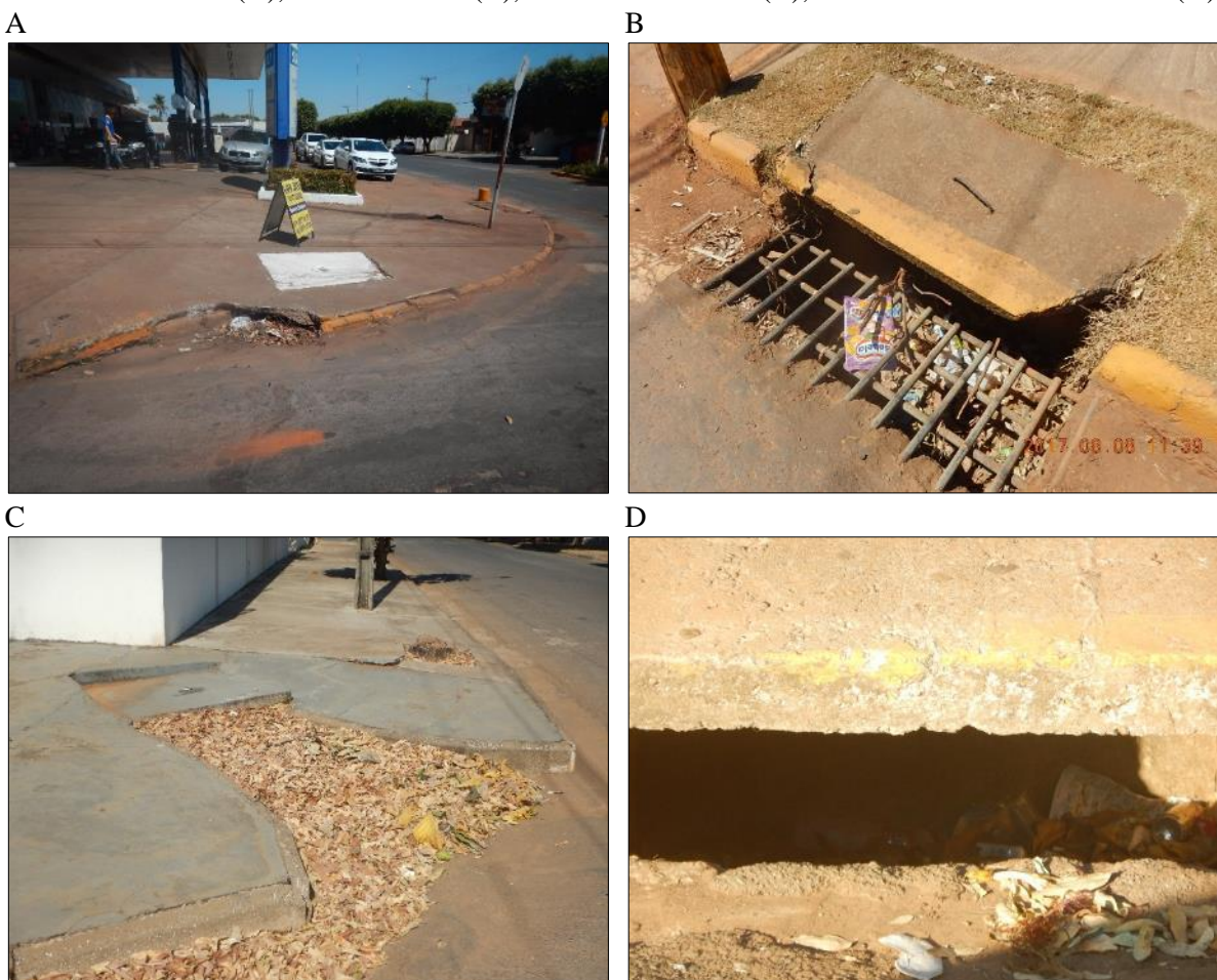
Figura 45. Bocas de lobo obstruídas ou parcialmente obstruída com resíduos sólidos ou folhagem na Av. Mato Grosso (A), Av. São Paulo (B), Av. Rio de Janeiro (C), e no bairro Jardim Primavera (D)
