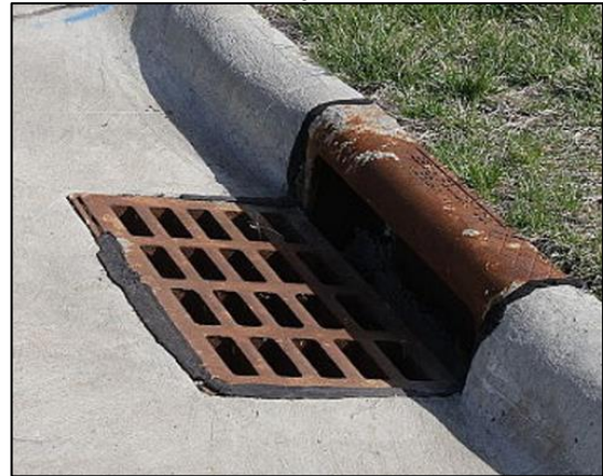
Figura 111. Boca de lobo com gradeamento na sarjeta
