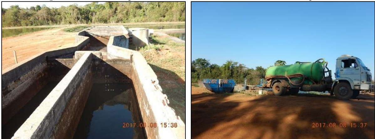
Figura 31. Tratamento preliminar recebendo efluentes de caminhões limpa-fossa
