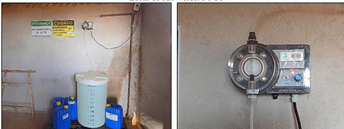
Figura 17. Sistema de desinfecção e bomba dosadora eletromagnética utilizada nos poços do SAA de Lucas do Rio Verde: PT-30
