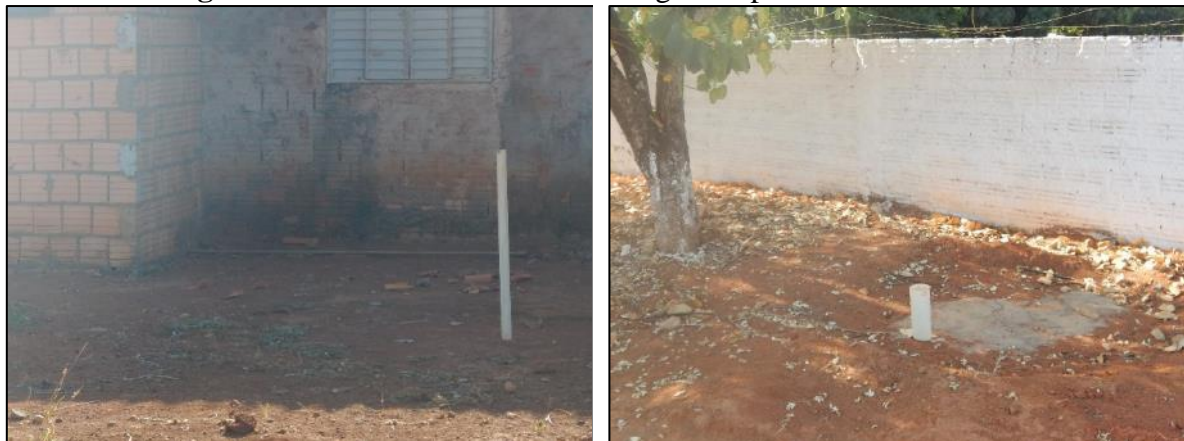
Figura 75. Vista exterior de fossas negras implantadas no distrito
