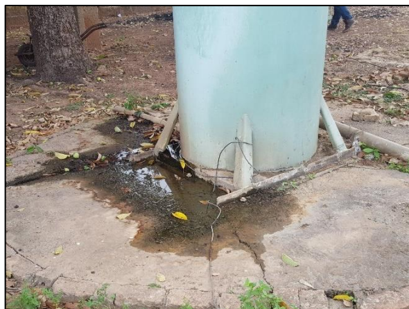
Figura 60. Vazamento na base do reservatório da comunidade de São Bento
