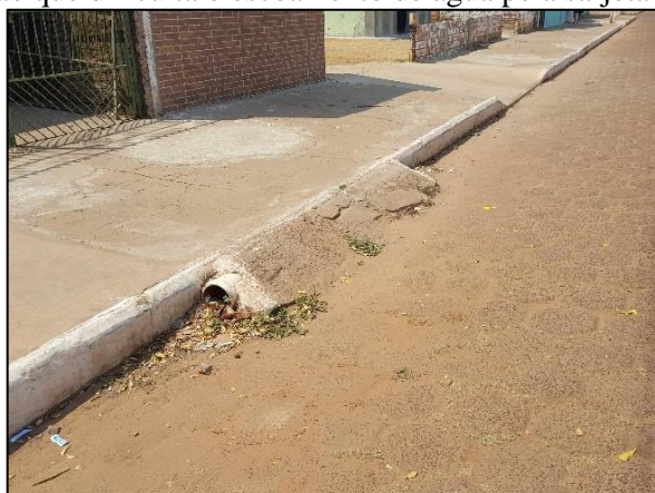
Figura 30. Adaptação que dificulta o escoamento de água pela sarjeta na cidade de Luciara
