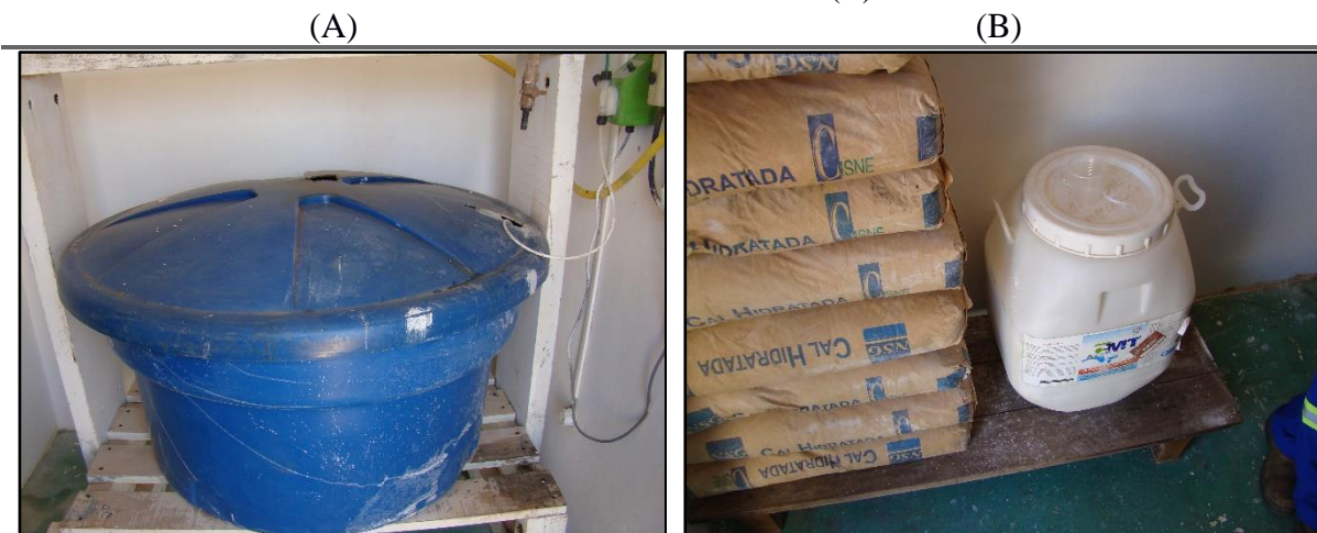
Figura 40. Tanque de mistura do cloro (A) Armazenamento dos produtos químicos (B) e Macro medidor instalado no PT-01 (C)
