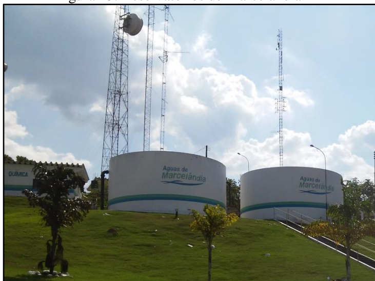
Figura 15. Reservatórios de Marcelândia-MT
