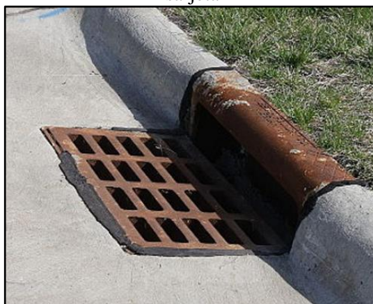
Figura 75. Boca de lobo com gradeamento na sarjeta
