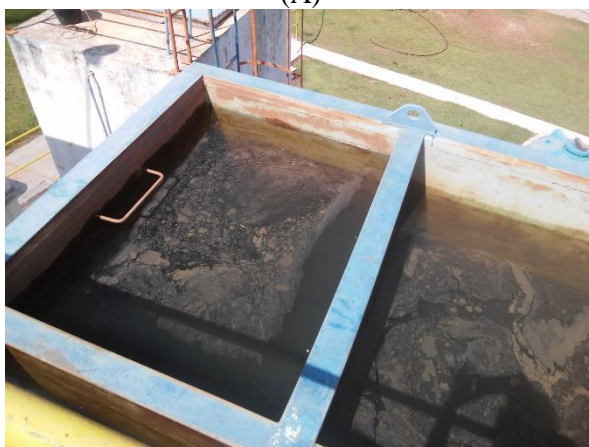
Figura 12. (A) Visão geral dos filtros (A)
