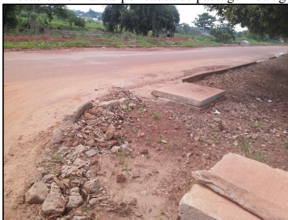
Figura 24. Erosão se formando por causa de passagem da água da chuva
