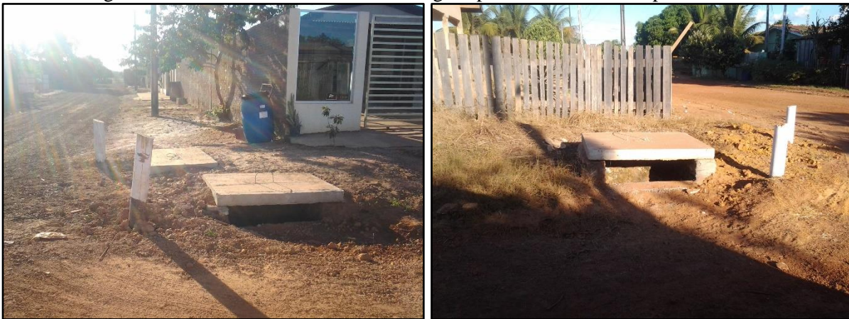
Figura 21. Problemas de escoamento de águas pluviais em vias não pavimentadas
