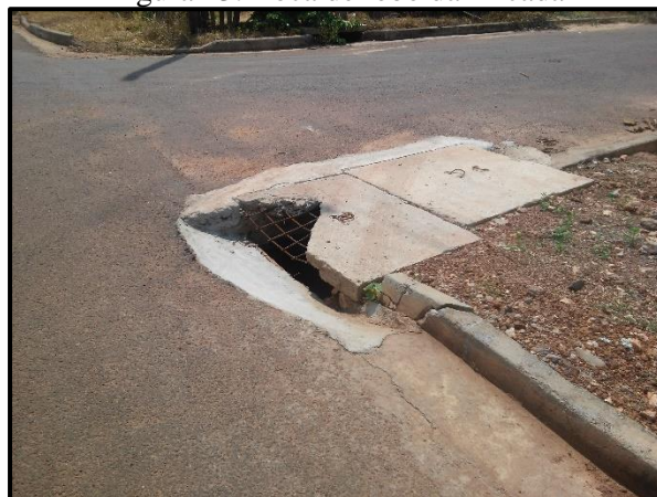
Figura 23. Boca de lobo danificada
