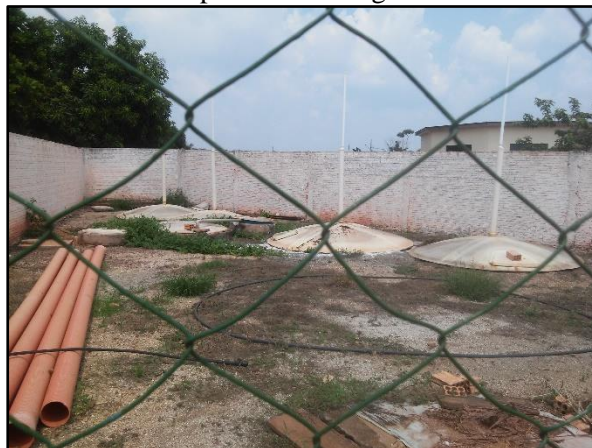
Figura 20. Tratamento simplificado de esgoto do bairro Jardim Paraíso
