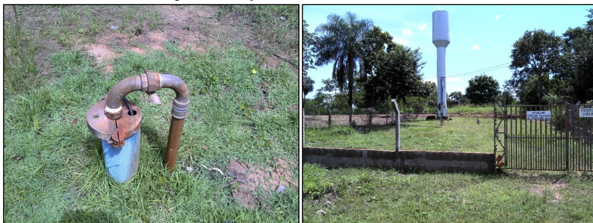
Figura 121. Poço tubular e reservatório elevado
