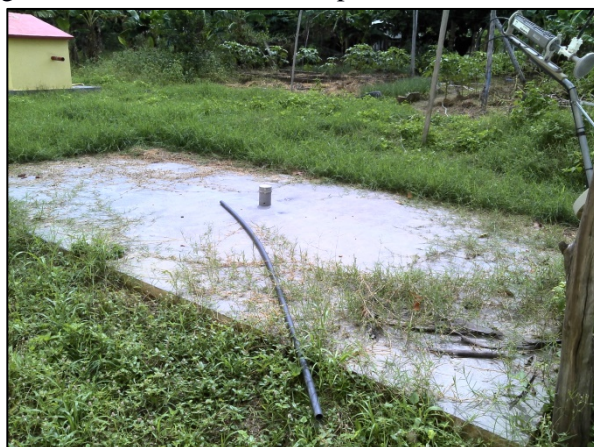
Figura 85. Detalhe da Fossa séptica instalada no distrito
