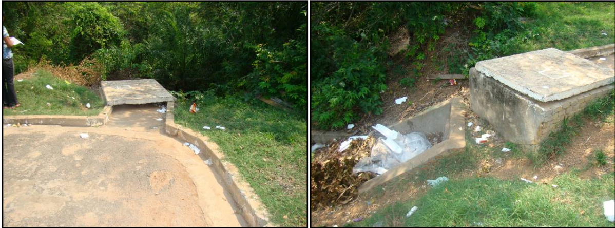
Figura 35. Entrada Dissipador Ribeirão, vista frontal e retaguarda
