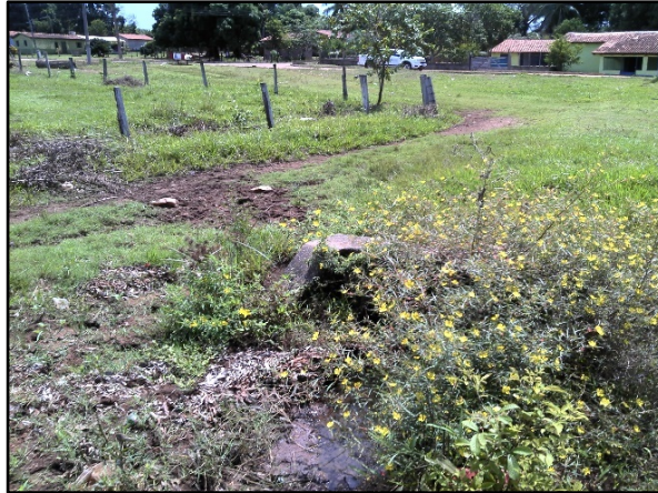
Figura 62. Área de Lançamento e galeria entupida
