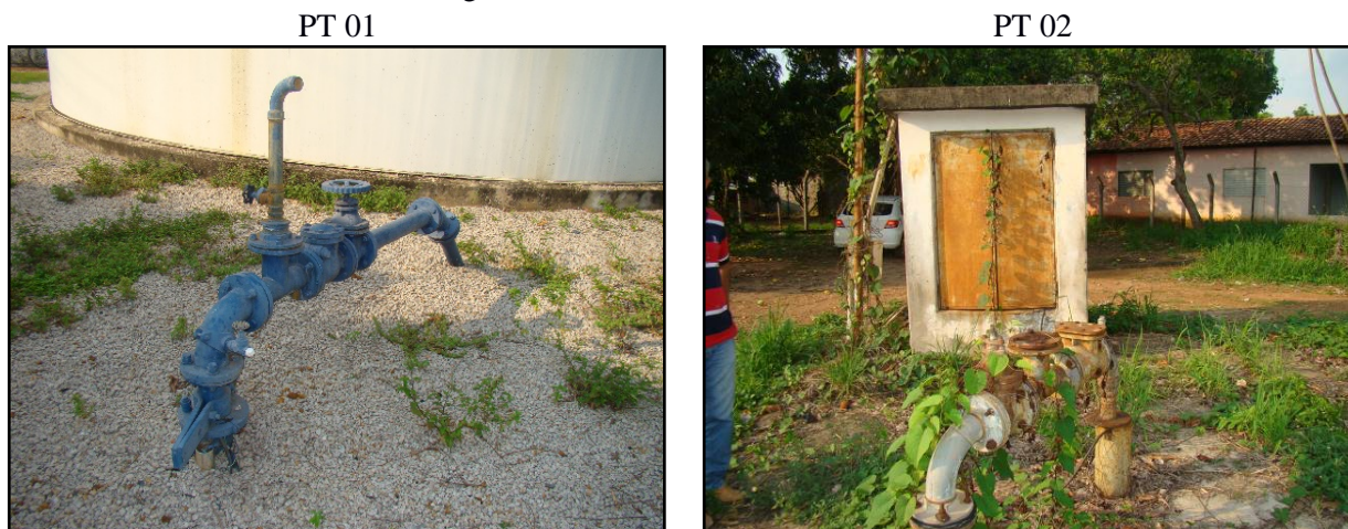
Figura 11. Estrutura dos PT 01 e PT 02
