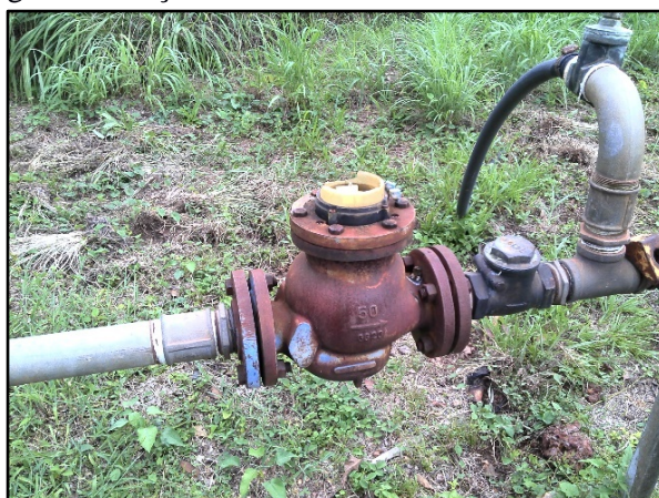
Figura 75. Poço Tubular com macromedidor da Escola
