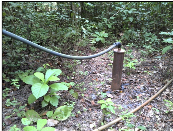
Figura 60. Poço tubular profundo em Volta do Bananal
