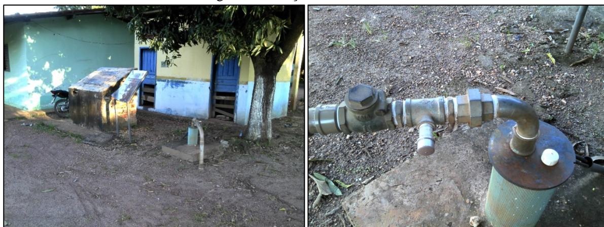
Figura 107. Poço tubular e detalhe
