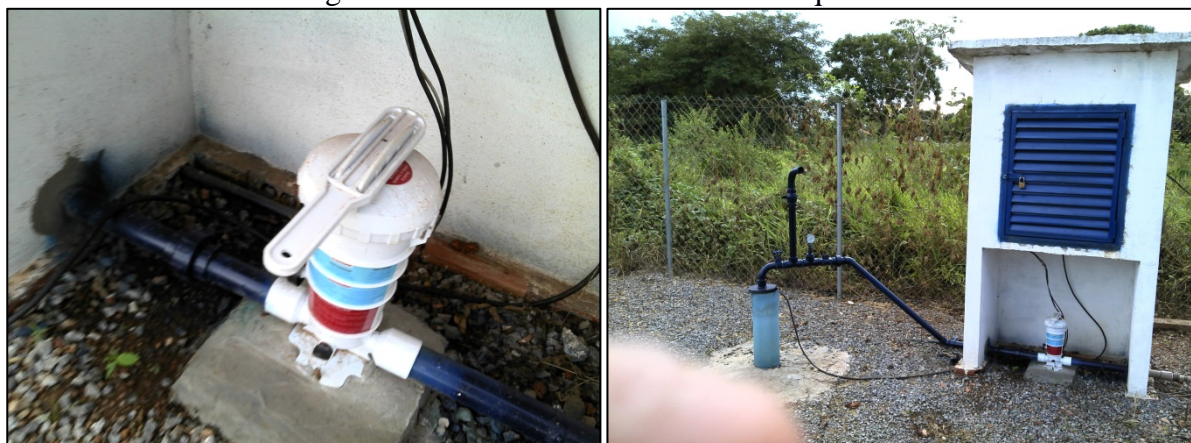
Figura 130. Dosador de cloro e casa de química
