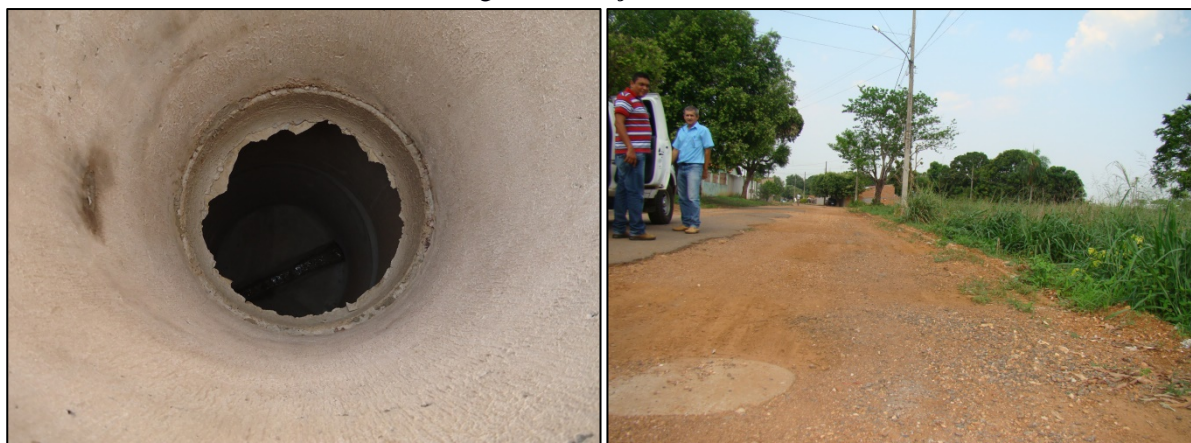
Figura 28. Poço de Visita
