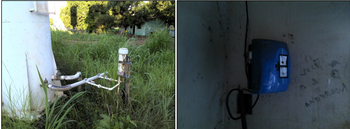
Figura 108. Detalhe do tratamento por cloração e quadro de comando
