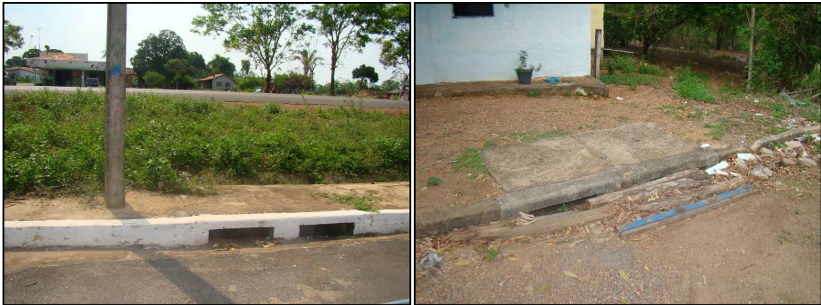
Figura 36. Boca de lobo limpa e obstruída
