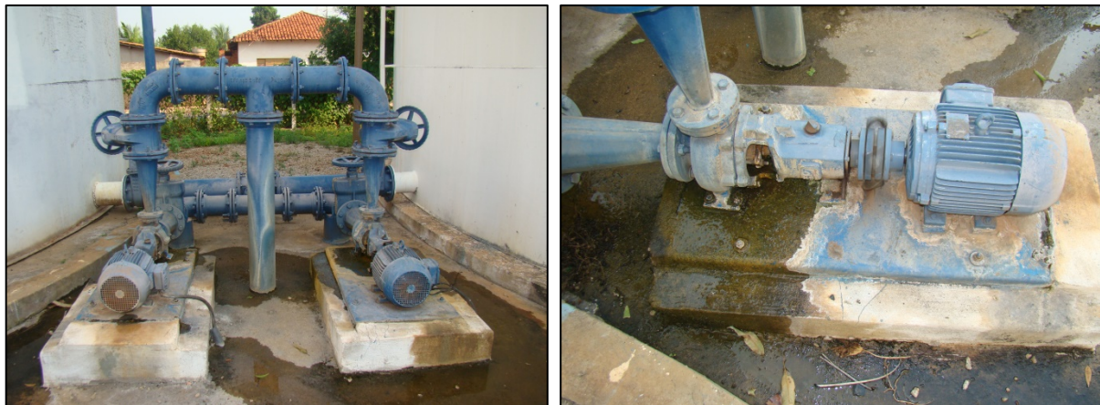
Figura 20. Elevatória de Água tratada
