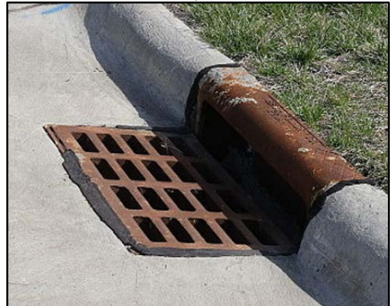
Figura 150. Boca de lobo com gradeamento na sarjeta
