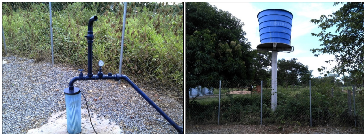
Figura 129. Poço tubular e reservatório elevado
