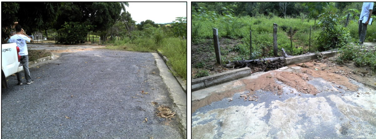
Figura 87. Desague da água na área verde e detalhe de sarjetas danificadas
