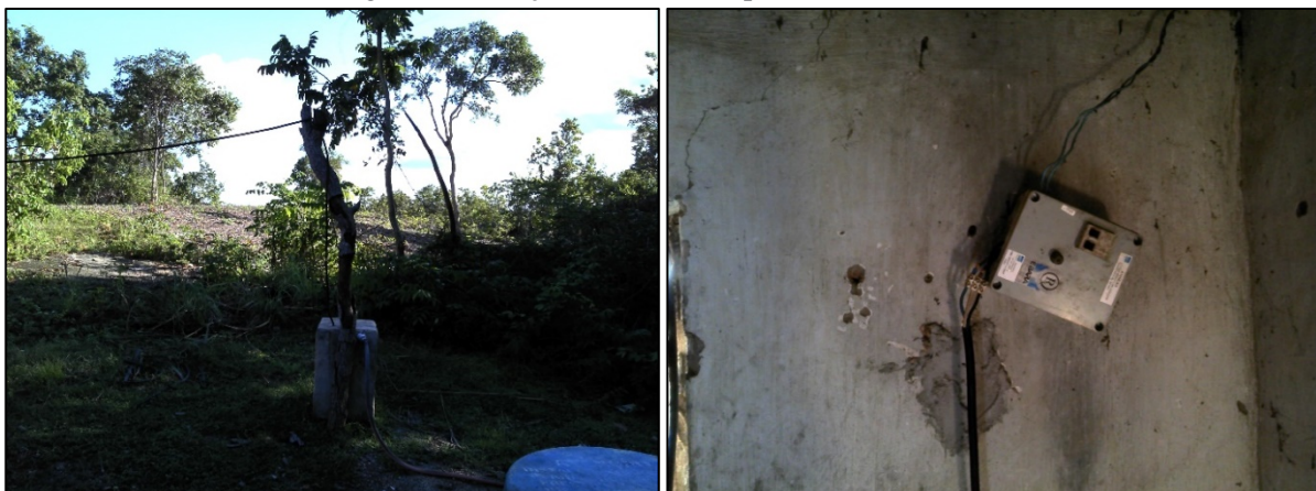
Figura 102. Poço desativado e quadro de comando
