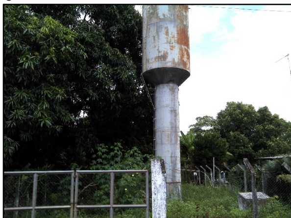
Figura 59. Reservatório Elevado do Distrito de Pirizal
