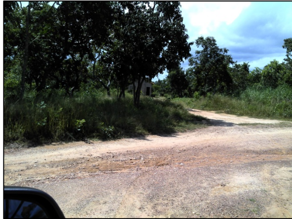
Figura 93. Vias não pavimentadas
