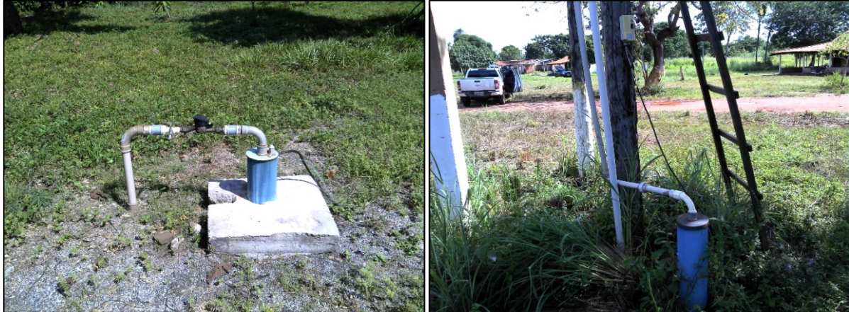
Figura 124. Poço tubular e detalhe do poço com manômetro
