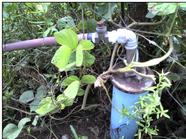
Figura 91. Poço tubular caseiro
