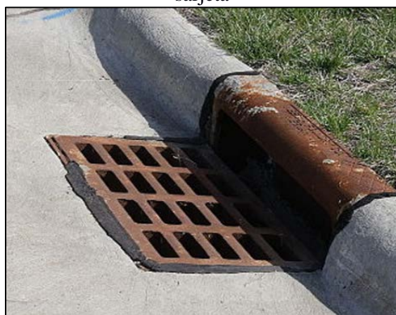
Figura 67. Boca de lobo com gradeamento na sarjeta
