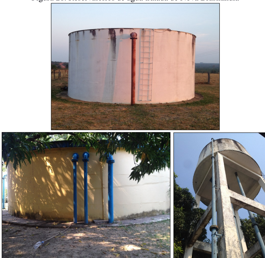
Figura 21. Reservatórios de água tratada de Nova Brasilândia
