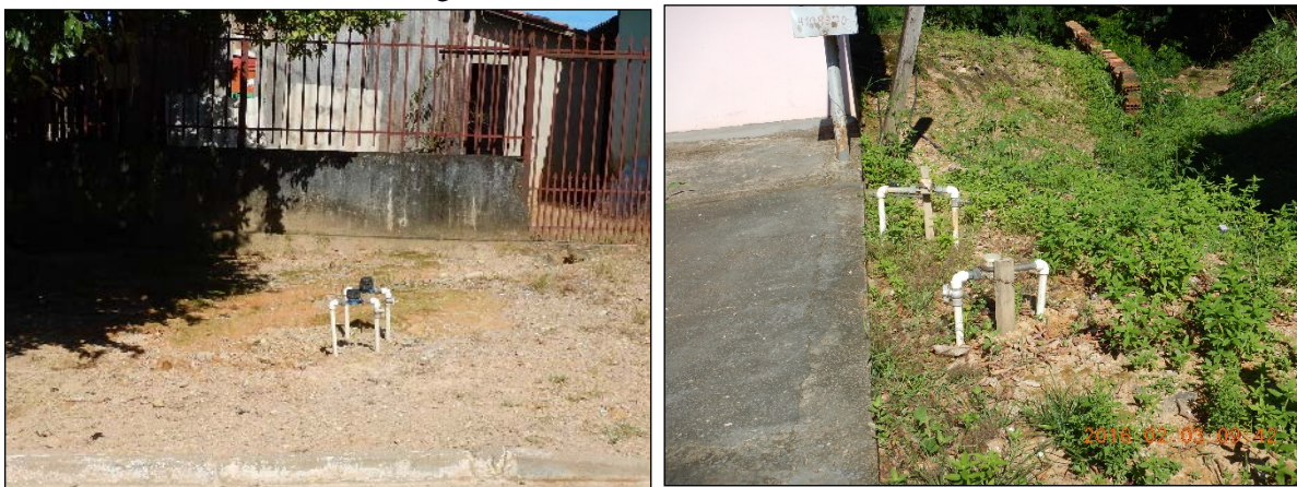
Figura 23. Cavaletes com hidrômetros
