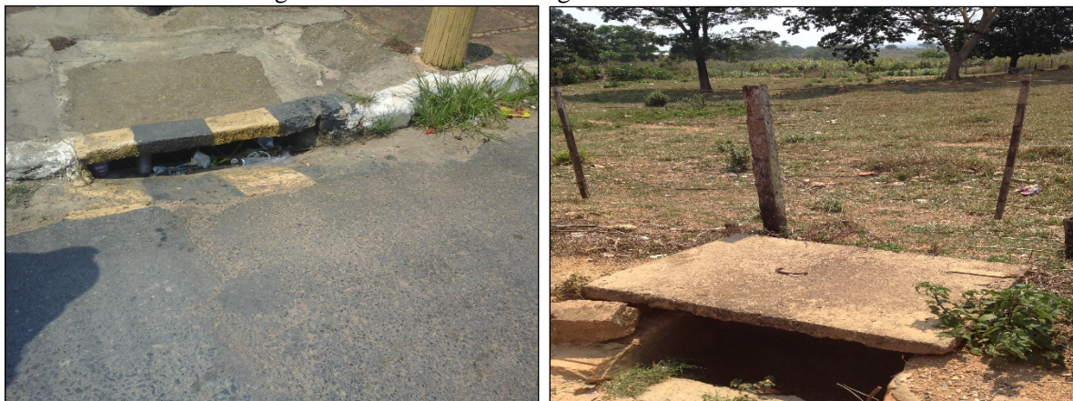
Figura 29. Sistema de Drenagem em Nova Brasilândia
