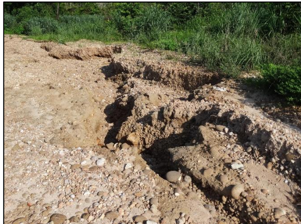
Figura 27. Erosão nos terrenos limítrofes da Rua Flor de Tubarão
