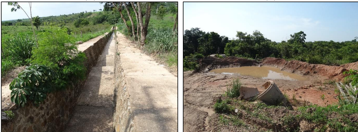
Figura 19. (A) Dissipador de energia no ribeirão São Francisco de Paula (B) Bacia de infiltração (A) (B)
