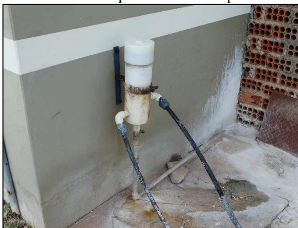
Figura 14. Clorador de pastilha instalado próximo ao R 01
