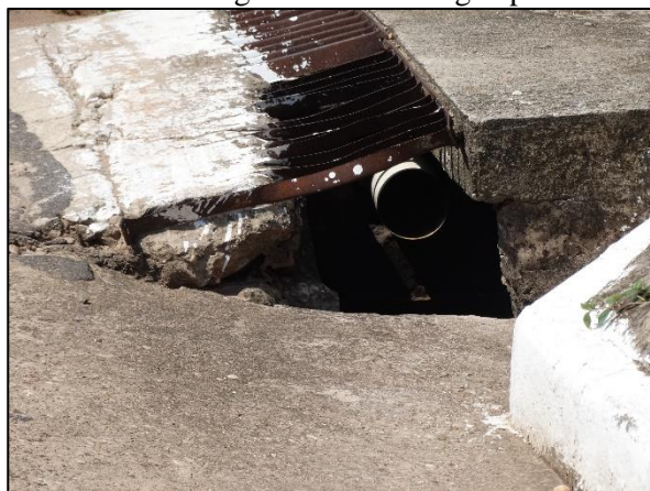
Figura 23. Ligação clandestina de esgoto na rede de água pluvial na Avenida Tiradentes
