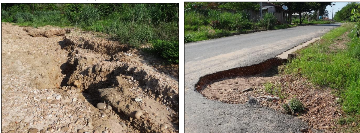
Figura 22. Problemas de drenagem ocorrido devido ao escoamento das águas no terreno natural (A) erosão pluvial (B) pavimento com erosão decorrente da ação da chuva (A) (B)
