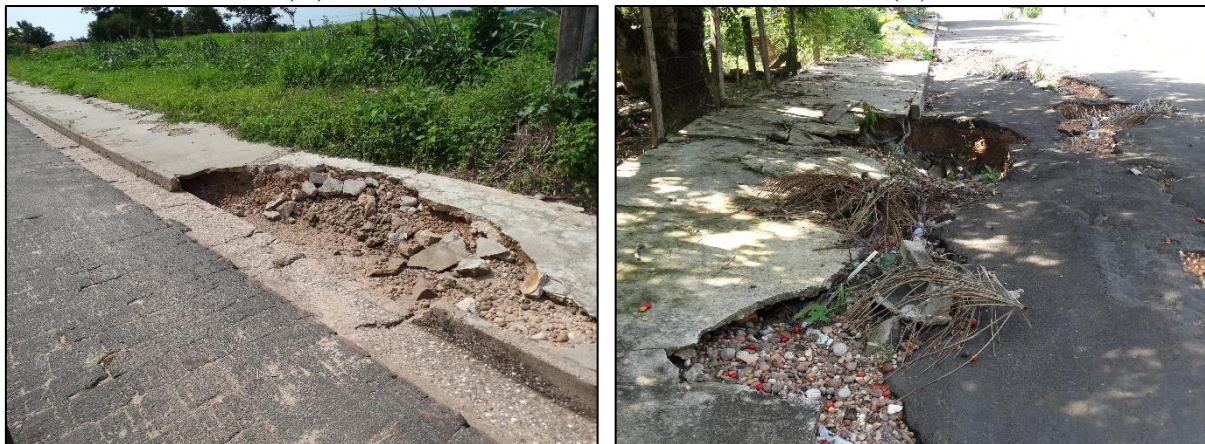
Figura 24. Danos ao pavimento das vias e a calçadas pela ausência de sistema de drenagem (A) erosão na calçada (B) erosão acometendo tanto a calçada, quanto a via
