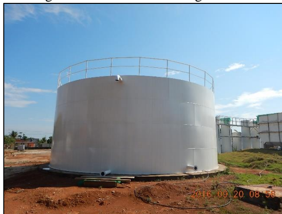
Figura 11. Reservatório de água tratada
