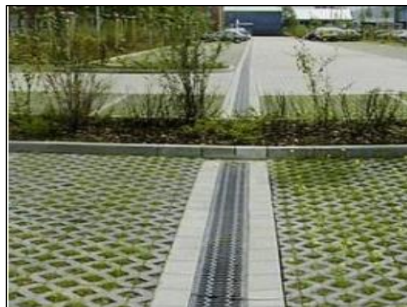
Figura 79. Trincheira de infiltração no estacionamento
