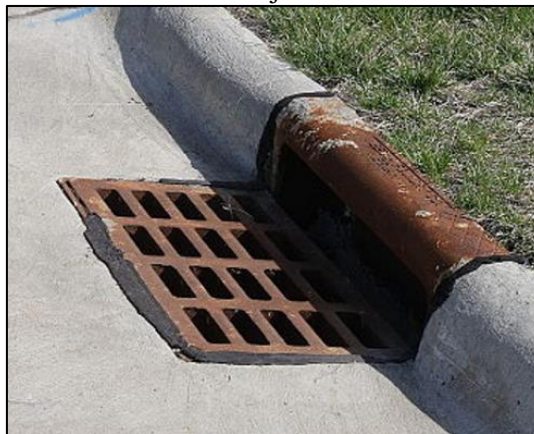
Figura 71. Boca de lobo com gradeamento na sarjeta
