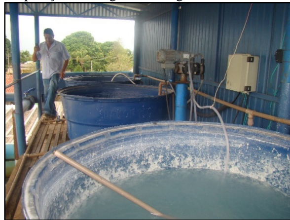
Figura 14. Preparação e dosagem do coagulante em caixa de polietileno
