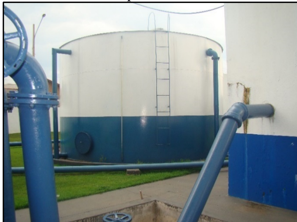
Figura 26. Reservatório apoiado metálico de 150 m 3 - R01
