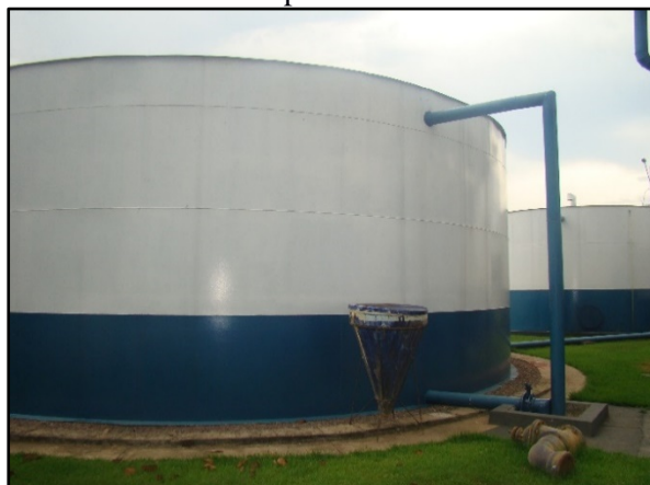
Figura 27. Reservatório apoiado metálico de 400 m 3 - R02
