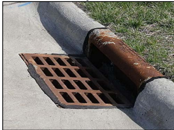
Figura 69. Boca de lobo com gradeamento na sarjeta
