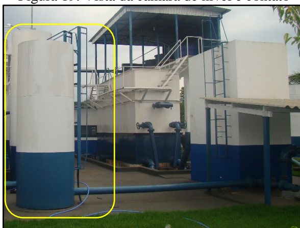
Figura 19. Vista da câmara de nível e contato
