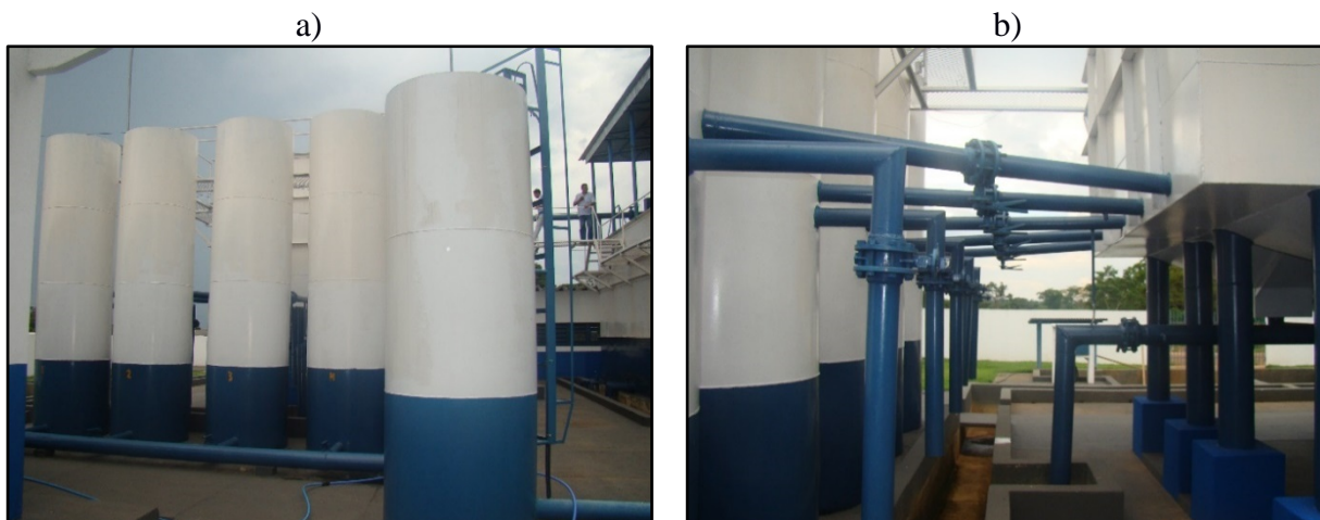
Figura 17. a) Posição dos filtros b) layout do encaminhamento da água do decantador para os filtros.
