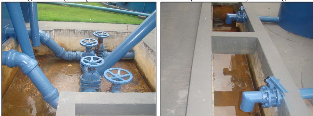
Figura 18. Registros para manobras dos filtros e tubulação de saída das águas de lavagem
