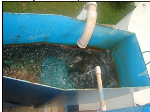
Figura 13. Calha parshall metálica
