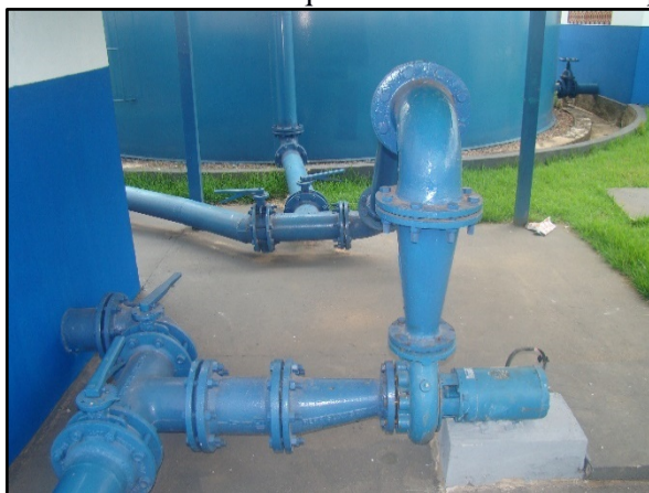
Figura 20. Conjunto moto-bomba de recalque das câmara de contato para os reservatórios
