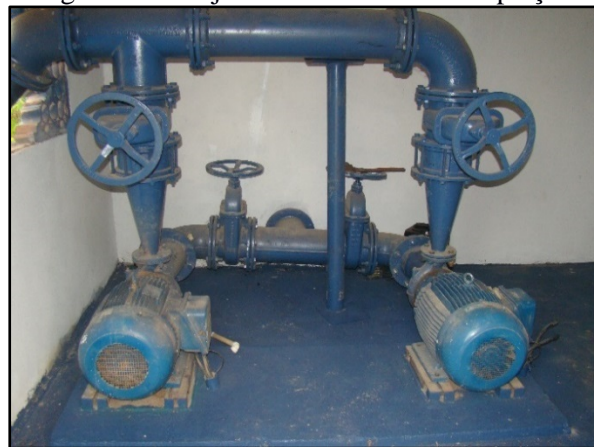
Figura 10. Conjunto moto bomba da captação
