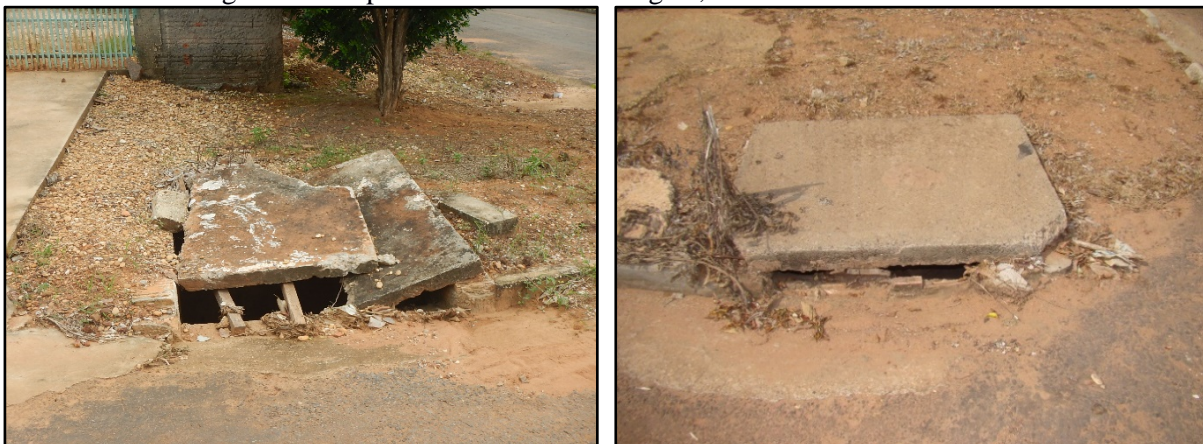
Figura 32. Dispositivos de microdrenagem, bocas de lobo danificadas
