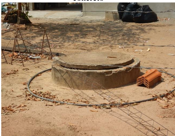
Figura 17. Fossa com base aparente e tampa de concreto
