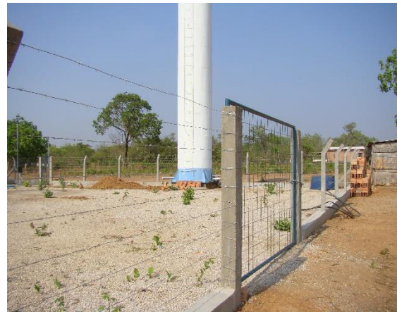
Figura 49 Reservatório instalado, distrito Vila Trindade.
