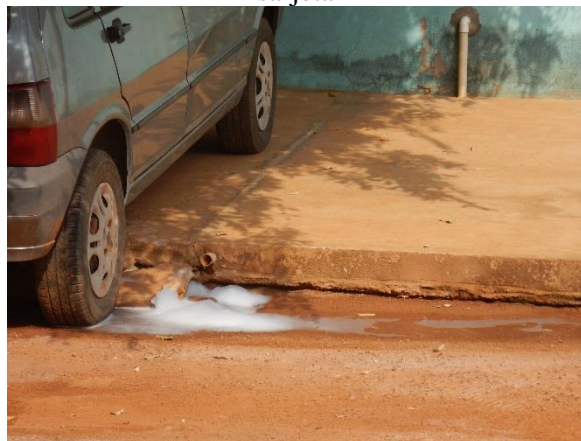
Figura 16. Lançamento de águas servidas na sarjeta
