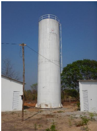
Figura 13. Reservatório cilíndrico metálico
