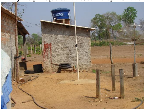
Figura 59. Vista da laje de proteção da fossa, sem suspiro, na comunidade Murere
