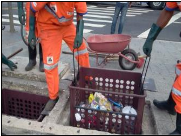
Figura 80. Cesta acoplada à boca do bueiro
