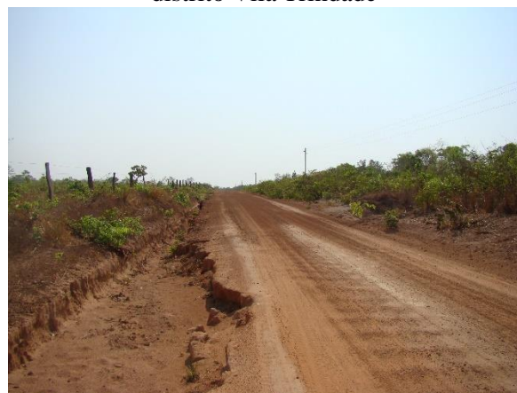
Figura 55. Processos erosivos na estrada do distrito Vila Trindade
