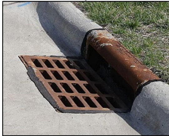
Figura 81. Boca de lobo com gradeamento na sarjeta
