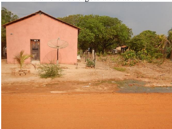
Figura 15. Extravasamento da fossa com vazamento do esgoto a céu aberto
