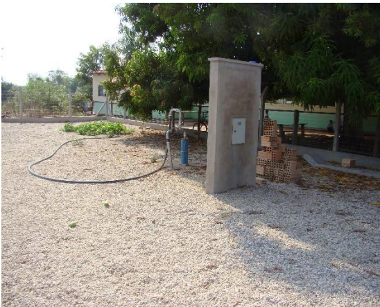
Figura 48. Abrigo para o quadro de comando do poço, distrito Vila Trindade.
