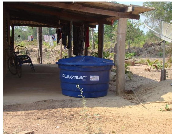
Figura 51 Reservatórios individuais para abastecimento por caminhão-pipa, distrito Vila Trindade
