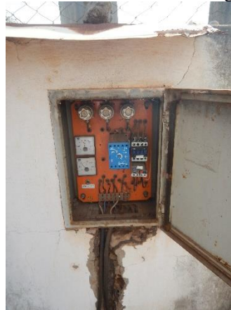
Figura 10. Quadro de comando com abrigo improvisado
