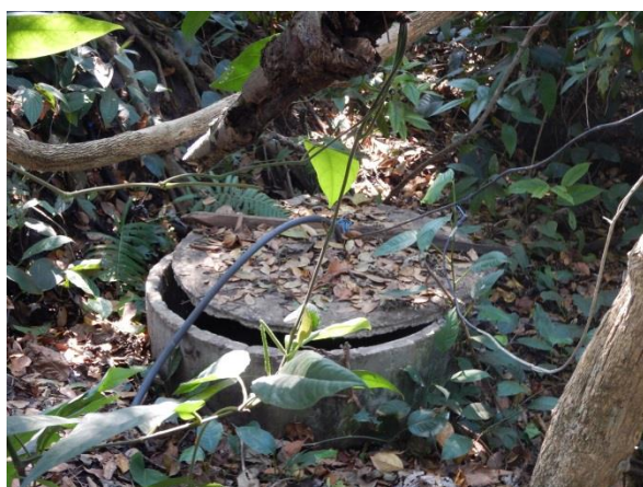
Figura 108. Mina de captação de água no Assentamento Santo Idelfonso
