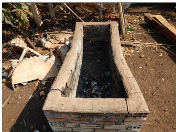
Figura 111. Vala utilizada para disposição de resíduos em uma residência no assentamento
