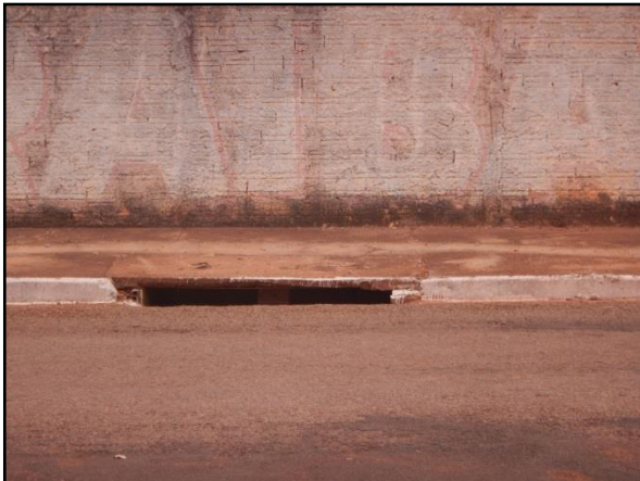
Figura 27. Boca de lobo dupla no sistema de microdrenagem do município na Avenida Manoel Brito
