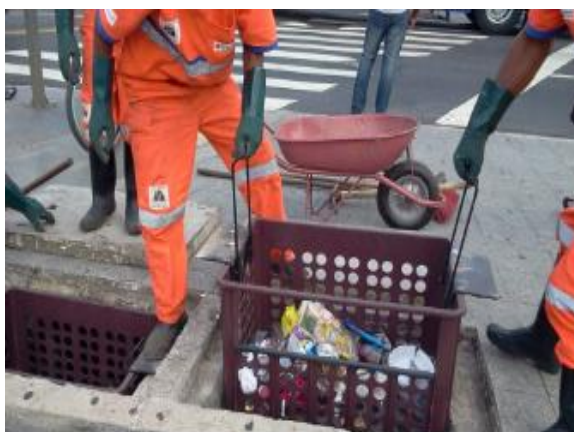
Figura 123. Cesta acoplada à boca do bueiro
