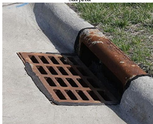
Figura 124. Boca de lobo com gradeamento na sarjeta
