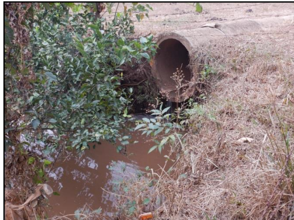
Figura 28. Local de despejo de águas pluviais da tubulação coletora principal no córrego Fundo, sem dissipador de energia
