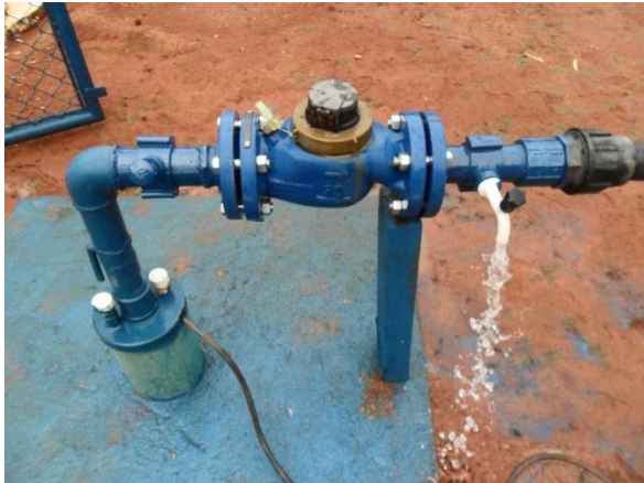
Figura 100. Vista do poço tubular profundo no distrito Itaquerê
