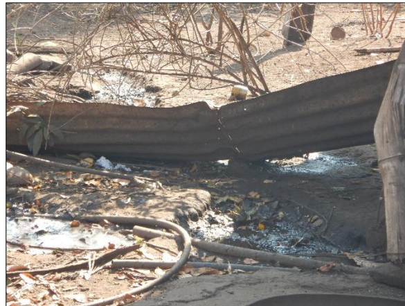
Figura 110. Efluente domiciliar escoando a céu aberto em residência de Santo Idelfonso
