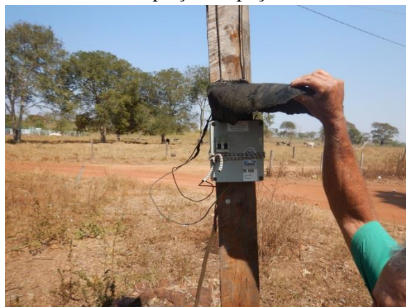
Figura 107. Painel de controle da bomba de captação do poço
