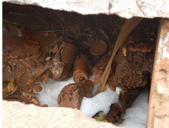
Figura 34. Ligação clandestina de esgoto ao sistema de drenagem da rua Manoel Brito
