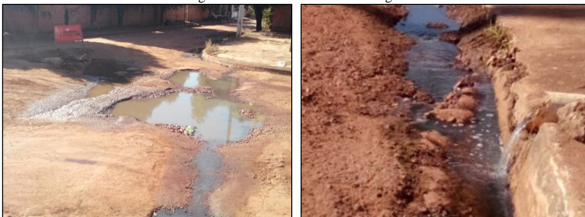
Figura 51. Pontos de acumulo de água
