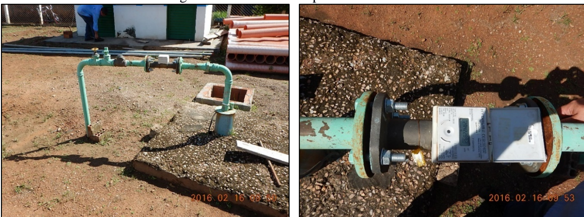
Figura 29. Estrutura e dispositivos do PT 04
