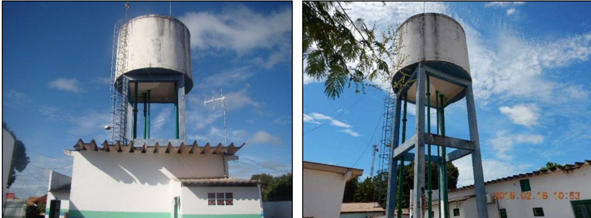
Figura 37. Reservatório elevado REL – 01, capacidade de 75m 3
