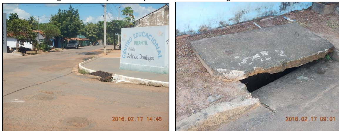
Figura 55. Situação dos dispositivos de microdrenagem de Pedra Preta
