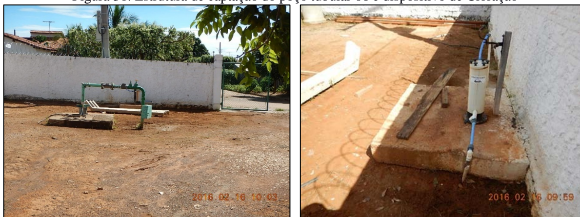
Figura 31. Estrutura de captação do poço tubular 06 e dispositivo de Cloração
