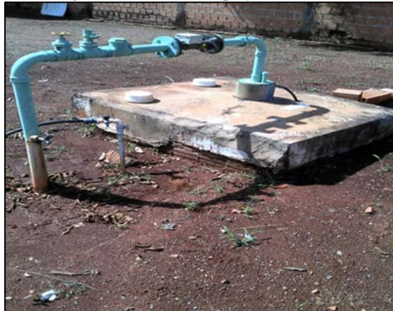
Figura 32. Estrutura poço tubular 07
