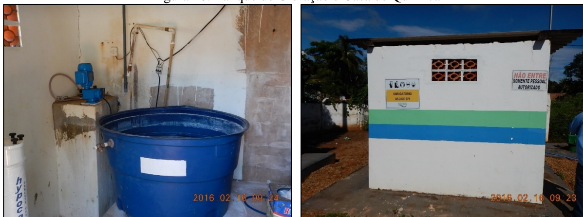
Figura 40. Tanque de Cloração e Casa de Química
