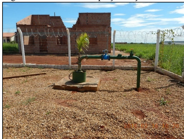
Figura 33. Estrutura de captação Poço Tubular 08
