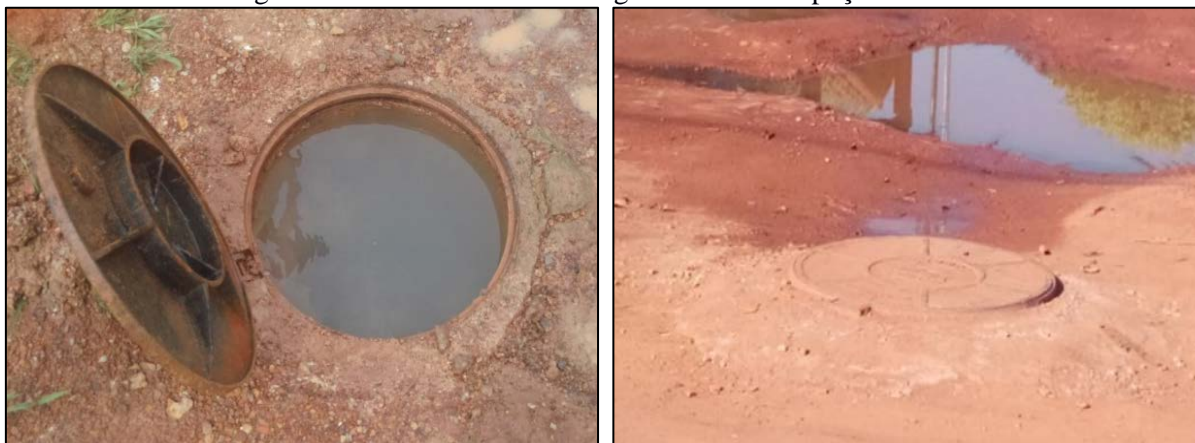
Figura 46. Extravasamento de esgoto através dos poços de visita
