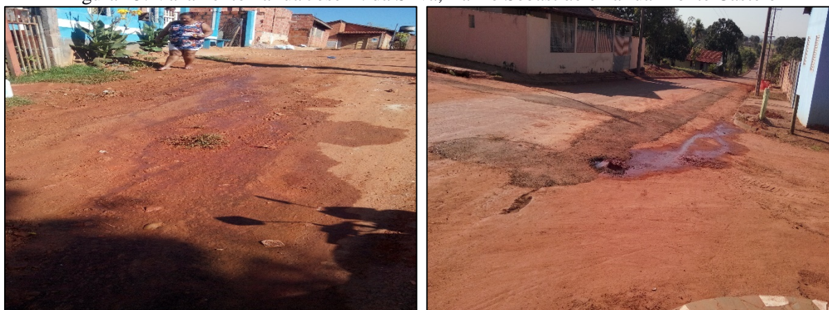
Figura 45. Vazamento na rua José B. da Silva, Bairro Sebastião e na rua Monte Castelo
