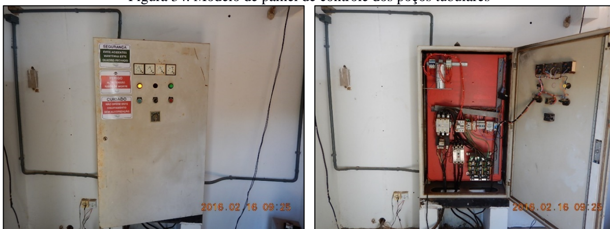
Figura 34. Modelo de painel de controle dos poços tubulares
