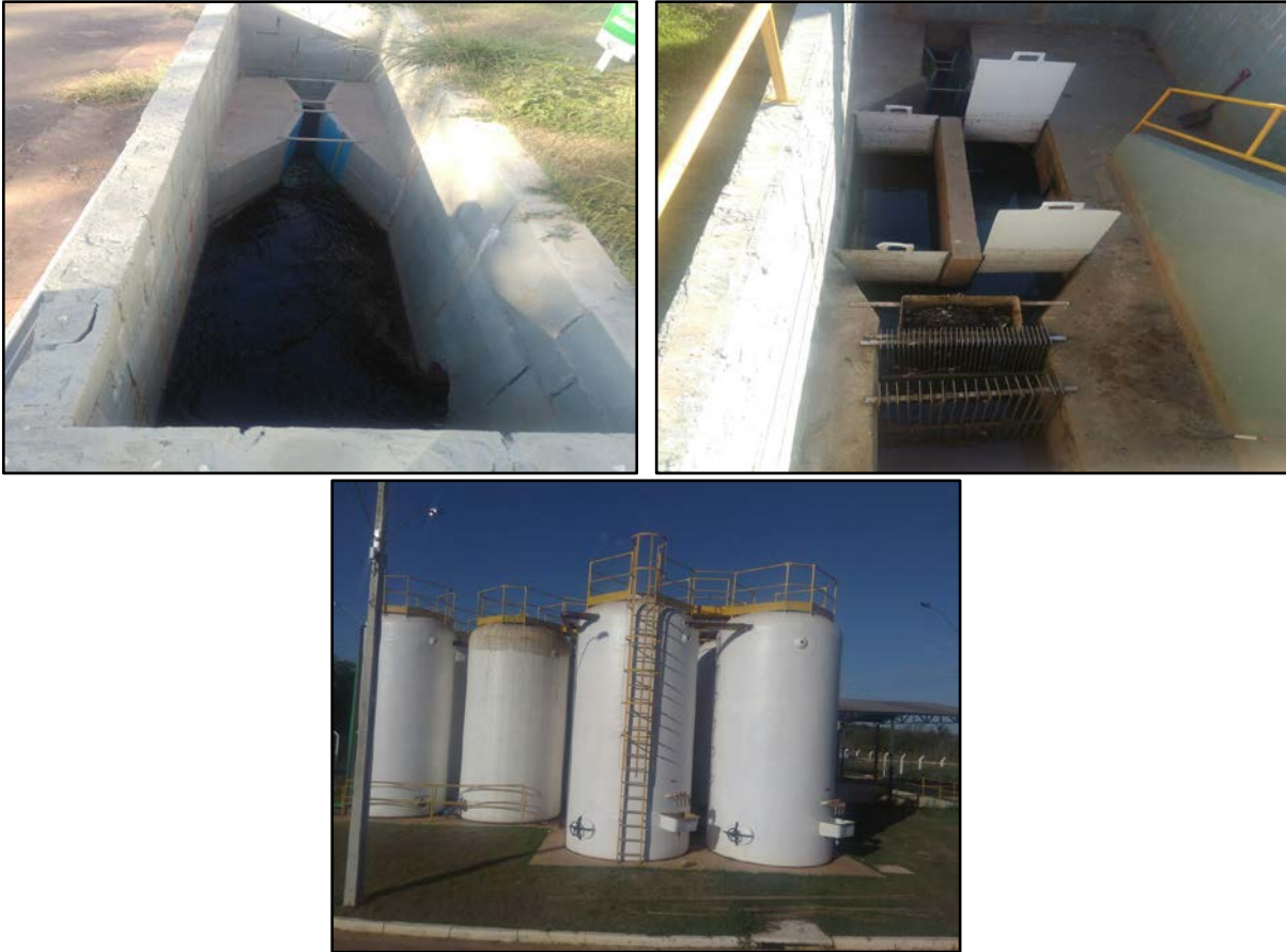
Figura 50. Sistema de Tratamento de Esgoto – ETE Jurigue
