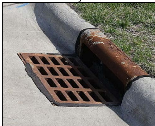
Figura 104. Boca de lobo com gradeamento na sarjeta
