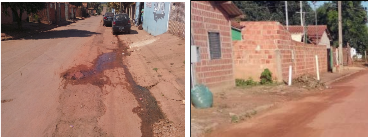
Figura 47. Fossa rudimentar na calçada e escoamento a céu aberto no município de Pedra Preta
