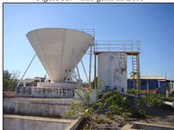
Figura 52. Visão geral da ETA
