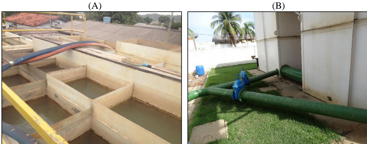
Figura 16. (A) Floculador da ETA de Peixoto de Azevedo (B) Tubulações implantadas após a readequação do sistema
