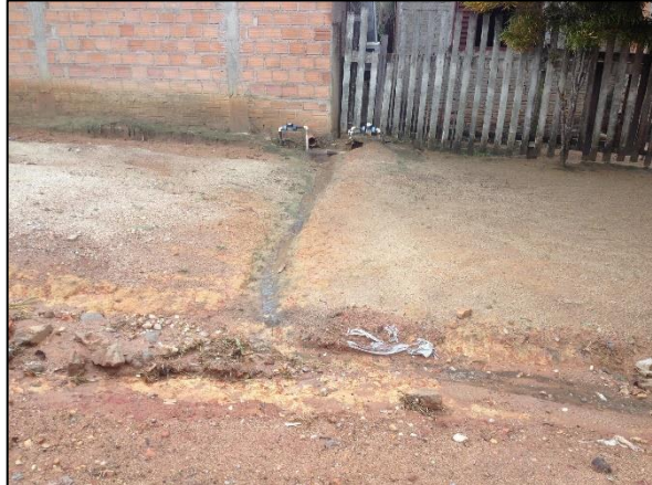
Figura 27. Lançamento de águas servidas em vias públicas
