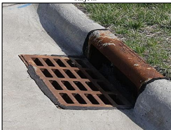
Figura 83. Boca de lobo com gradeamento na sarjeta
