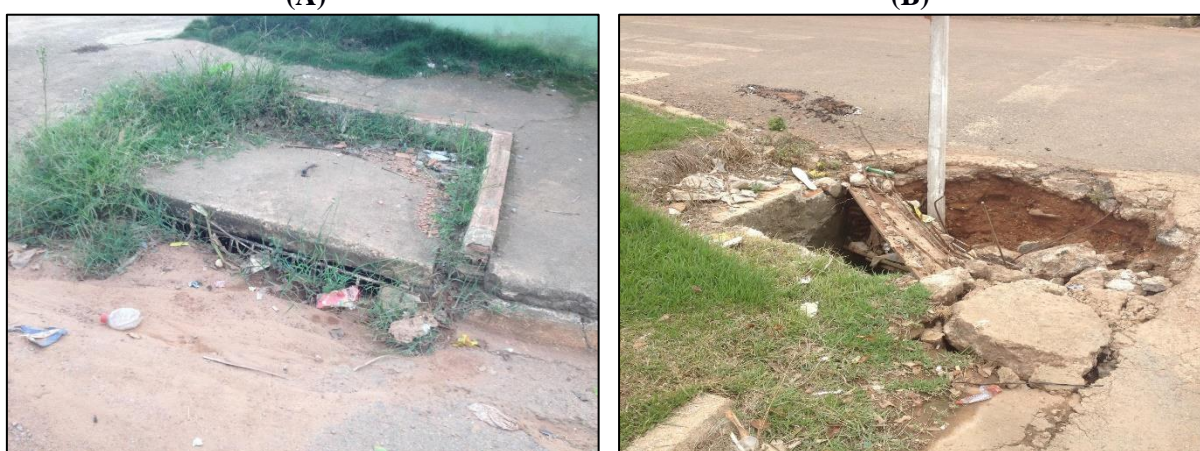
Figura 31. (A) Lixo na entrada da boca de lobo (B) Boca de lobo comprometida devido à danos físicos
