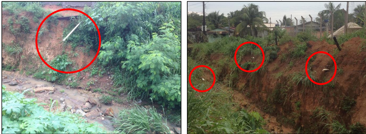
Figura 32. (A) Tubulação de esgoto despejando efluentes domésticos no Córrego da Av. Brasil (B) Detalhe das tubulações ao longo do trecho do corpo hídrico
