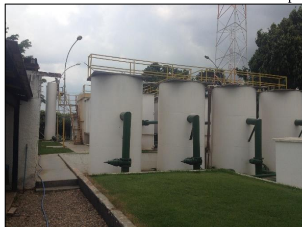
Figura 13. ETA metálica da sede urbana de Peixoto de Azevedo com capacidade nominal de 50 L/s
