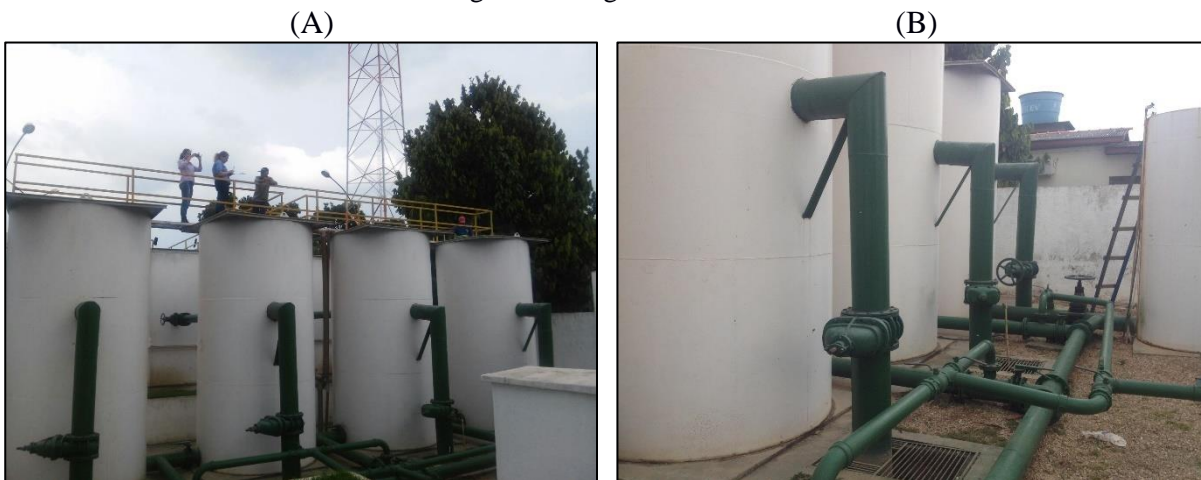
Figura 18. (A) Filtros de múltiplas camadas com fluxo descendentes (B) Tubulação para descarte da água de lavagem do filtro
