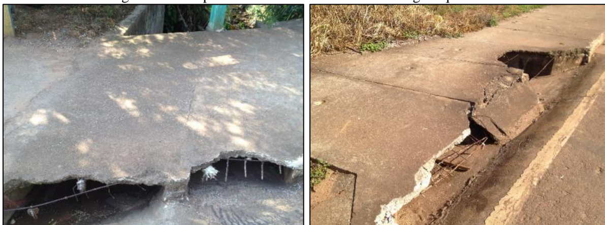
Figura 47. Componentes do sistema de microdrenagem quebrados
