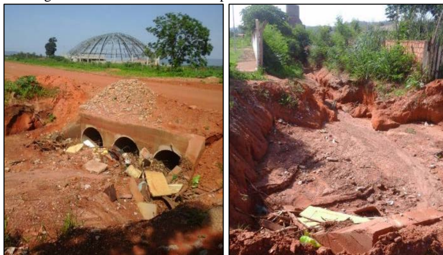
Figura 45. Erosões em ruas não pavimentadas de Pontes e Lacerda
