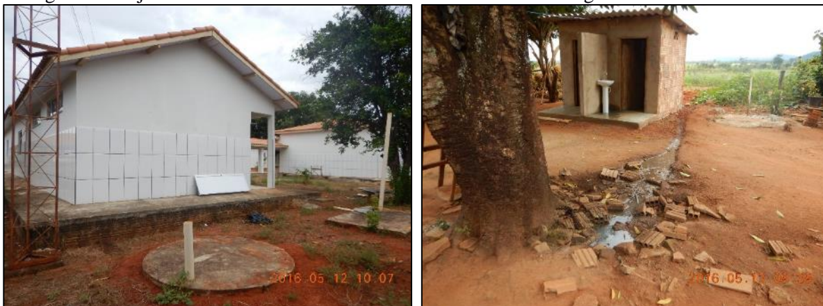
Figura 83. Laje de fossa s observadas em residências do distrito e esgoto escoando a céu aberto
