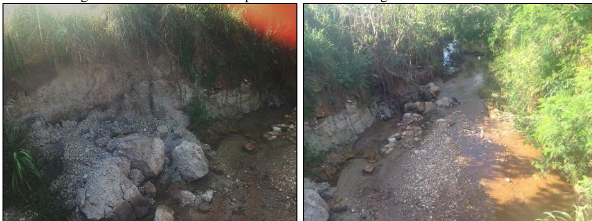
Figura 46. Erosões em canais perenes de macrodrenagem em Pontes e Lacerda
