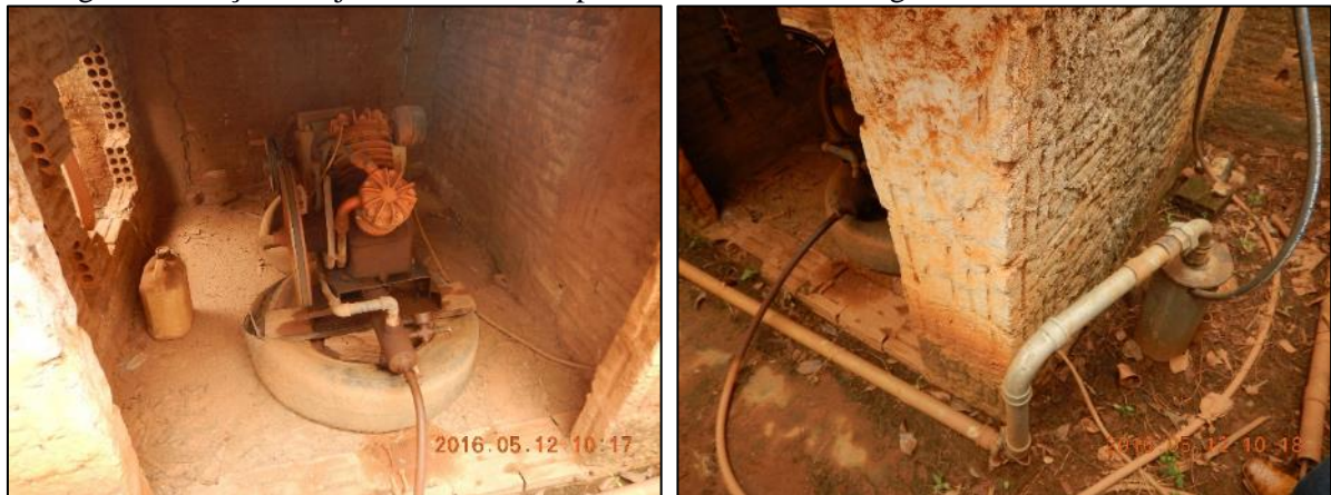
Figura 80. Poço e conjunto motobomba para abastecimento de água localizados na Vila Matão
