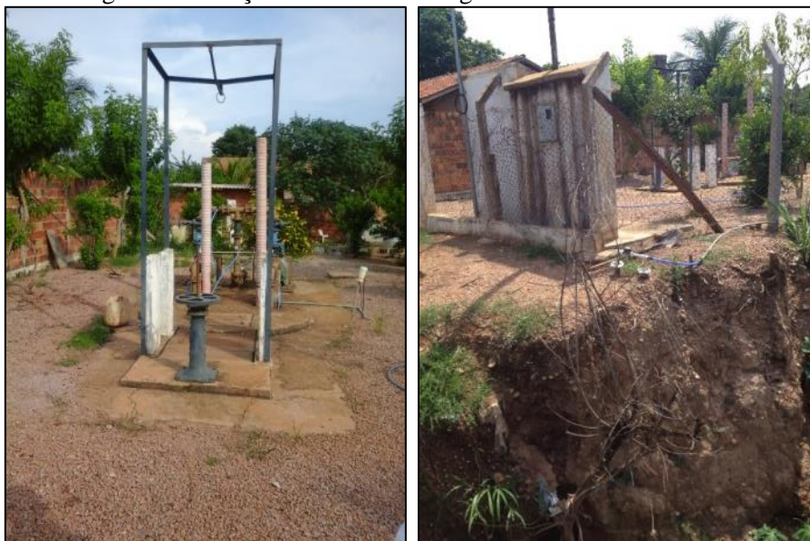
Figura 20. Estação Elevatória de Esgoto 1 de Pontes e Lacerda
