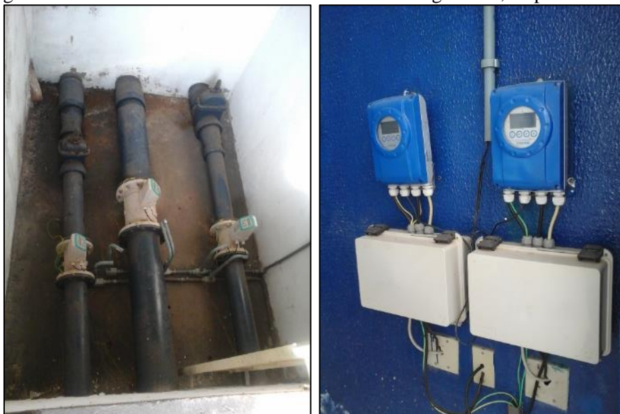
Figura 9. Medidores de vazão ultrassônicos e eletromagnéticos, respectivamente
