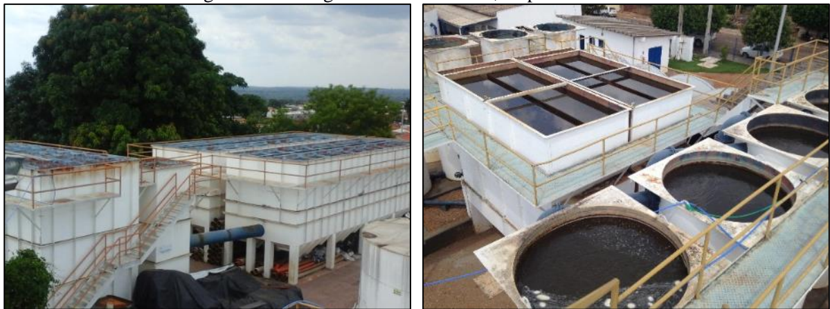
Figura 10. Vista geral das ETAs 1 e 2, respectivamente
