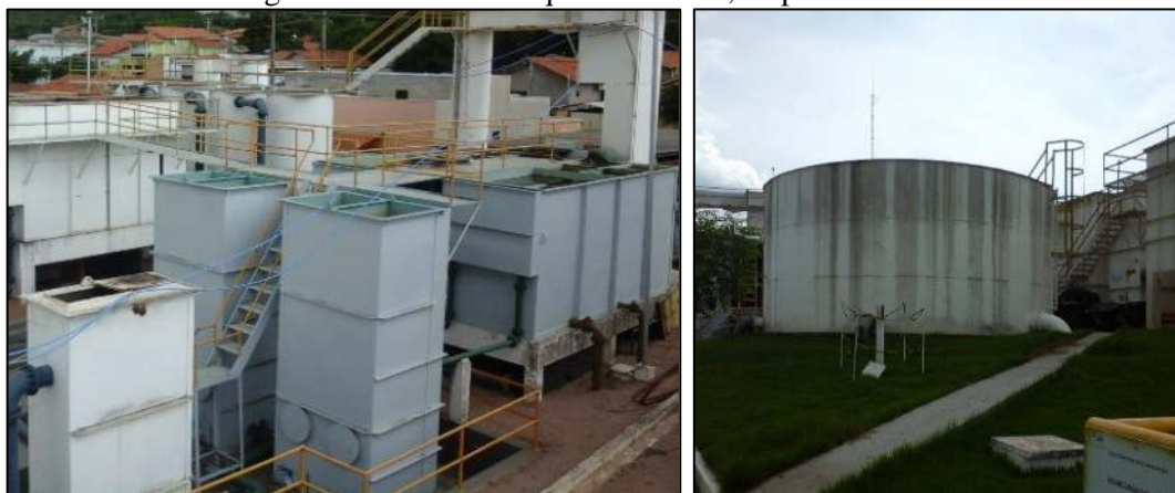
Figura 11. ETA 3 e tanque de contato, respectivamente
