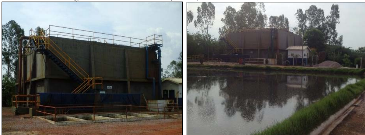
Figura 24. Reator anaeróbio (UASB) da ETE de Pontes e Lacerda
