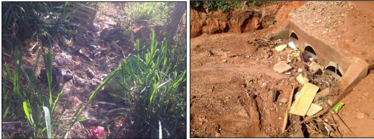
Figura 48. Disposição incorreta de resíduos sólidos às margens do córrego Buriti e obstrução dos componentes de drenagem da cidade de Pontes e Lacerda
