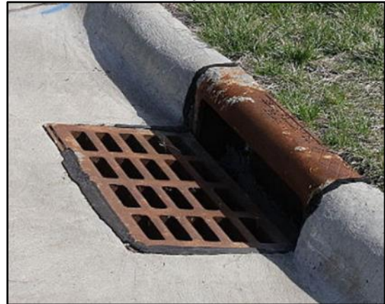
Figura 106. Boca de lobo com gradeamento na sarjeta
