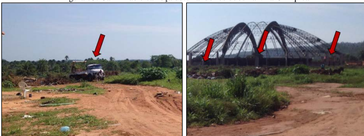
Figura 73. Caminhão e carroça destinando resíduos na Vila Olímpica
