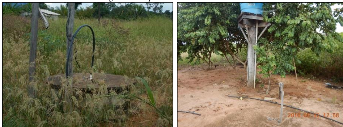
Figura 90. Poço raso e reservatório do PSF
