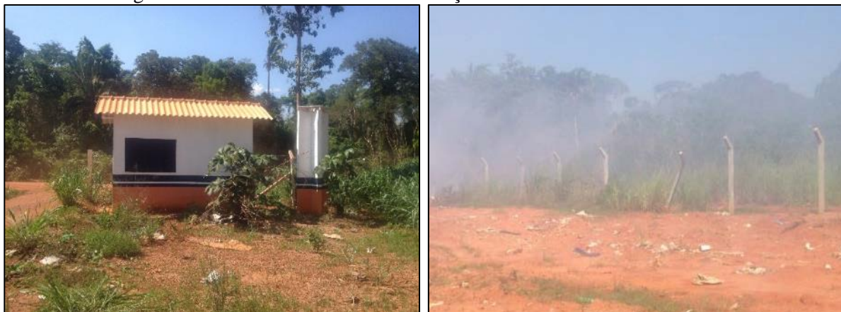
Figura 61. Guarita e cerca em más condições no lixão de Pontes e Lacerda
