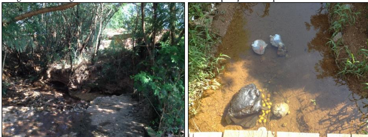
Figura 42. Córrego Marechal Rondon assoreado e com disposição inadequada de resíduos sólidos
