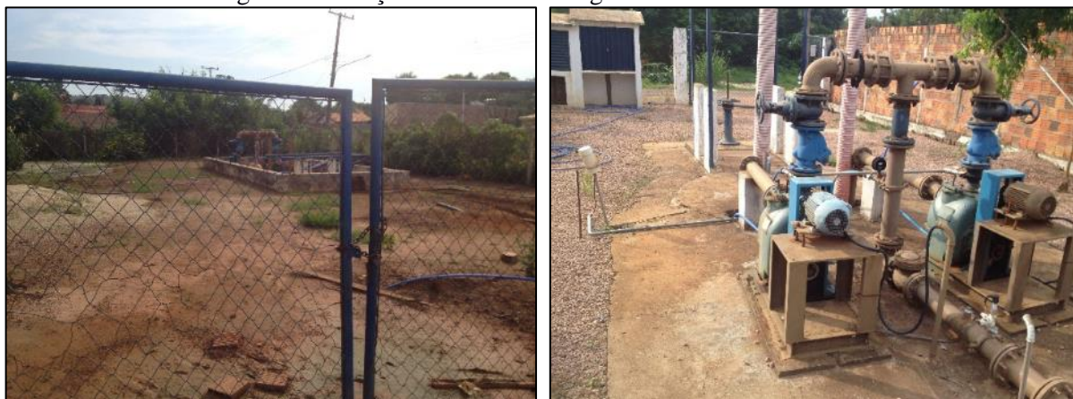
Figura 21. Estação Elevatória de Esgoto 2 de Pontes e Lacerda
