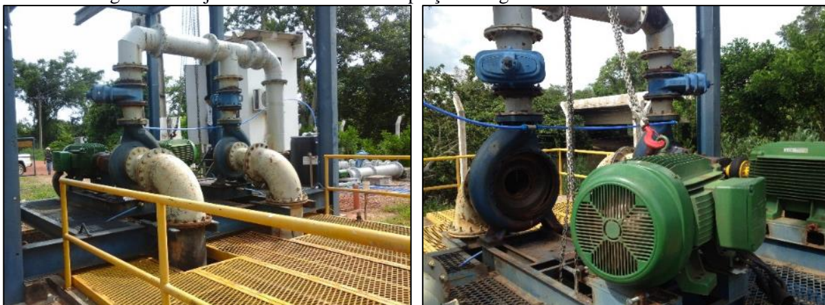
Figura 8. Conjunto motor-bomba da captação de água bruta de Pontes e Lacerda
