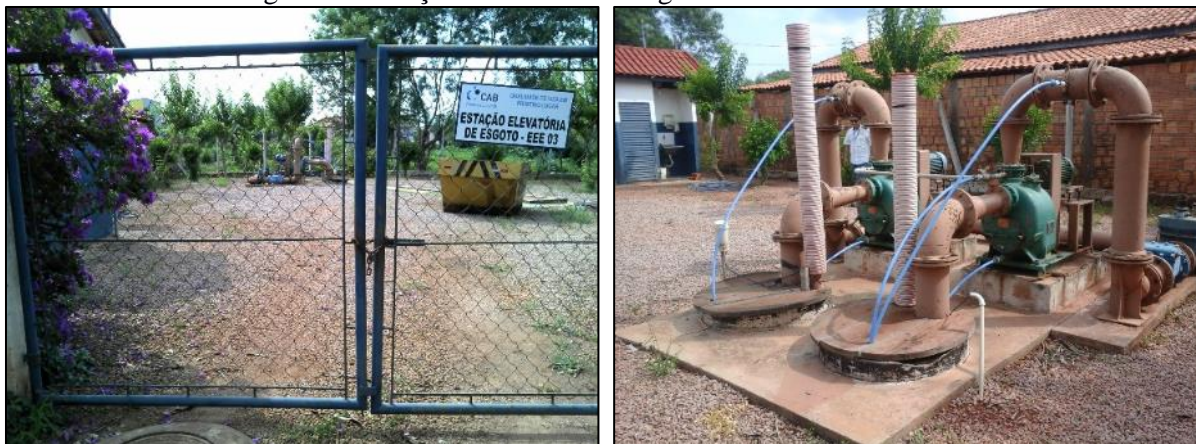
Figura 22. Estação Elevatória de Esgoto 3 de Pontes e Lacerda
