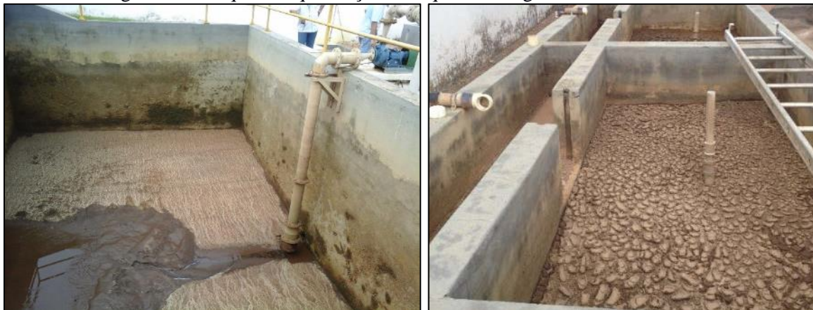
Figura 75. Tanque de equalização e tanque de secagem de lodo das ETAs
