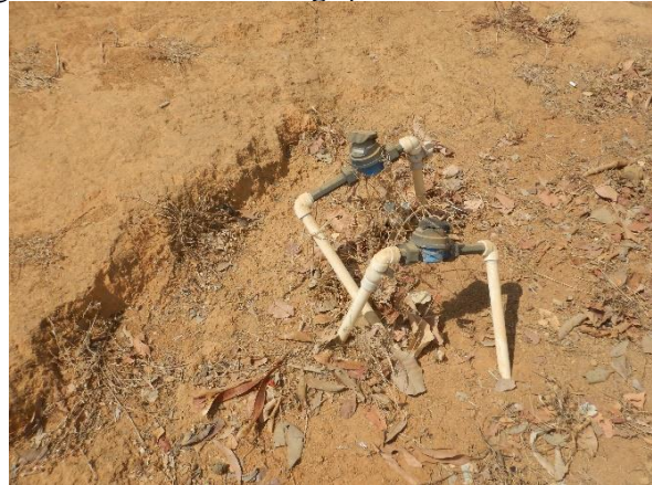
Figura 81. Vista exterior ligação domiciliar e hidrômetro
