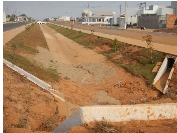
Figura 41. Drenagem pluvial na Avenida Central
