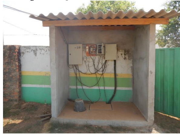
Figura 19. Quadro de comando PT-08
