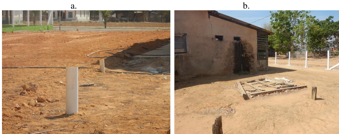
Figura 82. Vista exterior de fossa com suspiro (a) e sem suspiro (b)
