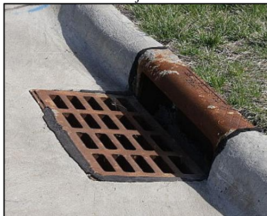
Figura 118. Boca de lobo com gradeamento na sarjeta
