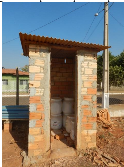
Figura 25. Depósito de produtos químicos
