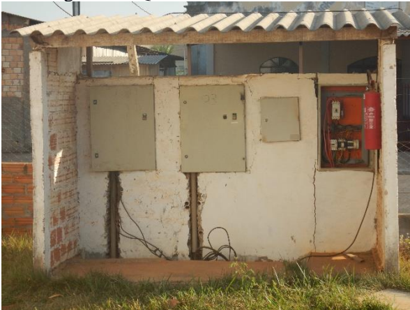
Figura 18. Quadro de comando PT-01
