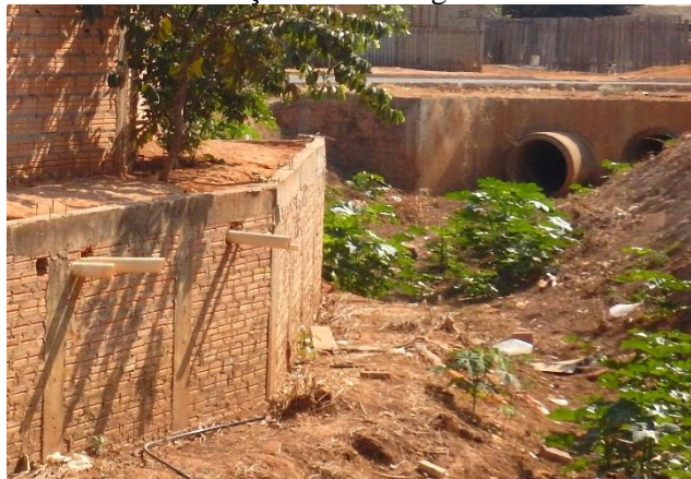
Figura 45. Ponto de lançamento do esgoto na rede de drenagem
