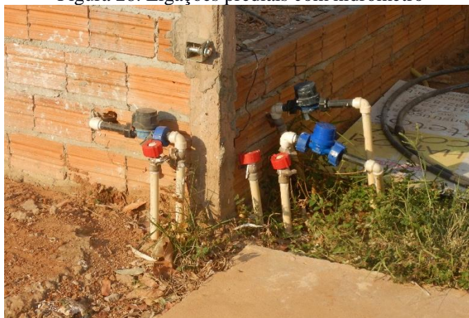
Figura 28. Ligações prediais com hidrômetro
