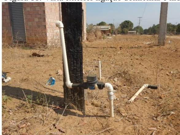
Figura 88. Vista exterior ligação domiciliar e hidrômetro
