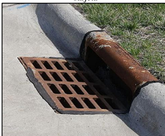
Figura 98. Boca de lobo com gradeamento na sarjeta
