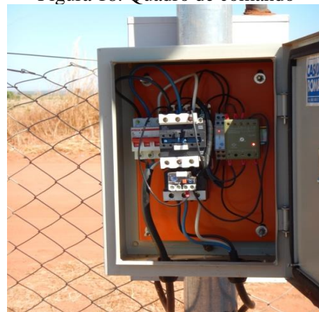
Figura 18. Quadro de comando
