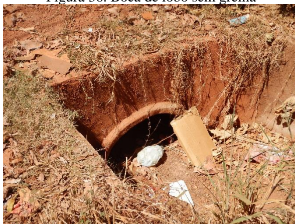
Figura 36. Boca de lobo sem grelha
