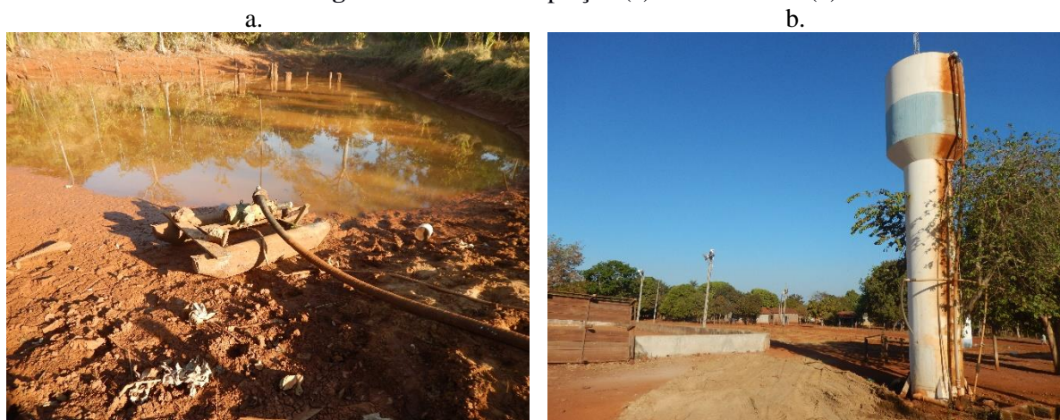
Figura 66. Vista da captação (a) e reservatório (b).
