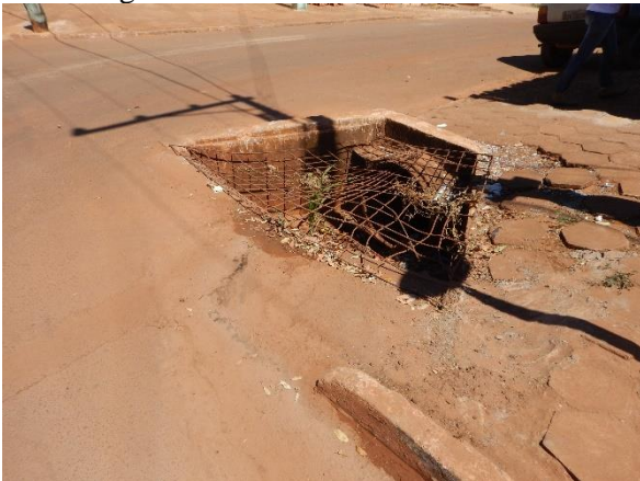
Figura 32. Boca de lobo danificada
