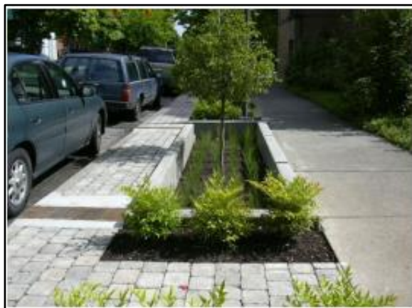
Figura 61. Trincheira de infiltração no passeio
