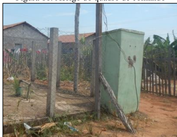
Figura 10. Abrigo do quadro de comando
