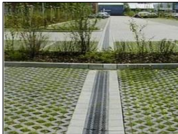
Figura 62. Trincheira de infiltração no estacionamento
