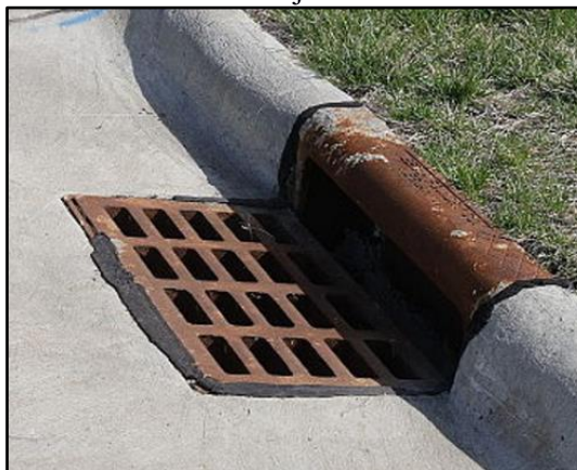
Figura 54. Boca de lobo com gradeamento na sarjeta
