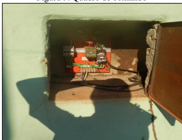
Figura 9. Quadro de comando
