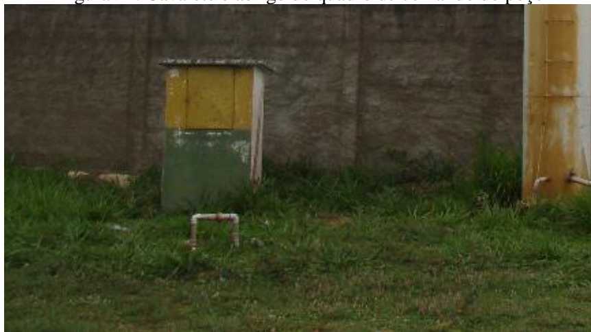
Figura 12. Cavalete e abrigo do quadro de comando do poço
