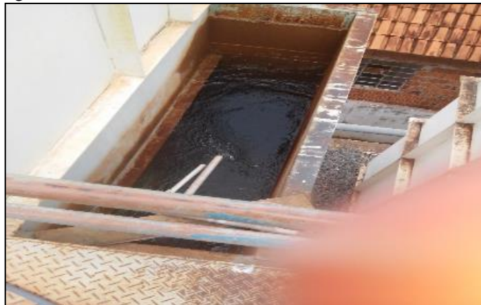
Figura 23. Decantador de alta taxa, coberto, da ETA metálica
