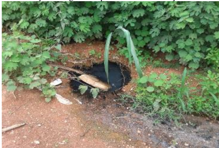
Figura 53. Tubulação de esgoto rompida em frente à estação elevatória
