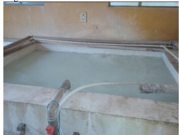
Figura 30. Reservatório de sulfato de alumínio
