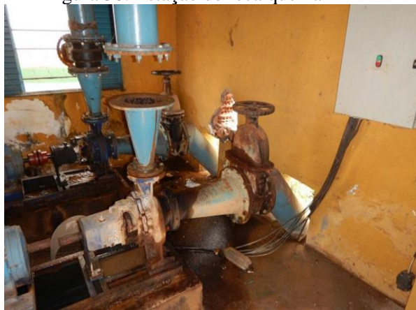
Figura 38. Estação de recalque na ETA
