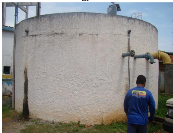
Figura 31. Reservatório concreto apoiado - 150 m 3
