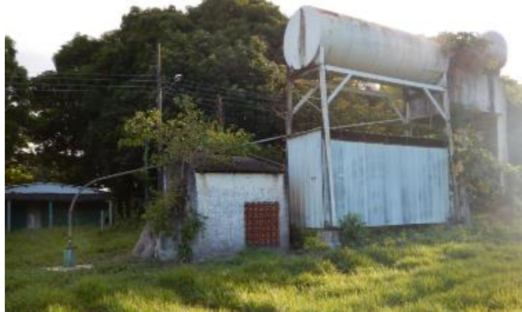
Figura 138. Poço 01 e reservatório
