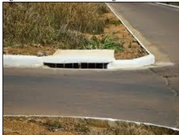
Figura 159. Boca de lobo com gradeamento
