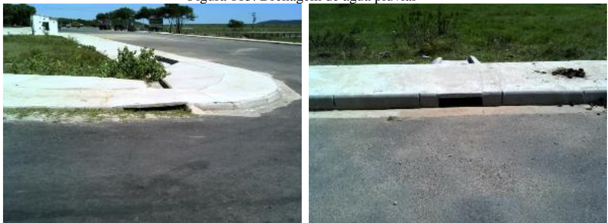
Figura 113. Drenagem de água pluvial
