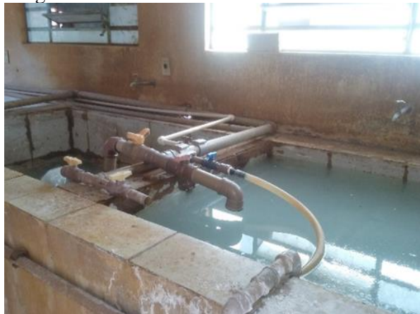
Figura 29. Reservatório de sulfato de alumínio
