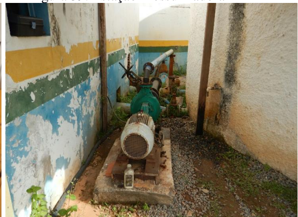
Figura 39. Estação Pressurizadora - EP 1
