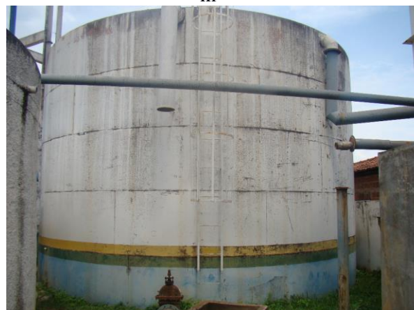
Figura 32. Reservatório metálico apoiado - 350 m 3
