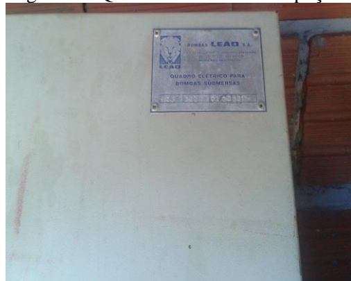
Figura 14. Quadro de comando do poço 3
