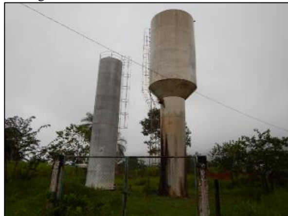
Figura 125. Área dos reservatórios
