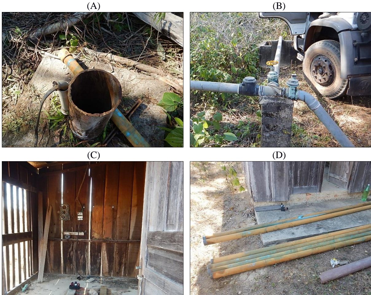
Figura 40. (A) Vista da boca do poço tubular (B) Cavalete de saída d'água e registro (C) Disjuntor para acionamento/desligamento da bomba (D) Tubulações de sucção do poço
