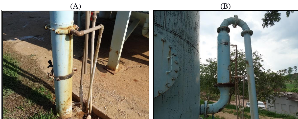
Figura 10. (A) Ponto de aplicação do sulfato de alumínio (B) Dispersos hidráulico de entrada no floco-decantador
