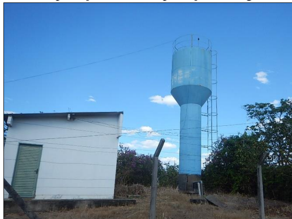
Figura 48. Reservatório elevado, tipo taça e cerca de proteção, 6ª Agrovila, Terra Nova do Norte-MT.
