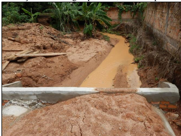
Figura 24. Lançamento de águas pluviais, sem dissipador de energia
