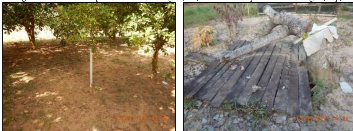
Figura 70. Vista do suspiro de uma fossa negra (dir.) e vista da tampa outra fossa negra (esq.)
