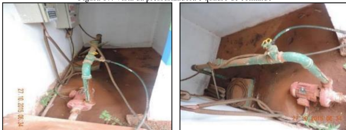
Figura 17. Vista da pressurizadora e quadro de comando
