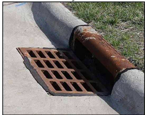
Figura 112. Boca de lobo com gradeamento na sarjeta
