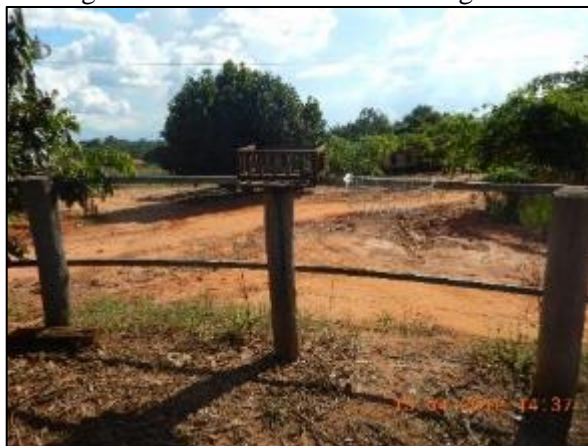
Figura 71. Pontos de erosão em Jaguaribe
