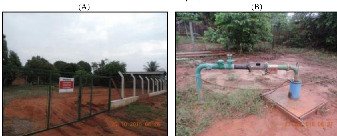
Figura 10. Urbanização da área do poço (PT 02) (A), barrilete (B), macromedidor (C) e registro e válvula de retenção (D)
