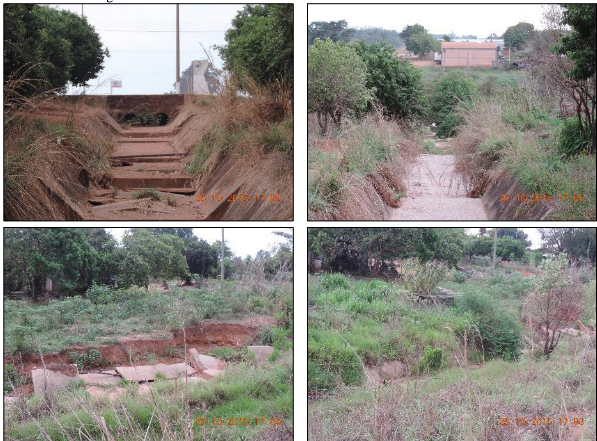
Figura 34. Problemas observados no canal existente em União do Sul
