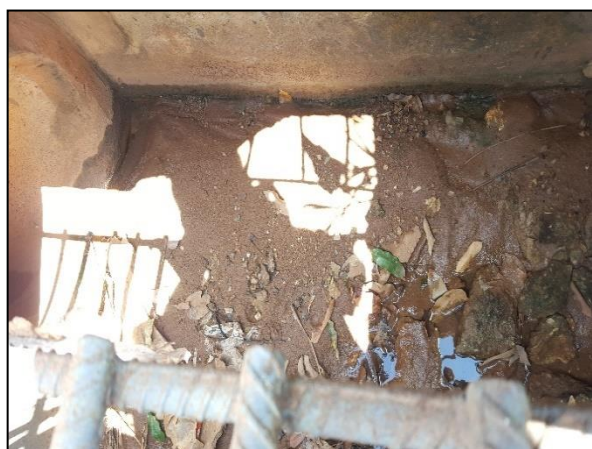
Figura 40. Boca de lobo com tampa danificada e com seu interior assoreado
