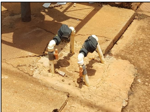
Figura 24. Hidrômetros instalados em ligações domiciliares na sede urbana de Santo Antônio do Leste
