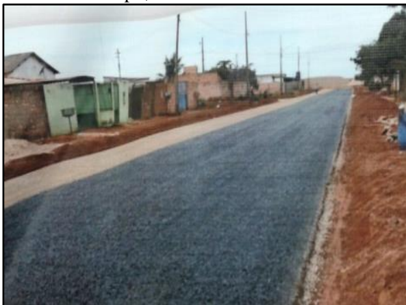
Figura 34. Execução da pavimentação no bairro Novo Campo, em Santo Antônio do Leste
