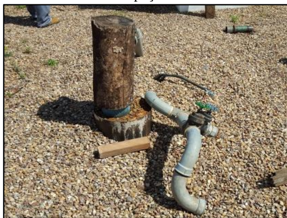
Figura 69. Barrilete desmontado do poço tubular do assentamento Matrinchã
