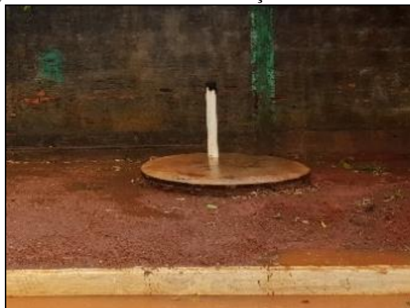
Figura 28. Fossa absorvente na calçada de uma residência
