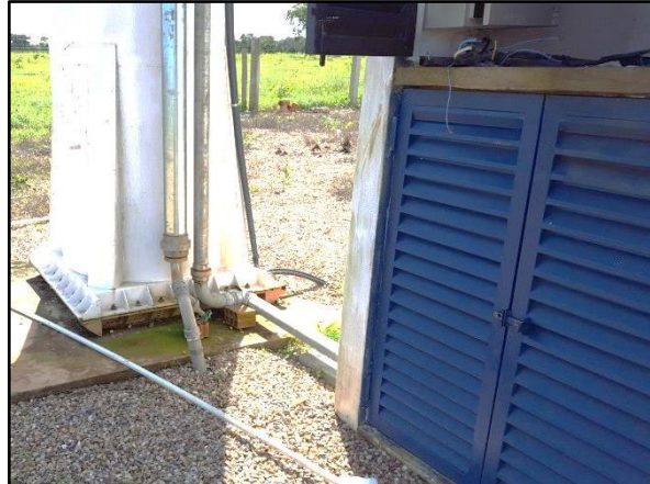
Figura 70. Abrigo do clorador sob o quadro de comando na área do PT-Matrinchã
