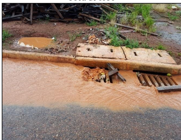
Figura 41. Sarjeta mal executada permitindo a passagem direta da água sem direcionar para boca de lobo
