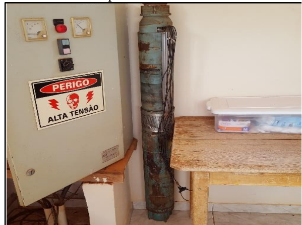
Figura 15. Bomba reserva da marca Leão no depósito do PT-01
