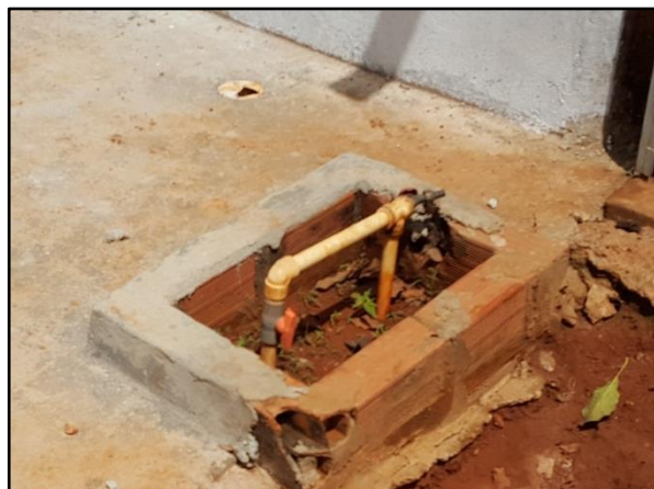
Figura 25. Ligação domiciliar sem hidrômetro na sede urbana de Santo Antônio do Leste
