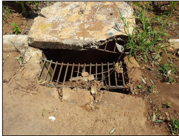
Figura 38. Boca de lobo com tampa e grelha danificada e com interior assoreado, na Av. Mato Grosso no bairro Centro
