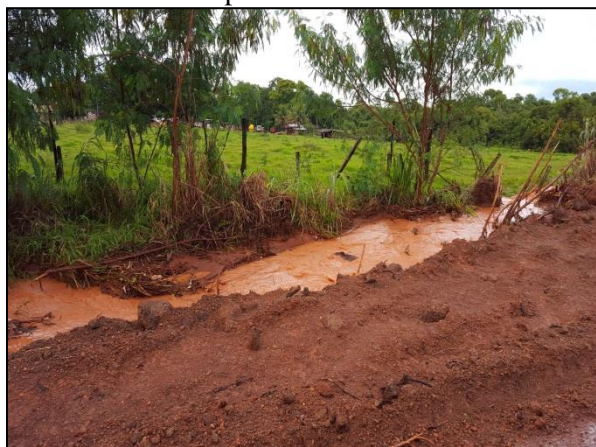
Figura 45. Correnteza de águas pluviais escoando pela erosão formada na margem da via não pavimentada
