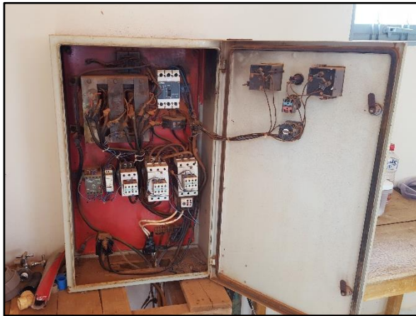
Figura 16. Quadro de comando da bomba submersível e dosador de cloro do PT-01
