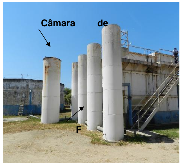
Figura 36– Sistema de tratamento de água –Filtros e câmara de contato
