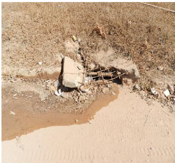
Figura 67 – Boca de lobo quebrada
