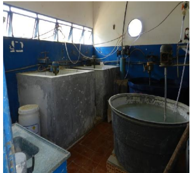
Figura 38- Tanques de mistura produtos químicos
