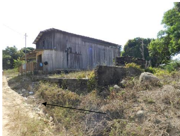
Figura 72 – Início de processos erosivos na lateral da rua Vila Mutum
