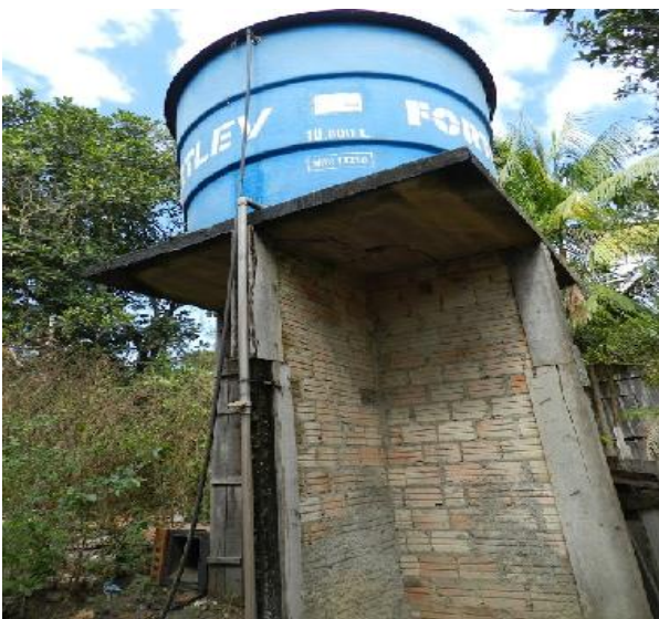
Figura 55 - Reservatório Vila Mutum 10m 3
