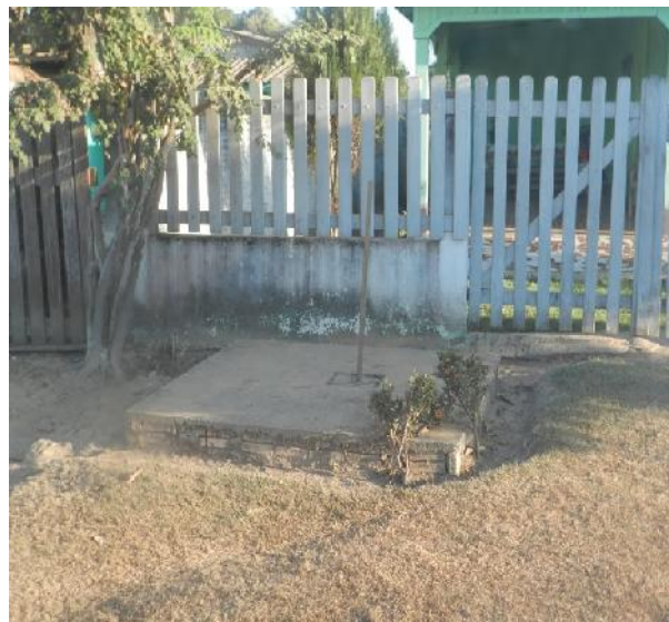
Figura 60– Fossa rudimentar construída na frente do lote
