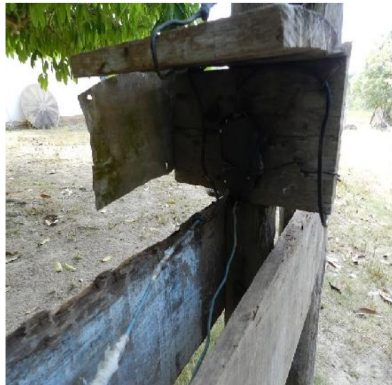
Figura 54 – Instalação elétrica do poço
