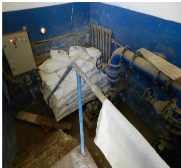
Figura 46– Armazenamento de produto químico
