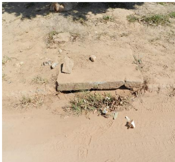
Figura 68 – Boca de lobo abertura quase totalmente fechada
