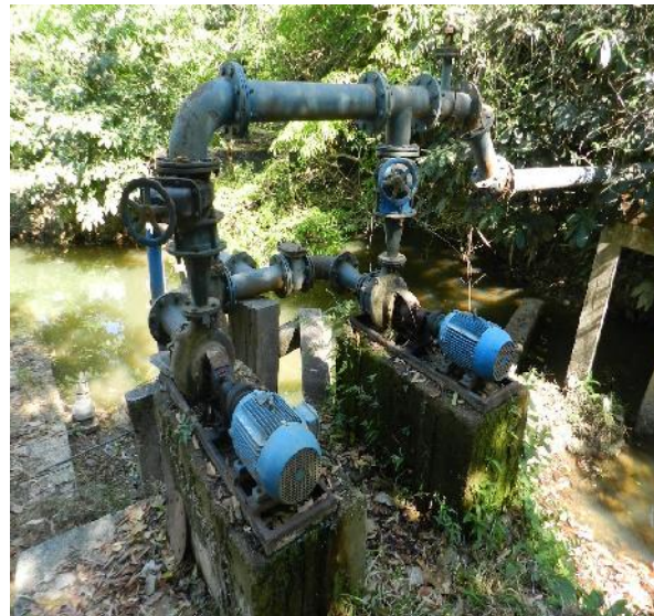
Figura 29- Captação superficial – recalque
