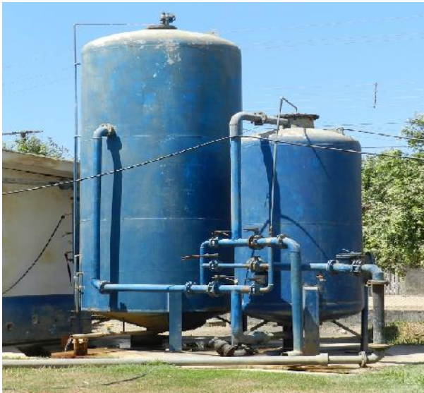
Figura 33– Sistema de tratamento de água - Filtro Russo
