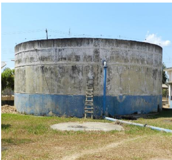
Figura 44– Reservatório de água 400 m³
