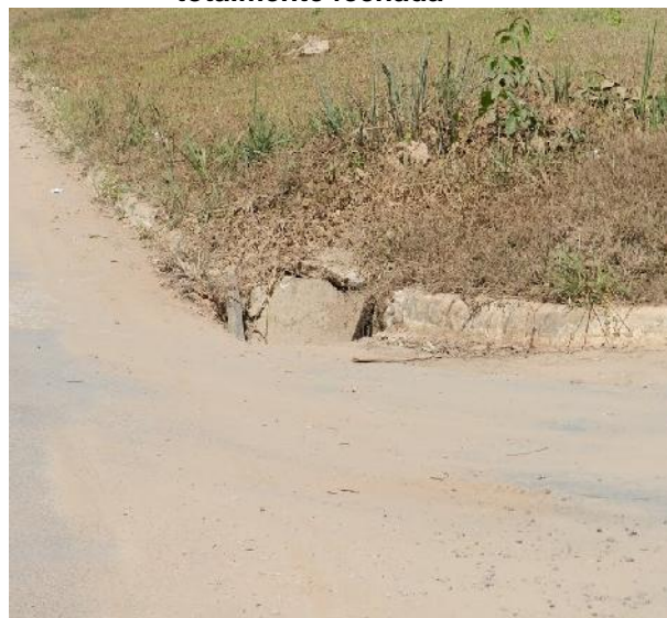
Figura 70 – Tampa quebrada e afundada.
