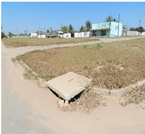
Figura 69 – boca de lobo locada de forma inadequado
