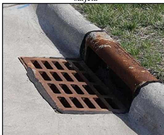
Figura 73. Boca de lobo com gradeamento na sarjeta
