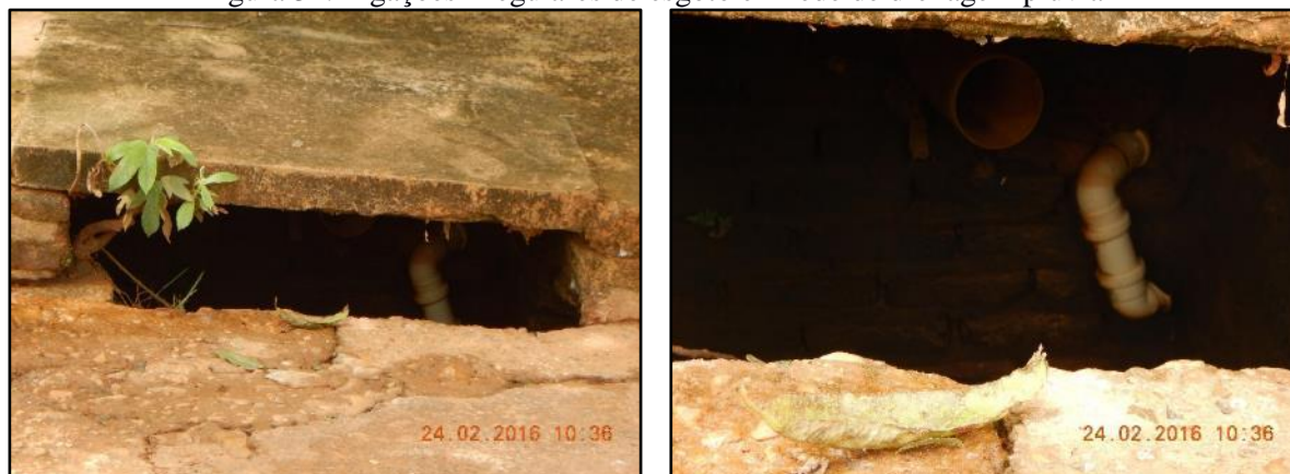
Figura 31. Ligações irregulares de esgoto em rede de drenagem pluvial
