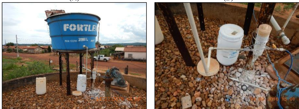
Figura 10. Sistema de cloração (A) e detalhe do clorador de contato (B)
