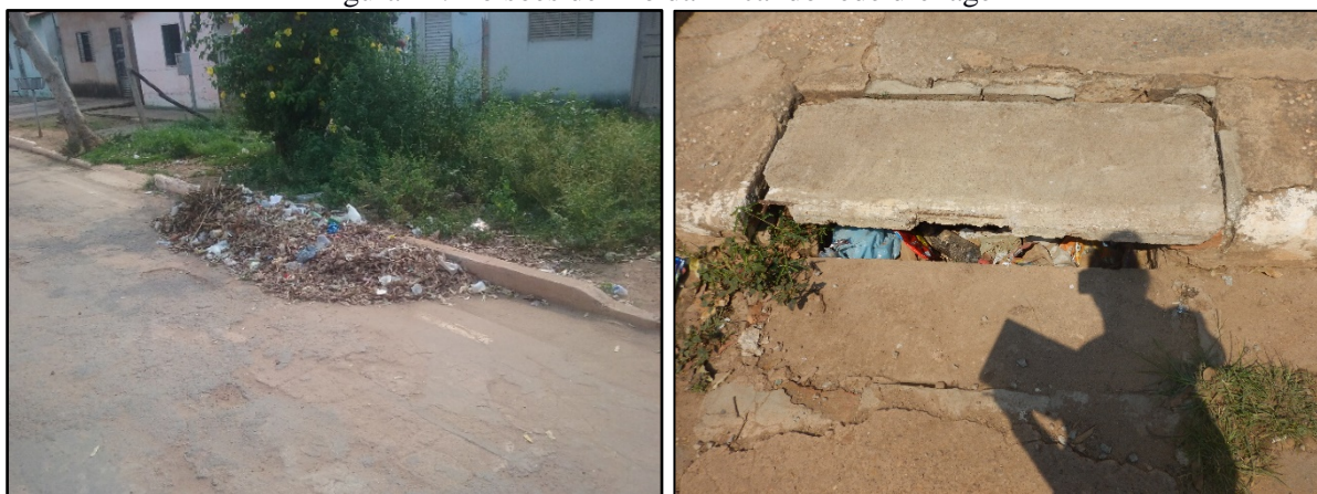
Figura 44. Bolsões de lixo danificando rede drenagem
