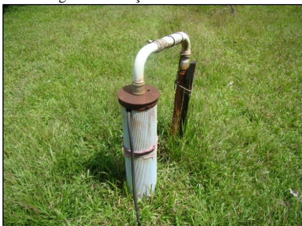
Figura 109. Poço de Porto Brandão
