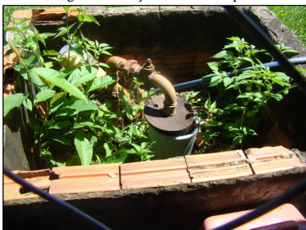
Figura 91. Poço Centro Múltiplo
