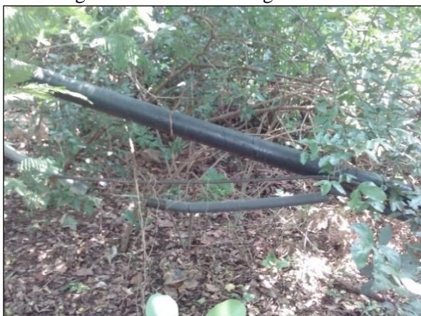
Figura 16. Adutora de Água Bruta
