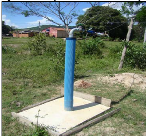
Figura 104. Poço tubular Centro Múltiplo II
