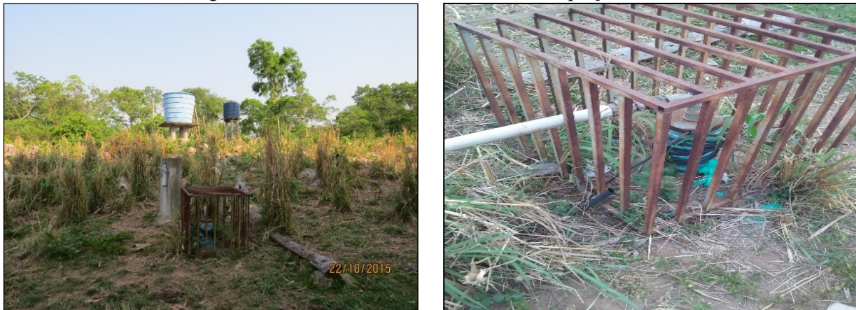
Figura 9. Reservatório elevado e bomba de captação
