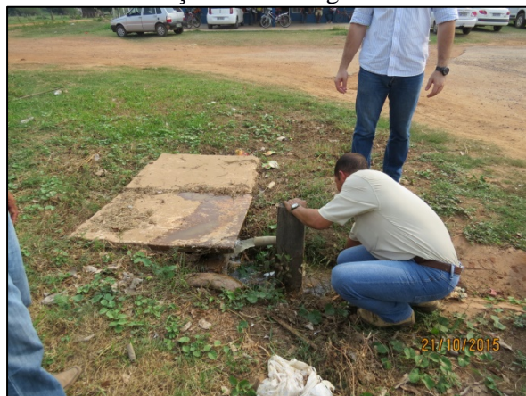
Figura 45. Ponto de lançamento do esgoto na rede de drenagem
