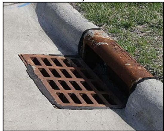
Figura 135. Boca de lobo com gradeamento na sarjeta
