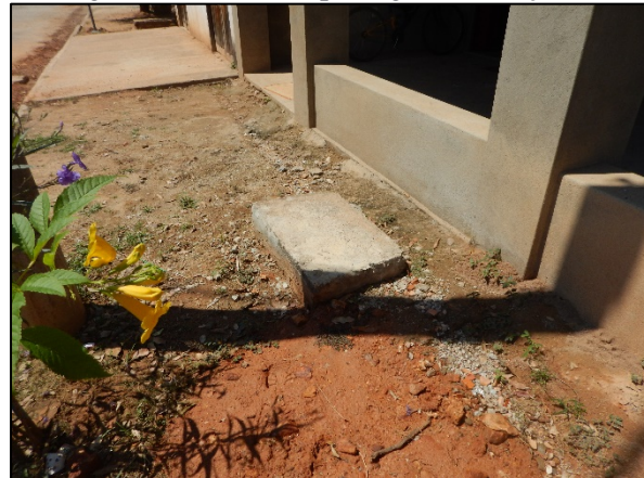
Figura 31. Caixa de passagem na calçada
