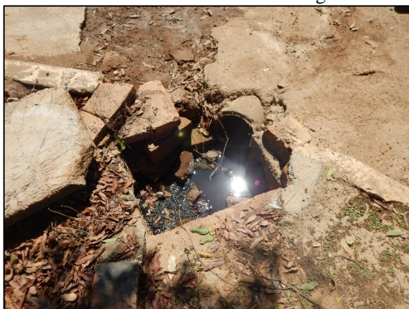
Figura 30. Manilha de concreto da rede coletora de esgoto de Barão de Melgaço
