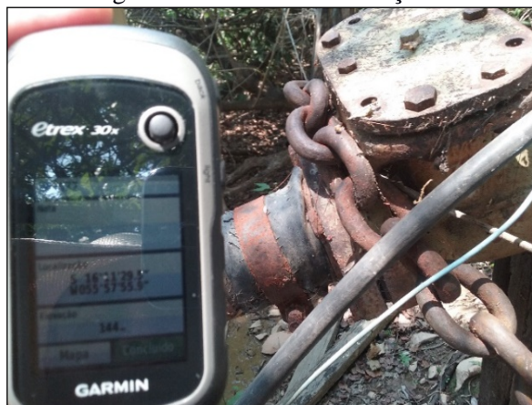
Figura 17. Válvula de Retenção
