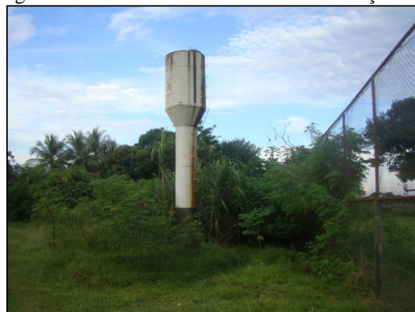
Figura 77. Reservatório metálico de distribuição
