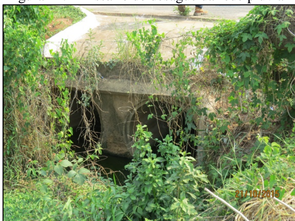
Figura 41. Emissário de desague da rede pluvial
