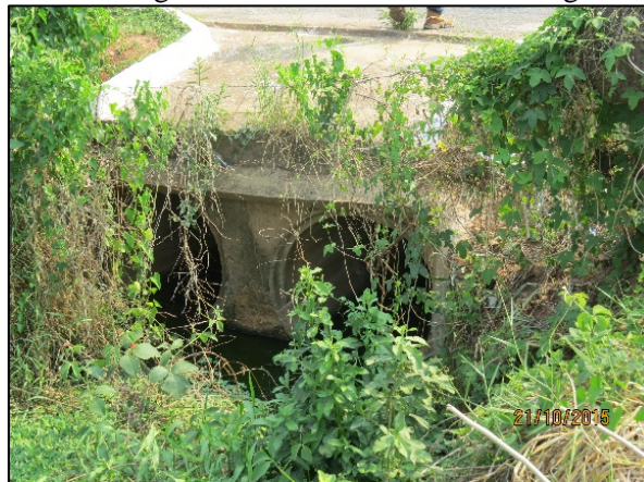
Figura 37. Travessia de drenagem com acúmulo de rede de esgoto – Av. 13 de Março
