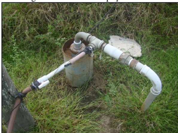
Figura 76. Cavalete do poço tubular
