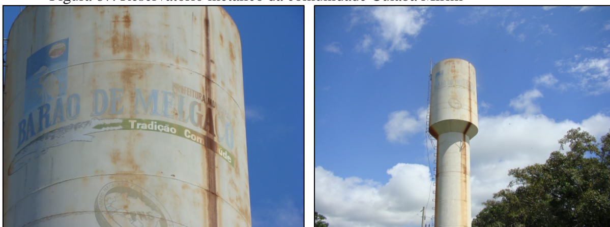
Figura 87. Reservatório metálico da comunidade Cuiabá Mirim
