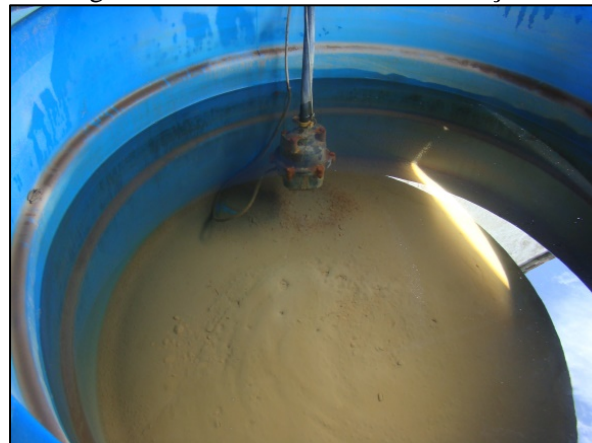
Figura 108. Reservatório de decantação
