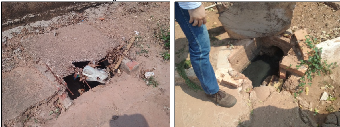
Figura 34. Bocas de lobo danificadas
