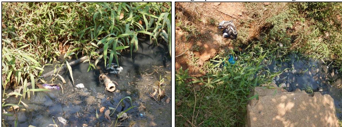
Figura 26. Ponto em que a rede de água passa dentro da vala de esgoto
