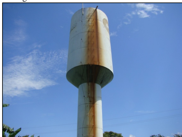
Figura 110. Reservatório de Porto Brandão
