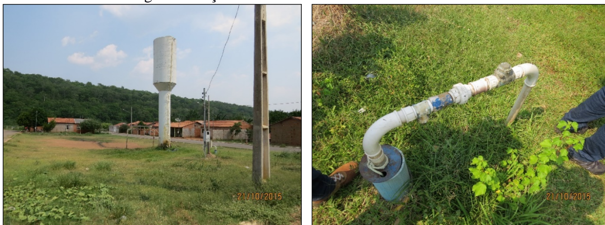
Figura 8. Poço e reservatório Cohab Jardim das Flores
