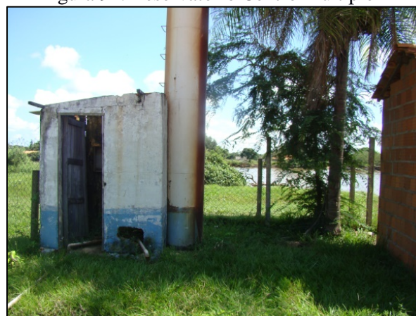
Figura 92. Reservatório Centro Múltiplo
