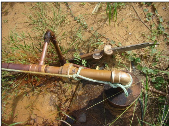
Figura 71. Poço tubular no Distrito São Pedro de Joselândia
