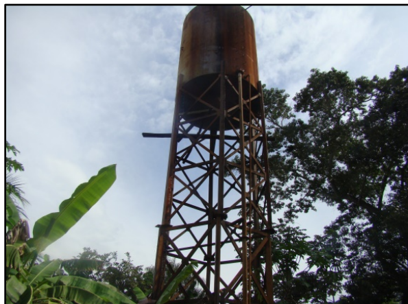
Figura 72. Reservatório metálico de distribuição do Distrito São Pedro de Joselândia
