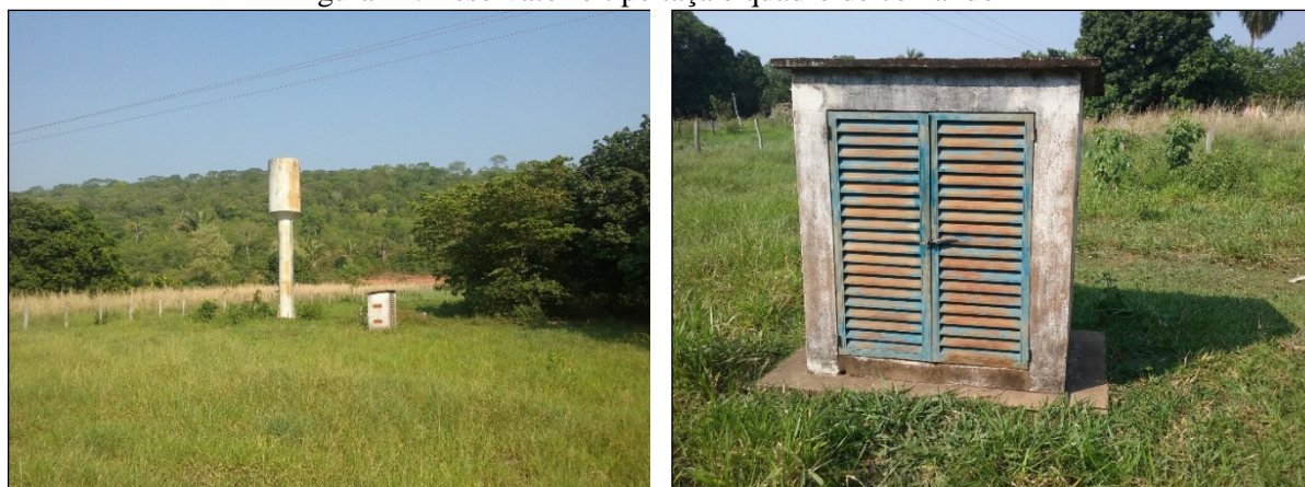
Figura 11. Reservatório tipo taça e quadro de comando
