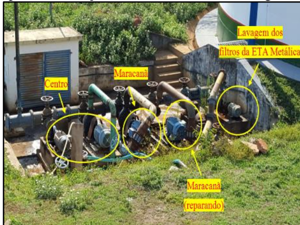
Figura 39. Conjuntos motobombas utilizados para distribuição na cidade de Barra do Bugres
