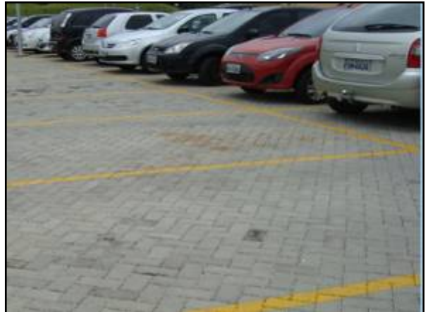
Figura 175. Pavimento poroso instalado em estacionamento
