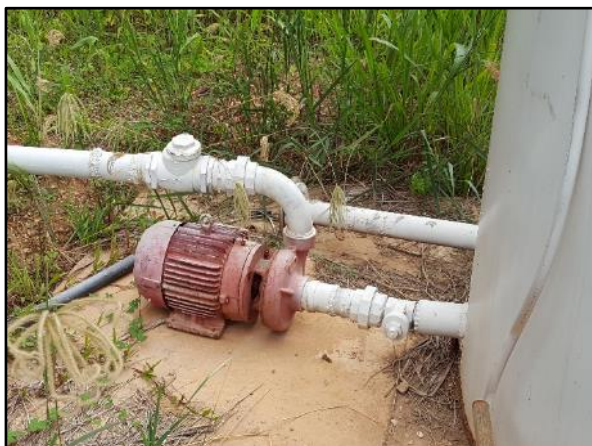
Figura 116. Bomba instalada no tanque de contato para recalque da água tratada para o reservatório
