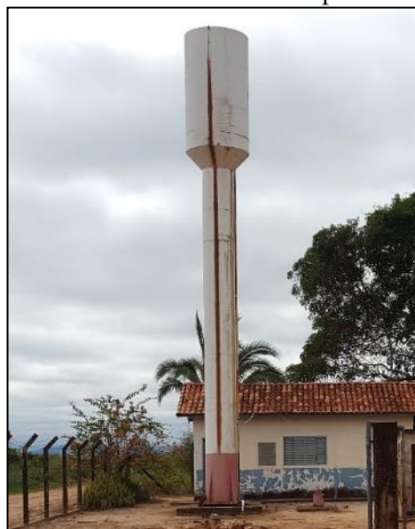
Figura 127. Reservatórios metálicos tipo taça de 12 m 3 de Nova Fernandópolis
