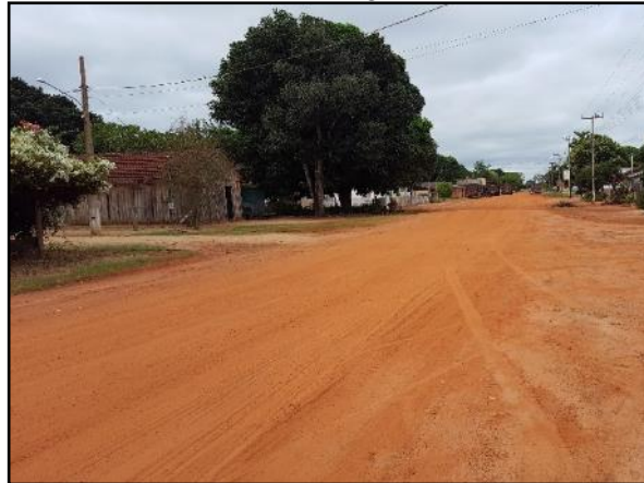
Figura 140. Vias do povoado de Nova Fernandópolis desprovidas de pavimentação e de microdrenagem
