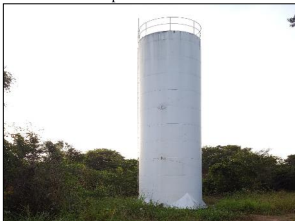
Figura 132. Reservatório metálico apoiado de 100 m 3 do assentamento Campo Verde
