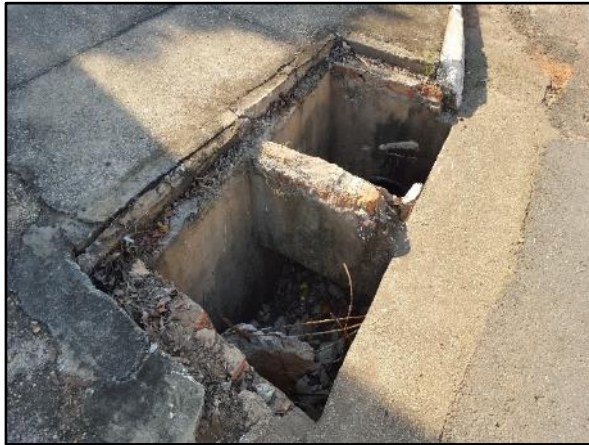
Figura 60. Boca de lobo assoreada na Rua A (7)
