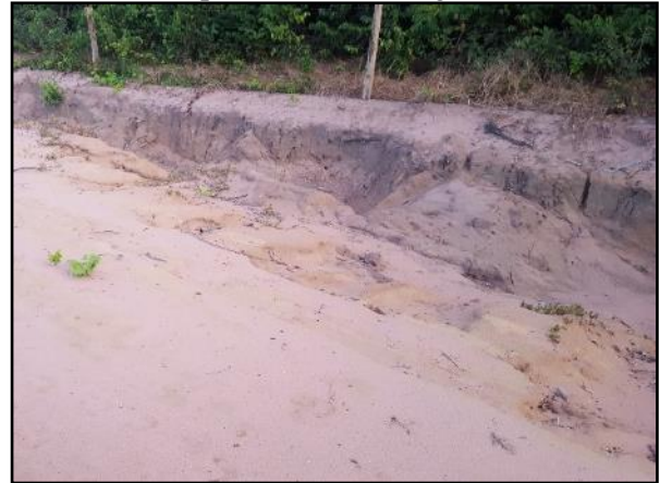
Figura 142. Estrada vicinal de acesso ao assentamento Campo Verde construída sem os dispositivos de drenagem
