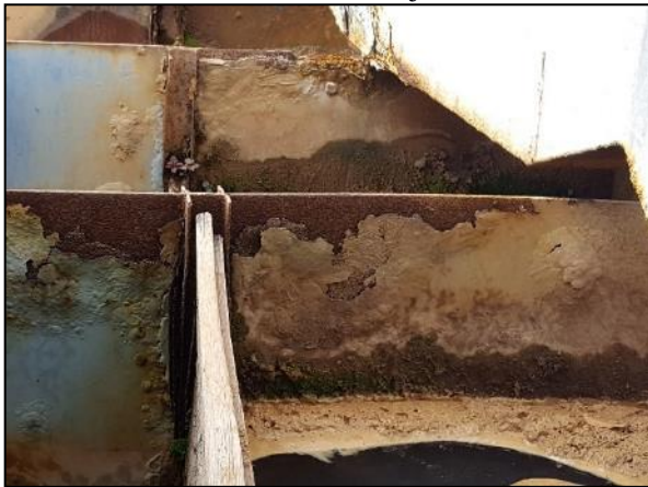
Figura 118. Parede interna do floculador da ETA de Assari enferrujada
