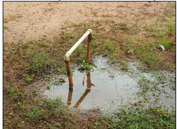
Figura 129. Cavalete sem hidrômetro e com vazamento no povoado de Nova Fernandópolis
