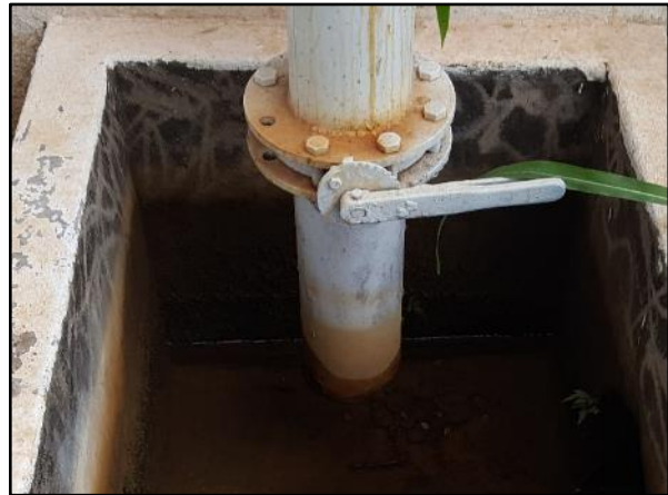
Figura 119. Registro para limpeza do decantador danificado (não abre)
