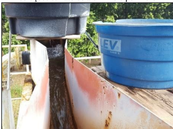
Figura 113. Caixas d'água utilizadas sobre as unidades da ETA utilizadas para o preparo das soluções sulfato de alumínio e polímetro
