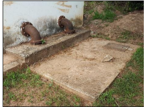
Figura 109. Poço de sucção para tomada indireta da água bruta do rio Bracinho
