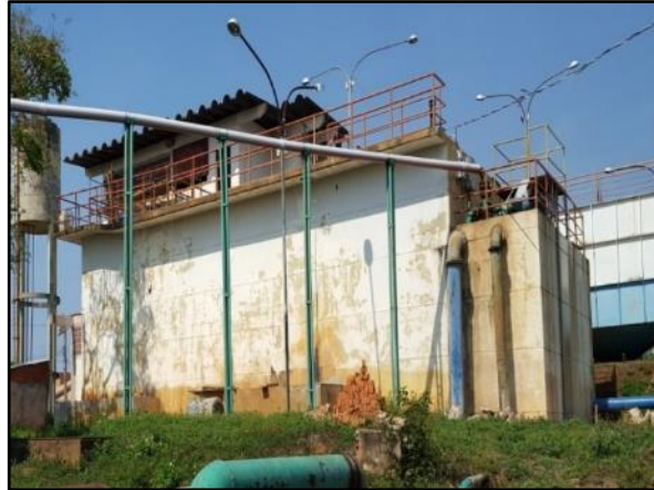
Figura 19. ETA de concreto com capacidade para tratar 50 L/s
