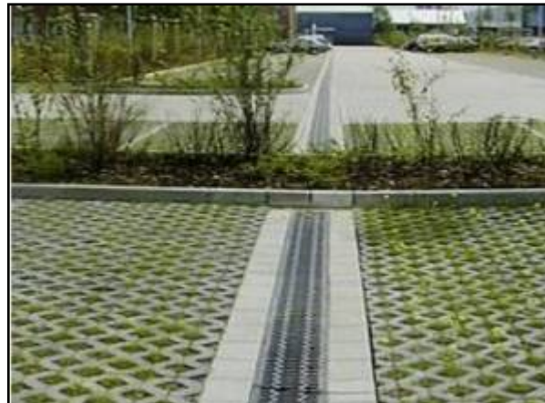
Figura 177. Trincheira de infiltração no estacionamento
