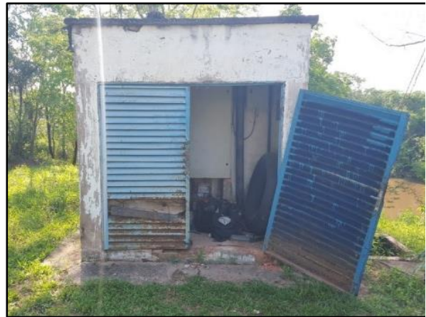
Figura 17. Porta do abrigo do quadro de comando deteriorada
