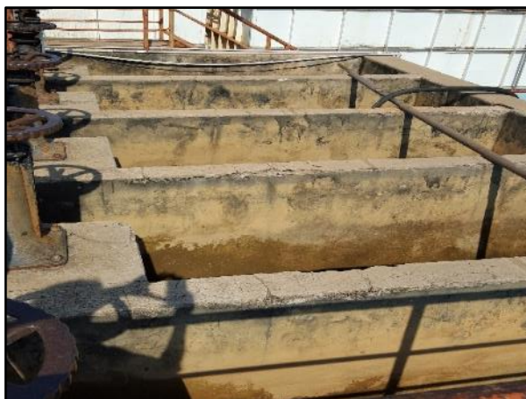
Figura 29. Filtros de múltiplas camadas com fluxo descendentes da ETA de concreto
