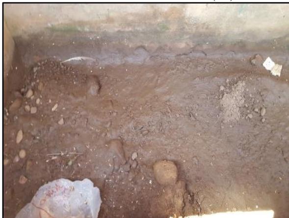
Figura 62. Boca de lobo assoreada na Avenida Marechal Cândido Rondon (12)
