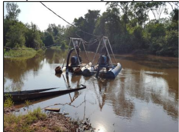
Figura 12. Captação no rio Bugres desprovida de rampa de acesso, balsa e grade de proteção.
