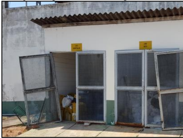
Figura 92. Abrigo para acondicionamento temporário dos resíduos de serviços de saúde do Hospital Regional Roosevelt Figueiredo Lira
