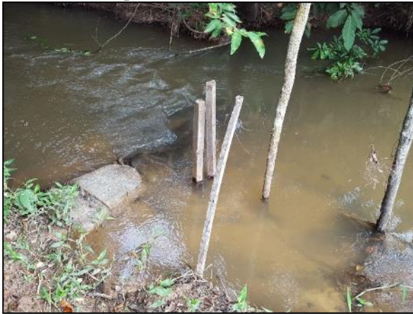
Figura 108. Tubulação de tomada d'água no rio Bracinho para abastecimento de Assari
