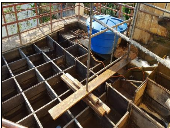
Figura 25. Floculador hidráulico de fluxo vertical com chicanas de madeira da ETA de concreto
