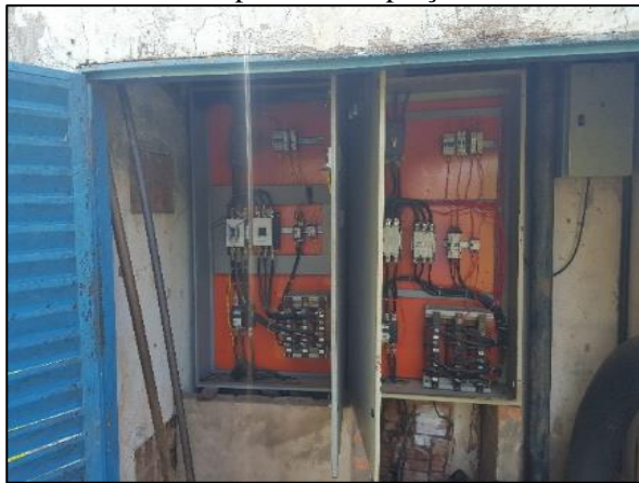
Figura 16. Quadro de comando protegido de intempéries da captação
