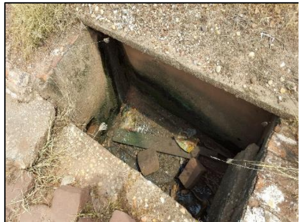
Figura 63. Boca de lobo sem tampa e com resíduos na Rua Voluntários da Pátria
