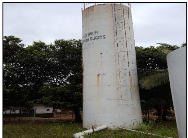
Figura 117. Reservatório localizada na área da ETA de Assari com capacidade para armazenar 120 m 3
