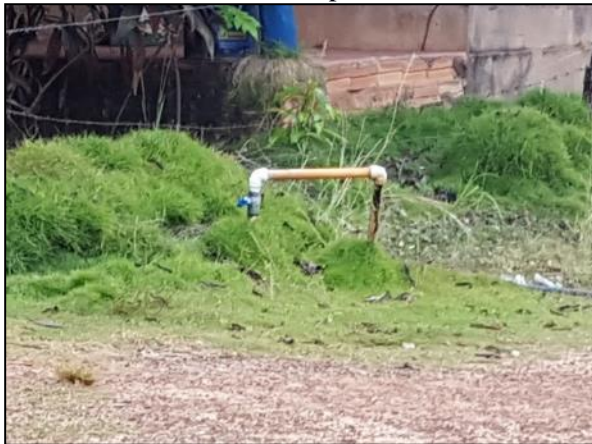
Figura 128. Cavalete sem hidrômetro no povoado de Currupira
