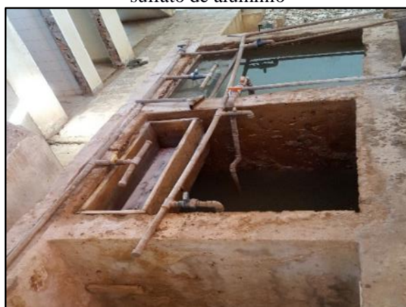
Figura 32. Tanque de preparo da solução de sulfato de alumínio
