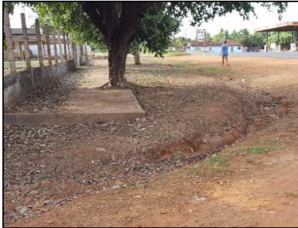
Figura 141. Erosão na margem da Av. Mal Rondon no distrito de Assari
