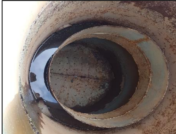
Figura 115. Filtro da ETA de Assari inoperante devido a problemas estruturais
