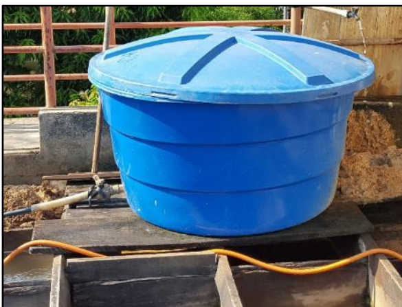
Figura 35. Reservatório para preparo do polímero localizado sobre o floculador da ETA de concreto
