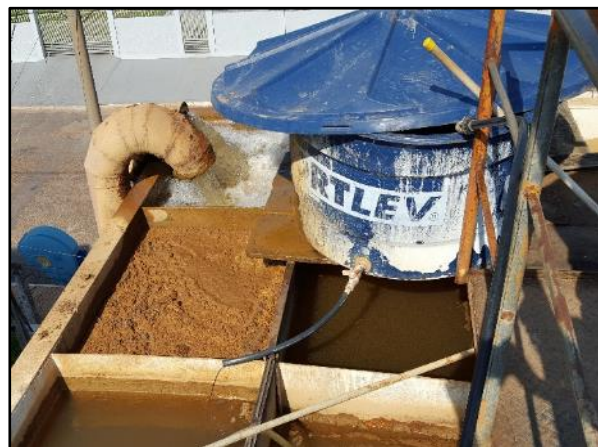
Figura 36. Tanque de preparo da solução de polímero localizado sobre o floculador da ETA metálica
