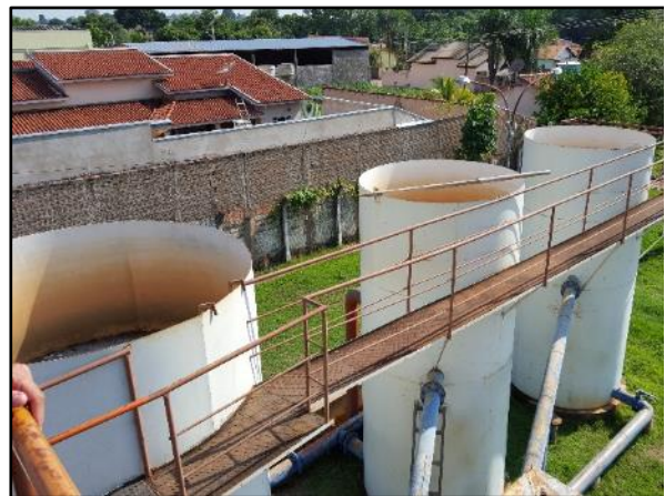
Figura 30. Filtros de múltiplas camadas com fluxo descendentes da ETA metálica
