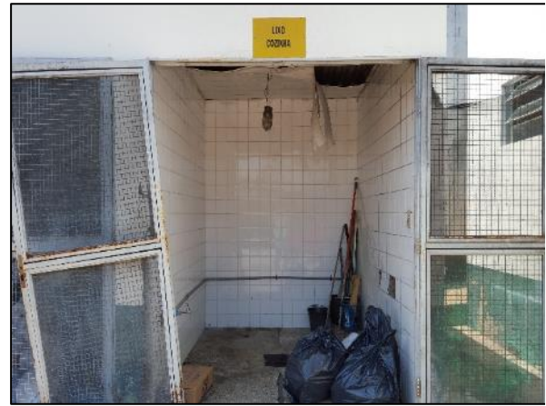
Figura 93. Acondicionamento do lixo comum no Hospital Regional Roosevelt Figueiredo Lira
