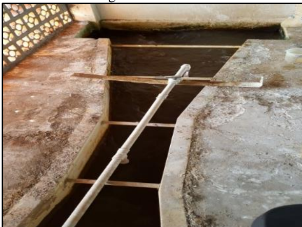
Figura 20. Aplicação da solução de sulfato de alumínio na água bruta na calha Parshall
