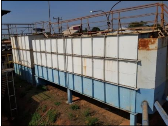
Figura 18. ETA metálica com capacidade para tratar 32 L/s
