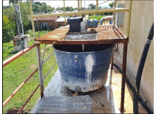
Figura 34. Reservatório de preparo da solução de cloro localizado sobre a câmara de contato
