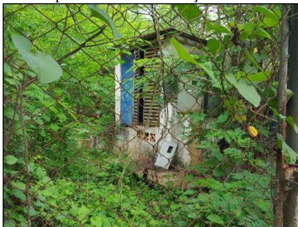
Figura 47. Estação elevatória de esgoto inoperante e sem manutenção na área
