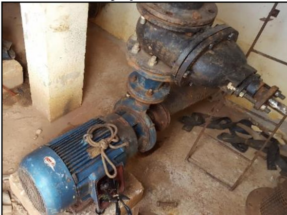
Figura 110. Conjunto motobomba em operação na captação de Assari
