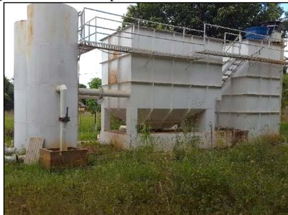
Figura 112. ETA compacta metálica no distrito de Assari
