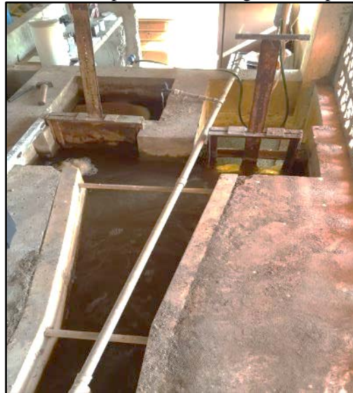
Figura 22. Comportas instaladas a jusante da calha Parshall ocasionando o represamento da água no dispositivo
