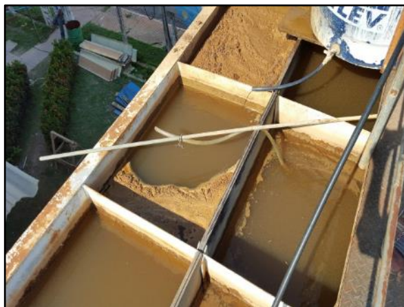
Figura 26. Floculador hidráulico de fluxo vertical com chicanas de madeira da ETA metálica
