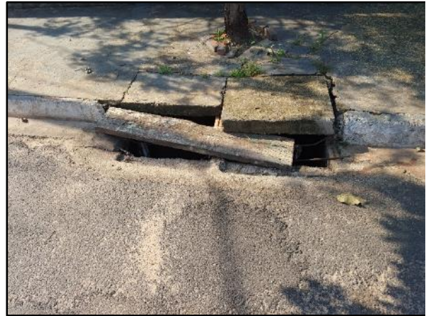
Figura 61. Boca de lobo com tampa danificada na Rua 1 (14)
