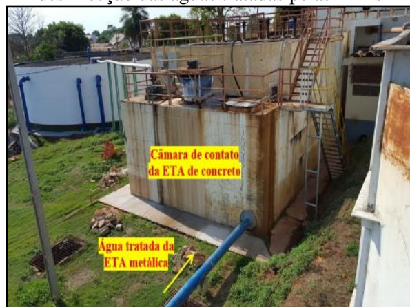
Figura 31. Câmara de contato da ETA de concreto para desinfecção das águas tratadas pelas ETAs
