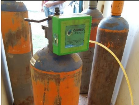
Figura 33. Dispositivos de dosagem de cloro instalado em um cilindro com gás de cloro
