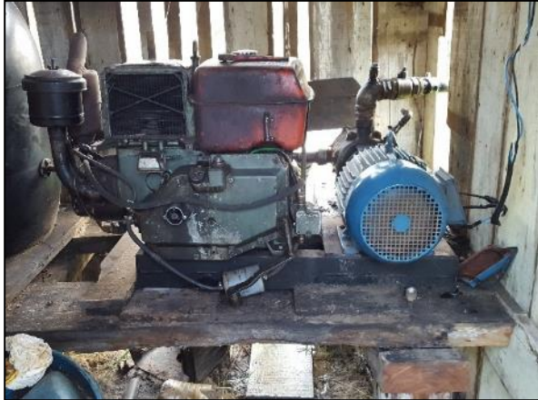
Figura 130. Conjunto motobomba e gerador de energia a diesel da captação do assentamento de Campo Verde
