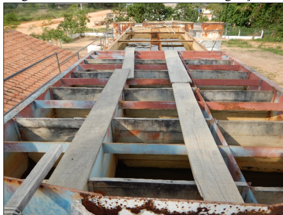
Figura 10. Floculador, da ETA, Cotriguaçu-MT
