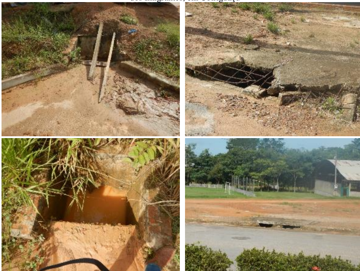
Figura 23. Vista dos dispositivos da microdrenagem urbana com ausência de manutenção, na Avenida dos Imigrantes, em Cotriguaçu
