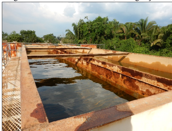
Figura 11. Decantador da ETA, Cotriguaçu-MT
