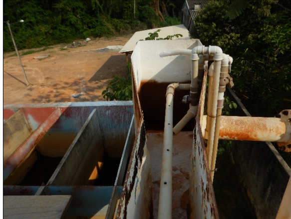
Figura 9. Vista da calha Parshall ETA metálica
