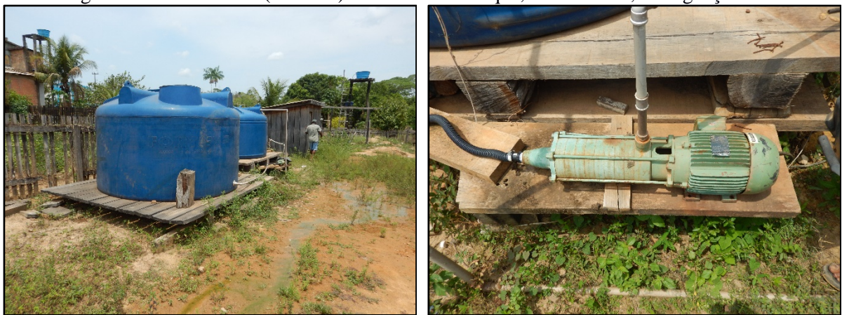
Figura 38. Reservatório (R1 e R2) e bomba de recalque, Nova União, Cotriguaçu-MT
