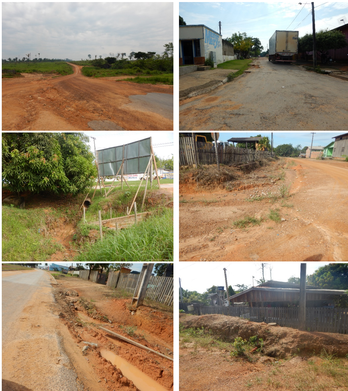
Figura 25. Processo erosivo na Av. Tamburelo (A), Rua Íris Bambila com a estrutura da pavimentação danificada pela velocidade da água pluvial (B), erosão no final da rede de drenagem na Av. 20 de Dezembro sem dissipador de energia (C), erosão na Rua Otilis Lago (D) e Av. 20 de Dezembro (E), canaleta em solo natural Rua Paralela com a Via H43 (F)
