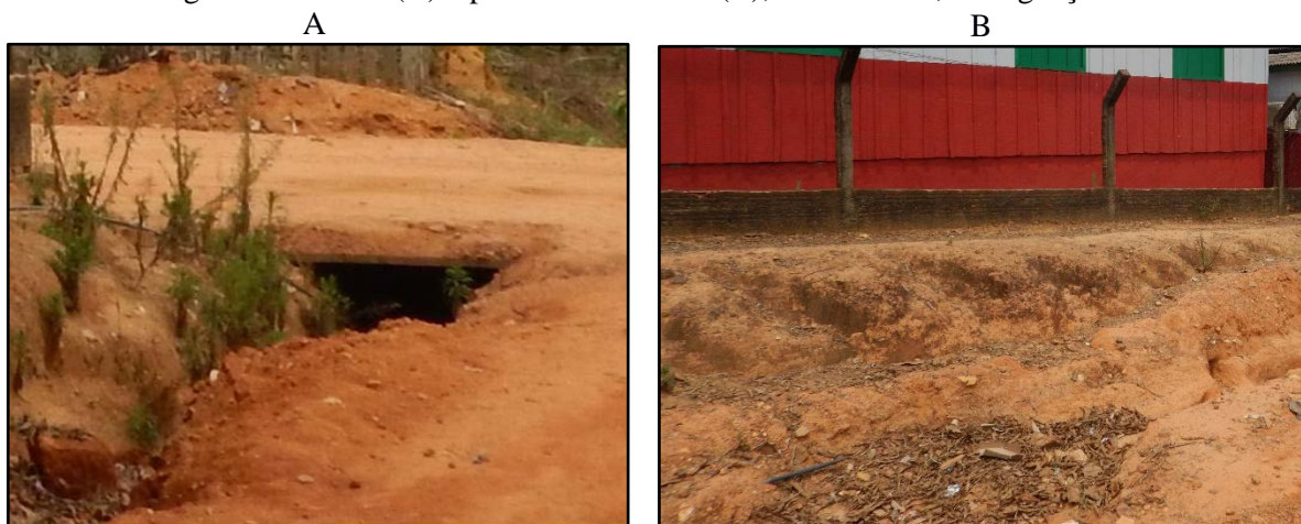
Figura 43. Bueiro (A) e processos erosivos (B), Nova União, Cotriguaçu-MT
