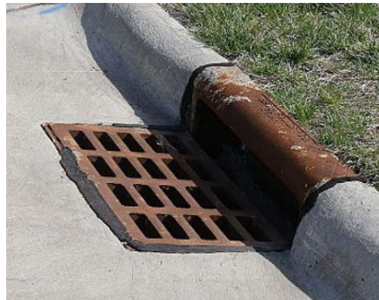
Figura 64. Boca de lobo com gradeamento na sarjeta
