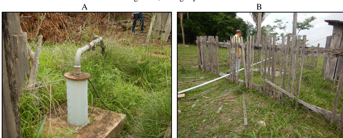
Figura 47. Poço tubular próximo ao PSF (A), Poço tubular instalado em chácara anexa à BR-170, Agrovila, Cotriguaçu-MT
