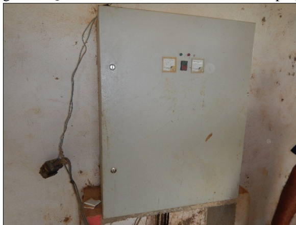
Figura 7. Quadro de comando do sistema de Captação
