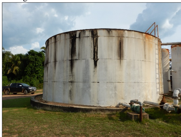
Figura 15. Reservatório cilíndrico metálico
