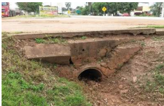
Figura 169 -Bueiro de canteiro lateral com necessidade de reparos Foto:Rafael Pedrollo de Paes (2014)
