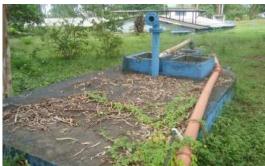
Figura 56 -Recalque de esgoto tratado no Bairro Cohab Nova Foto: Aldecy de Almeida Santos (2014)
