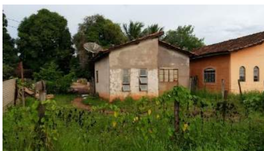
Figura 154 -Infiltração ascendendo à construção predial Foto: Rafael Pedrollo de Paes (2014)
