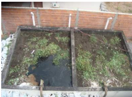
Figura 78 -Leito de secagem de lodo Foto: Aldecy de Almeida Santos (2014)
