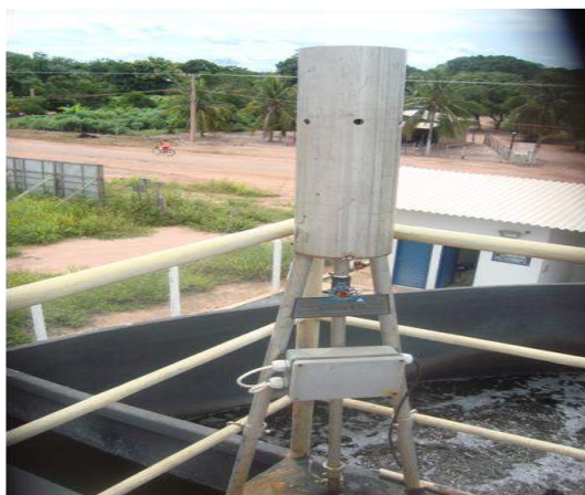
Figura 80 -Queimador de Biogás com defeito Foto: Aldecy de Almeida Santos (2014)
