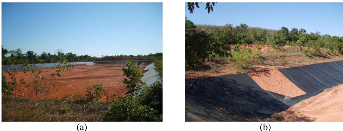
(a) (b) Figura 113 -Obra inacabada do Aterro Sanitário de Cáceres/MT onde pode ser observada a manta de impermeabilização destruída Foto: Tadeu Latorraca (2014)
