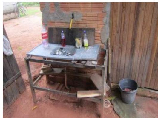
Figura 46 -Instalações hidrossanitárias inadequadas na área rural. Vila Aparecida Foto: Aldecy de Almeida Santos (2014)
