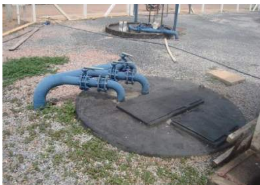
Figura 84 -Estação elevatória de efluente final Foto: Aldecy de Almeida Santos (2014)
