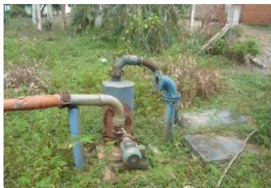
Figura 52 -Estação Elevatória na área da ETE Cohab Nova Foto: Aldecy de Almeida Santos (2014)
