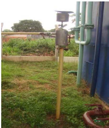
Figura 64 -Queimador de Biogás Foto: Aldecy de Almeida Santos (2014)
