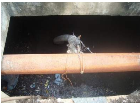
Figura 54 -Vazamento entre a tubulação de ar e mangueira flexível no Bairro Cohab Nova
