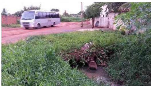
Figura 150 -Bueiro duplo tubular de concreto com acúmulo de resíduos Foto: Rafael Pedrollo de Paes (2014)
