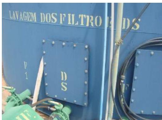
Figura 75 -Local da lavagem dos filtros e DS Foto: Aldecy de Almeida Santos (2014)
