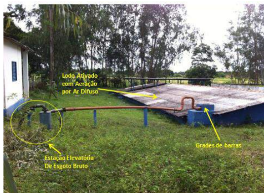
Figura 50 -Estação de Tratamento de Esgoto Cohab Nova Foto: Aldecy de Almeida Santos (2014)
