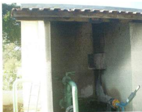
Figura 59 -Estação de Tratamento Guanabara Foto: Nortec (2013)
