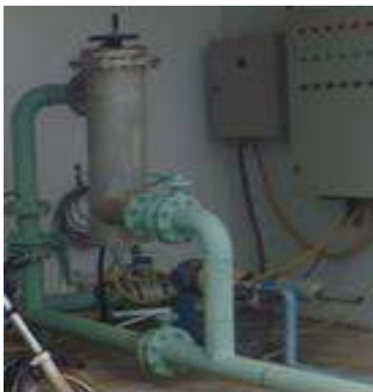
Figura 82 -Sistema de desinfecção por UV Foto: Aldecy de Almeida Santos (2014)
