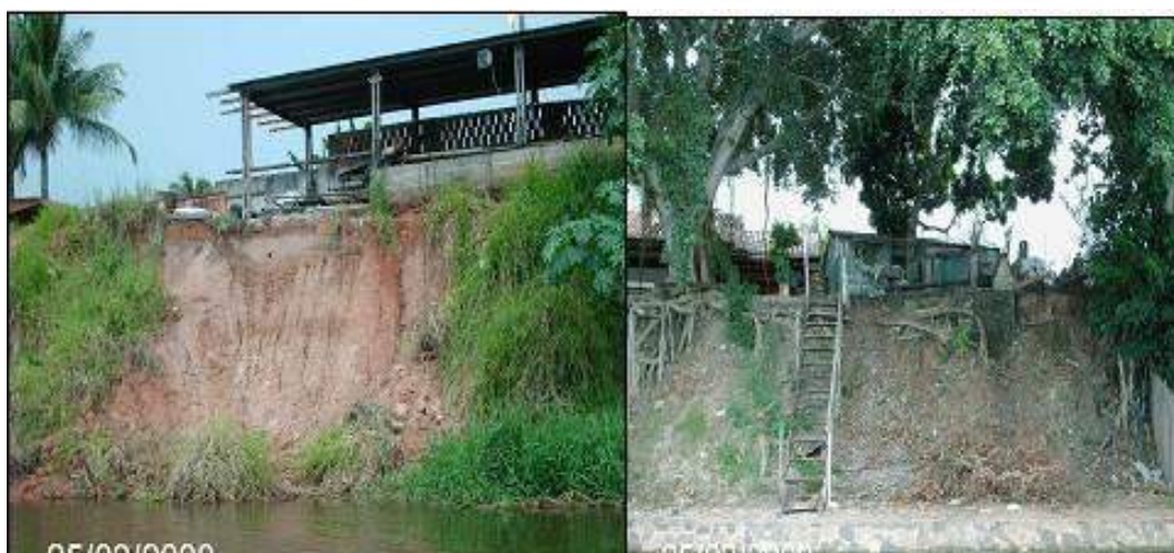
Figura 159 -Erosão marginal ao rio Paraguai, próximo ao bairro São Miguel Fonte: Barbosa et al (2011)
