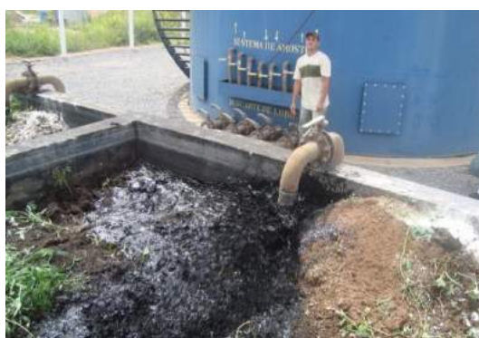
Figura 77 -Descarte de lodo do reator UASB Foto: Aldecy de Almeida Santos (2014)
