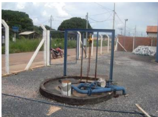
Figura 71 -Estação elevatória de recalque de esgoto bruto Foto: Aldecy de Almeida Santos (2014)
