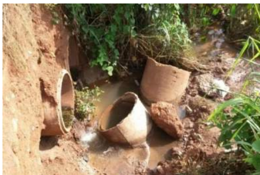
Figura 43 -Galeria de água pluvial danificada e com presença de esgoto no Córrego Sangradouro Foto: Aldecy de Almeida Santos (2014)
