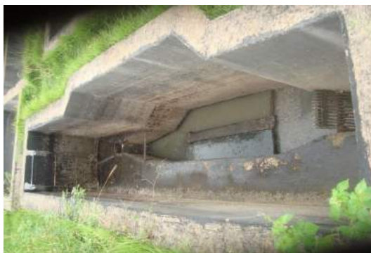
Figura 61 -Grade, caixa de areia e Calha Parshall
