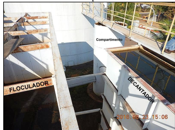
Figura 17. Compartimento que recebe a água floculada e distribui para o decantador
