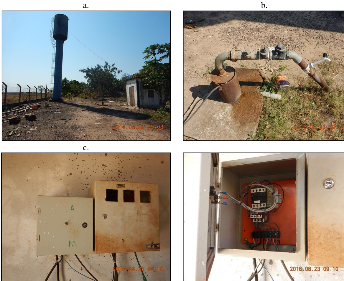
Figura 112. Vista da área de captação do PT-02 e estrutura do REL-02(a); estrutura do poço (b) e quadro de comando da bomba (c), em Culuene, Canarana-MT
