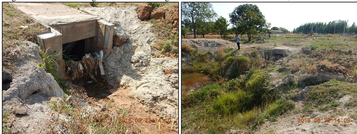
Figura 62. Ponto de deságue da rede de drenagem localizado na Avenida Paraná, em Canarana-MT
