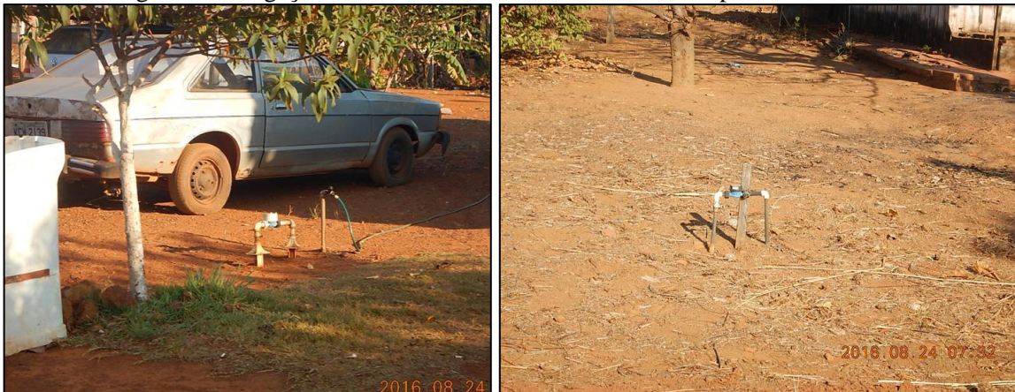
Figura 123. Ligações domiciliares hidrometradas em Garapu, Canarana-MT
