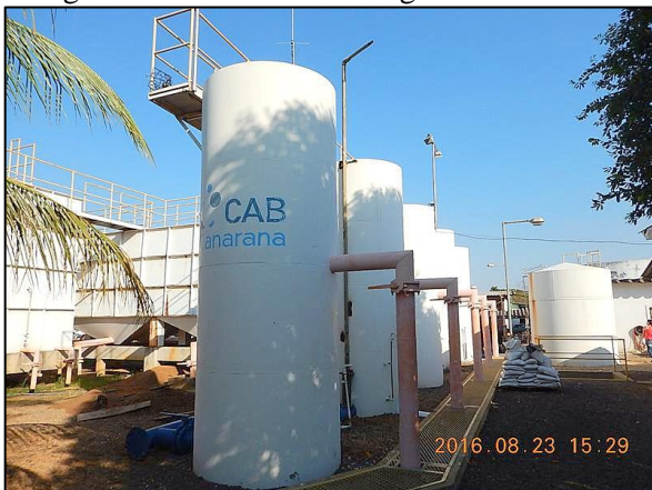
Figura 20. Tubulações que conduzem a água de lavagem dos filtros da ETA à galeria subterrânea
