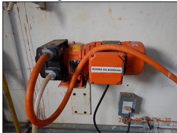
Figura 27. Bomba dosadora da cal hidratada, na sala de dosagem da ETA de Canarana-MT
