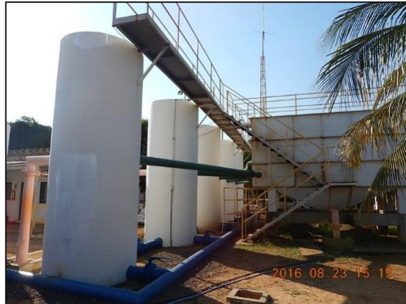
Figura 19. Unidades de filtração rápida da ETA de Canarana-MT
