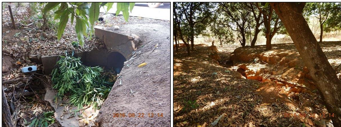
Figura 63. Ponto de deságue da rede de drenagem localizado na Avenida Mato Grosso, bairro Centro, em Canarana-MT
