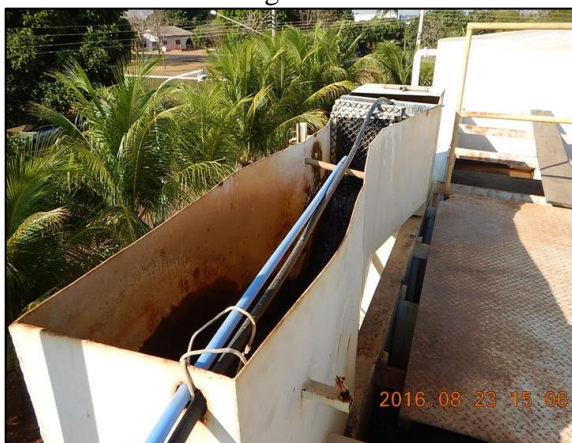
Figura 14. Calha Parshall da Estação de Tratamento de Água de Canarana-MT
