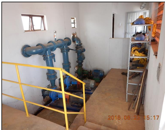
Figura 35. Vista interior da casa de bombas da ETA de Canarana-MT
