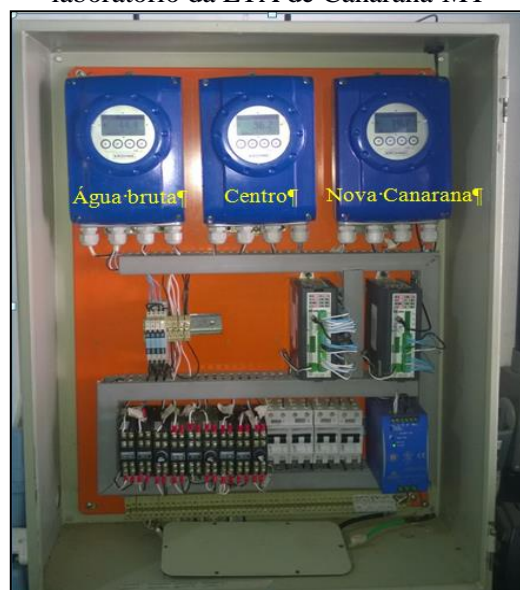
Figura 39. Quadro dos conversores dos macromedidores de água bruta e água tratada instalados no laboratório da ETA de Canarana-MT
