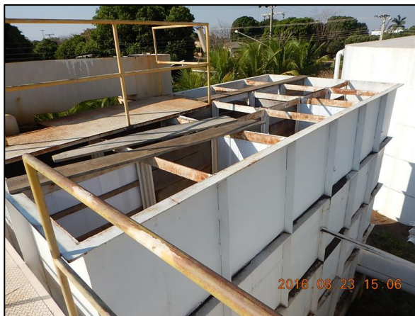
Figura 16. Floculador hidráulico da ETA de Canarana-MT
