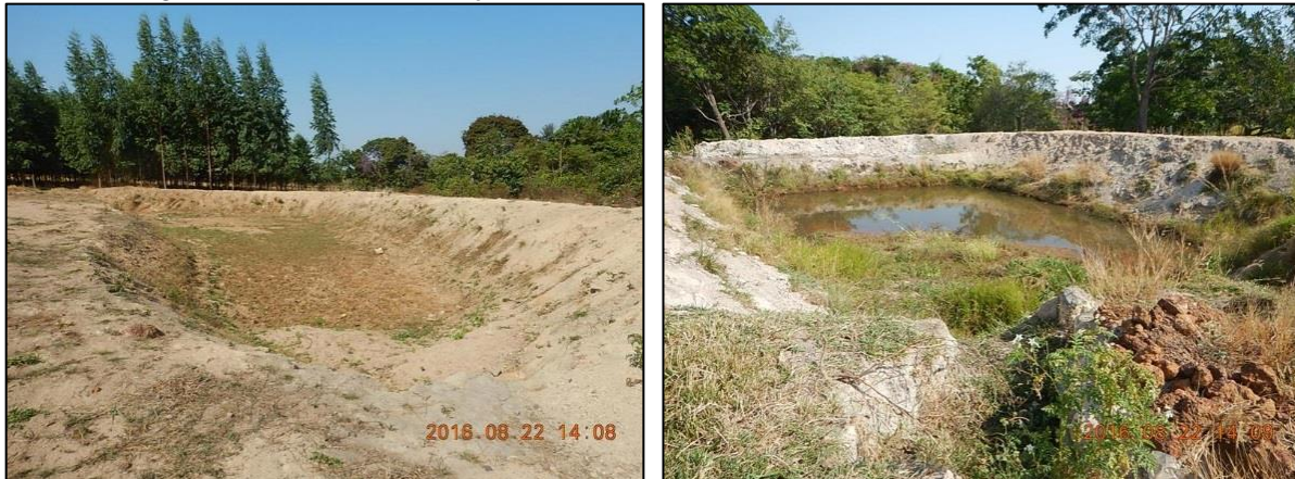
Figura 57. Bacias de detenção localizadas na Avenida Paraná, em Canarana-MT
