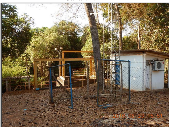
Figura 12. Área da captação de água bruta de Canarana-MT
