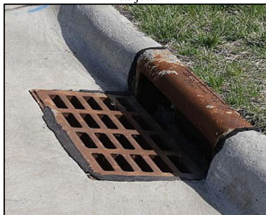
Figura 157. Boca de lobo com gradeamento na sarjeta
