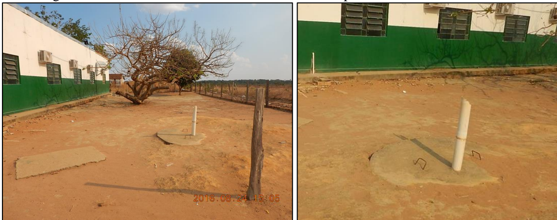
Figura 132. Visão externa da fossa da escola municipal de Matinha, Canarana-MT
