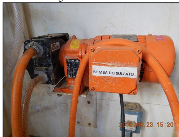
Figura 15. Bomba dosadora de coagulante, na sala de dosagem da ETA de Canarana-MT
