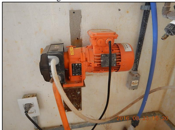
Figura 25. Bomba dosadora de fluorsilicato, na sala de dosagem da ETA de Canarana-MT
