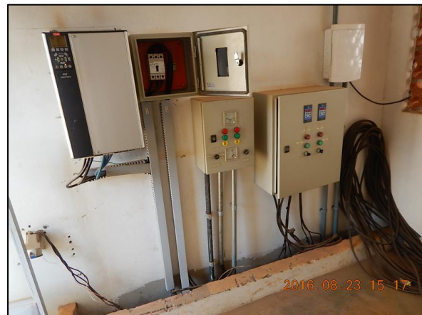
Figura 36. Quadro de comando das bombas localizados na casa de bombas da ETA
