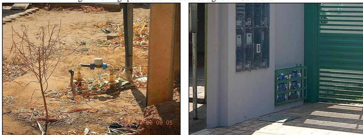
Figura 40. Ligações hidrometradas de água em Canarana-MT
