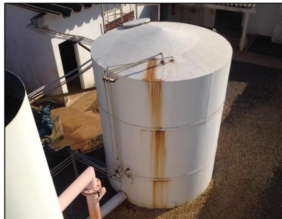
Figura 21. Tanque de contato da ETA de Canarana-MT
