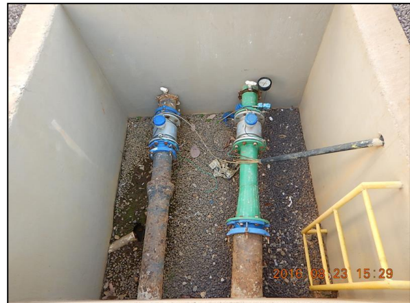
Figura 38. Macromedidores de água tratada localizados na ETA de Canarana-MT
