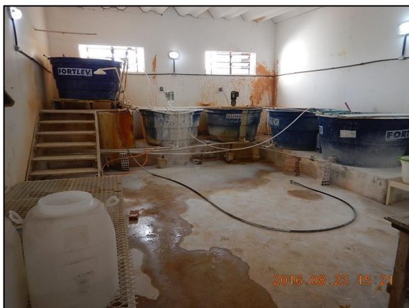
Figura 28. Sala de preparo das soluções químicas da ETA de Canarana-MT
