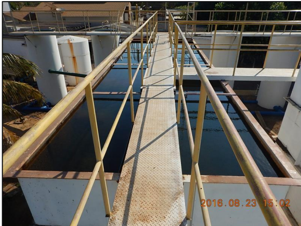
Figura 18. Decantador localizado na ETA de Canarana-MT
