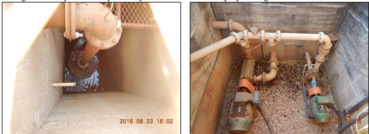
Figura 13. Poço de derivação e conjunto motobomba da captação de água bruta de Canarana-MT
