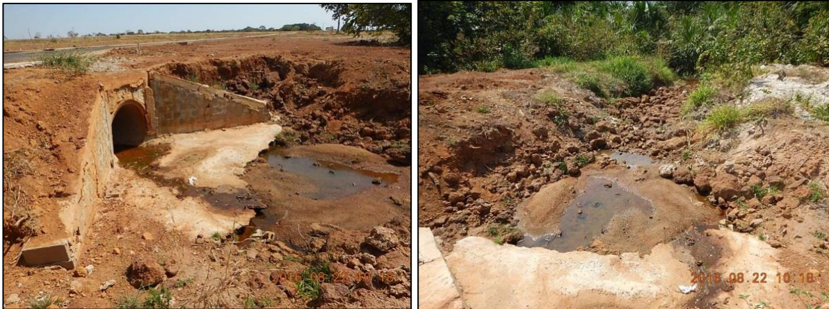
Figura 64. Ponto de deságue da rede de drenagem localizado em loteamento novo no Parque Flamboyant, em Canarana-MT
