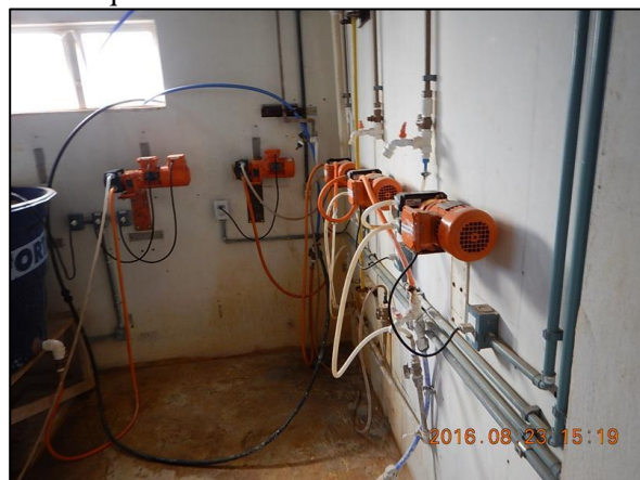
Figura 29. Sala de dosagem de produtos químicos da ETA de Canarana-MT
