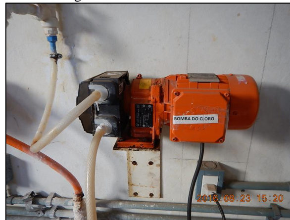
Figura 23. Bomba dosadora de cloro, na sala de dosagem da ETA de Canarana-MT
