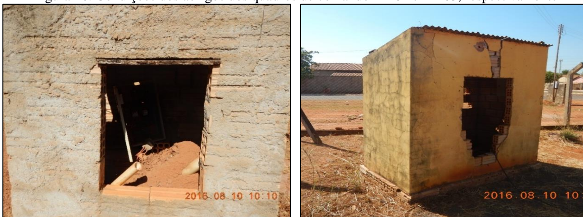
Figura 16. Condições dos abrigos dos quadros de comando PT-04 e PT-03, respectivamente
