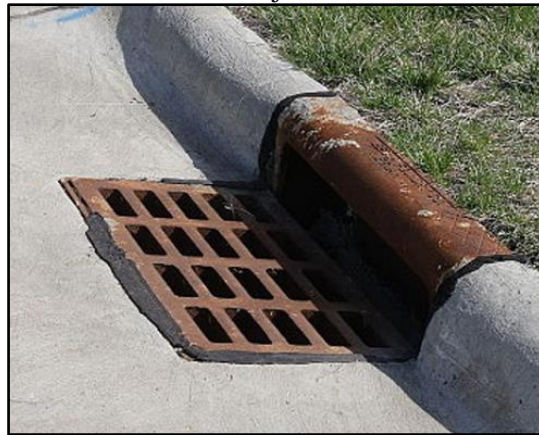
Figura 78. Boca de lobo com gradeamento na sarjeta
