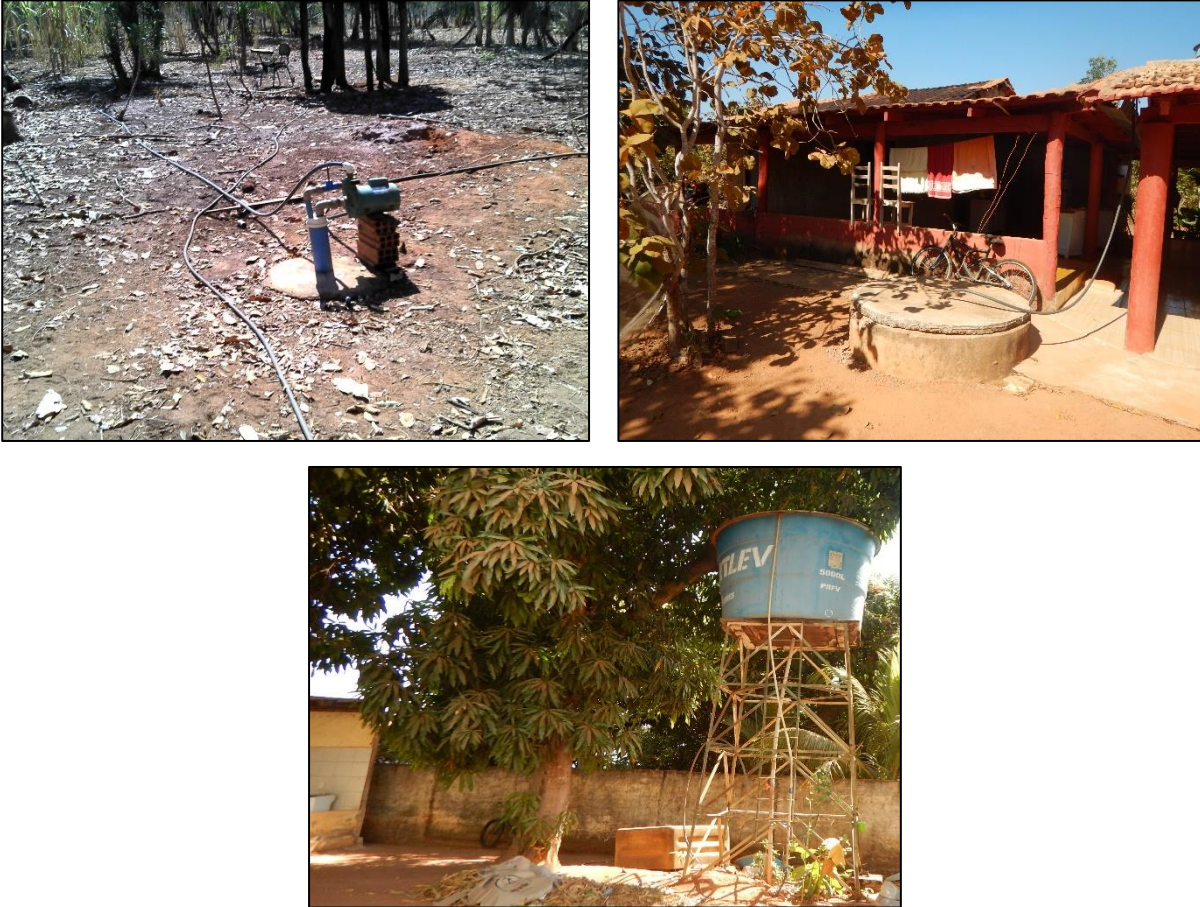
Figura 48. Captações individuais de água e reservação na comunidade rural de Cocalinho
