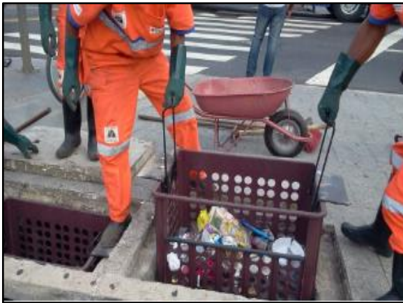
Figura 77. Cesta acoplada à boca do bueiro
