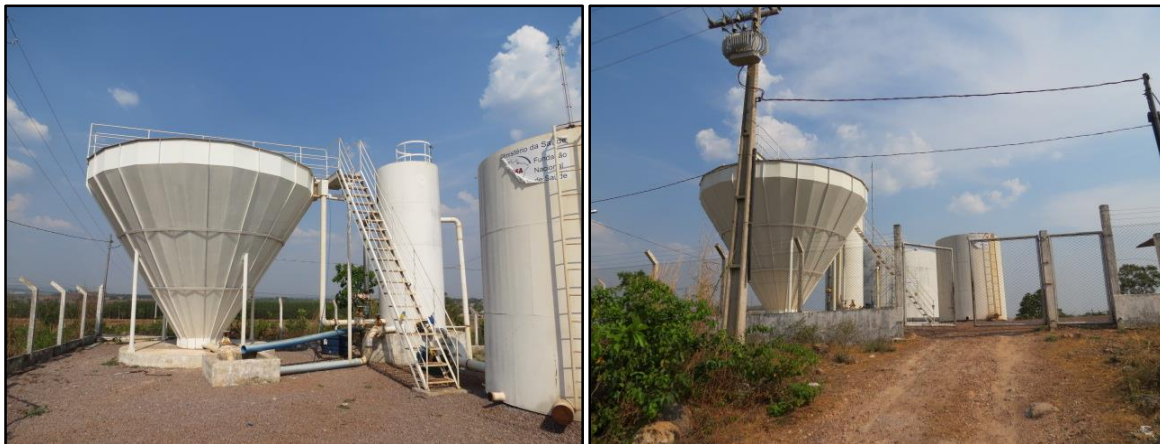
Figura 19: ETA Córrego Paciguara
