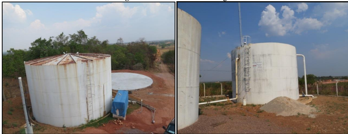
Figura 54: Reservatórios de água
