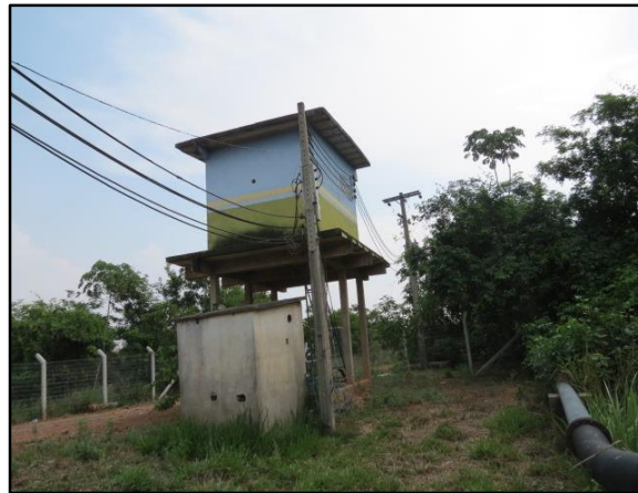
Figura 43: Adutora de água bruta do Rio Cacau
