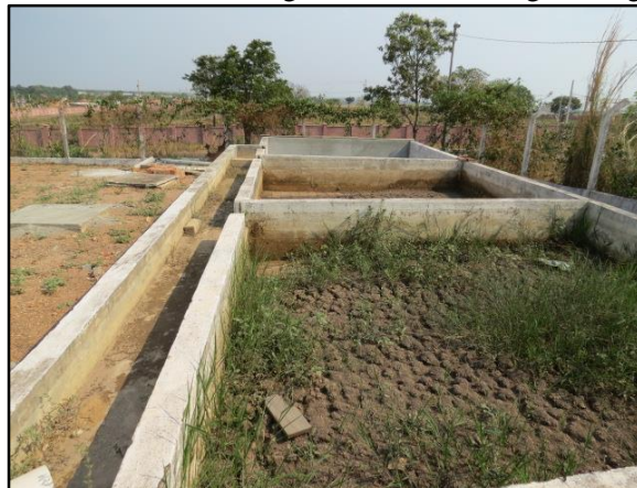
Figura 51: Leito de secagem – ETA Córrego Paciguara
