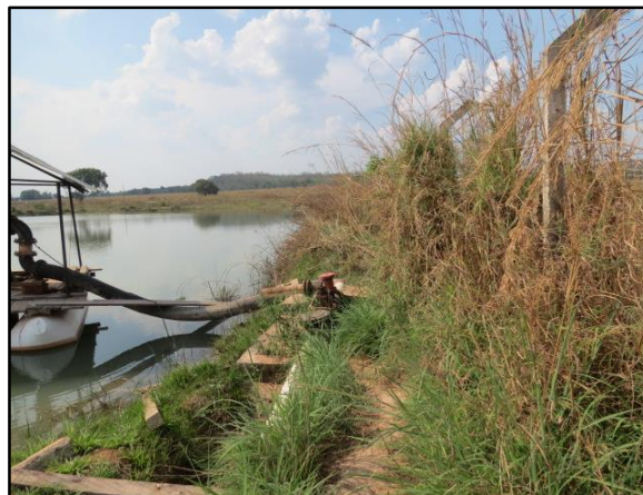
Figura 13: Adutora de água bruta do Córrego Paciguara
