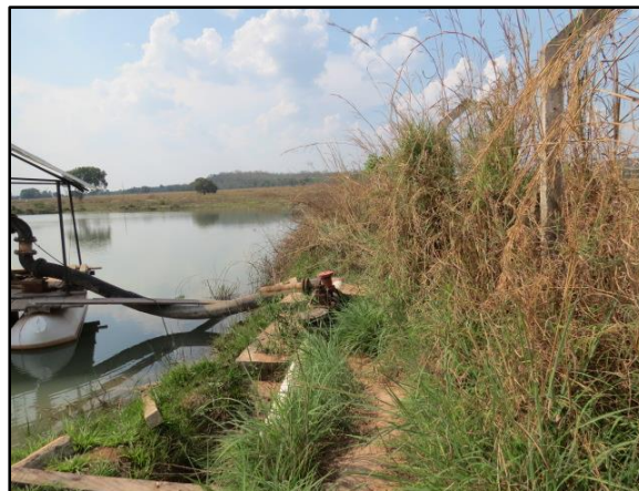
Figura 44: Adutora de água bruta do Córrego Paciguara
