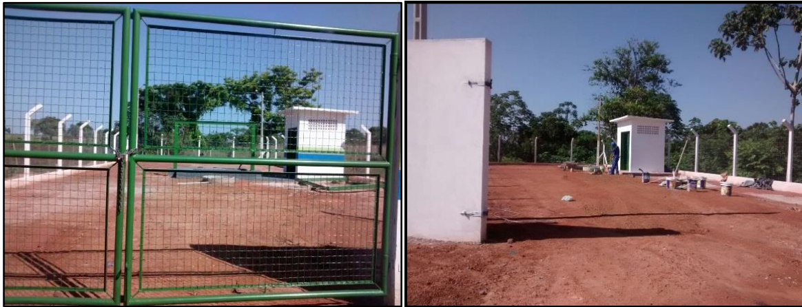
Figura 28: Estação elevatória de esgoto
