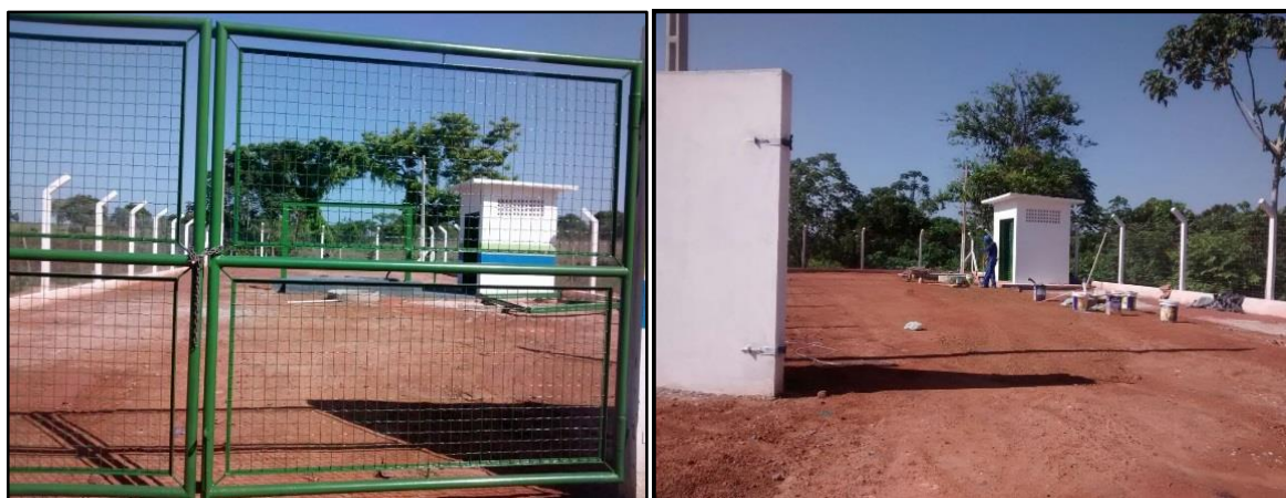
Figura 64: Estação elevatória de esgoto
