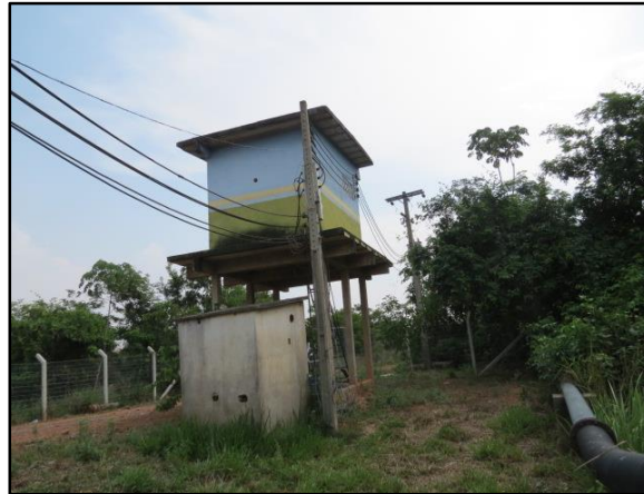
Figura 12: Adutora de água bruta do Rio Cacaú
