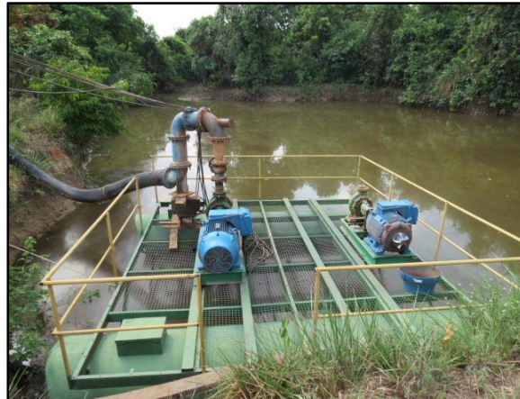
Figura 10: Captação de água bruta no Rio Cacau
