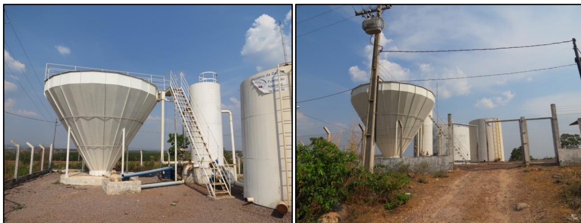
Figura 50: ETA Córrego Paciguara
