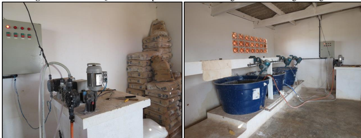
Figura 52: Casa de Química e etapa do tratamento de água - ETA Córrego Paciguara
