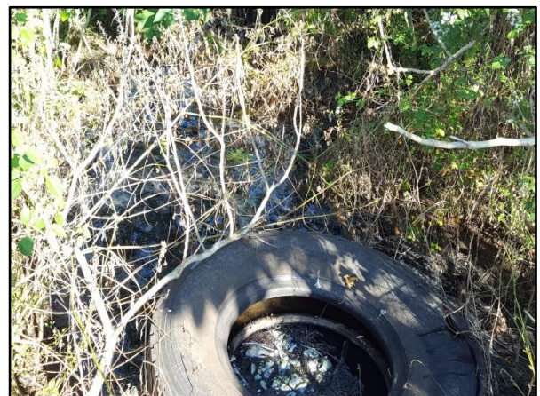
Figura 31. Esgoto transbordando na saída do filtro anaeróbio na ETE do loteamento Itamarati
