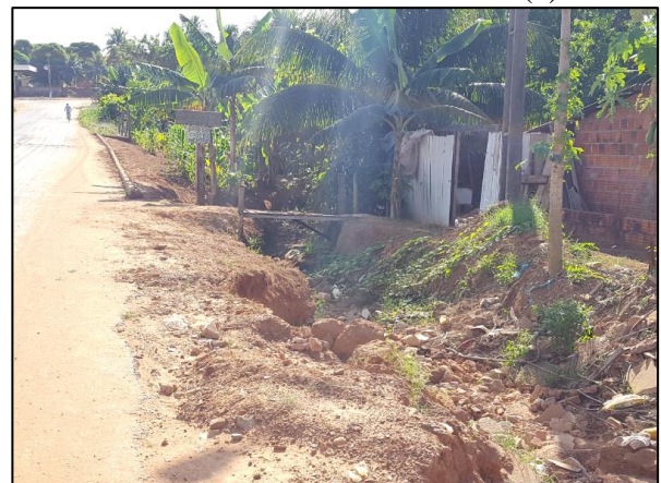
Figura 52. Processo erosivo na intersecção da Av. Curitiba com a Av. das Acácias (1)
