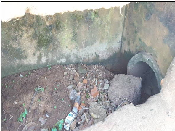
Figura 47. Boca de lobo assoreada na Rua Juscelino Kubistchek (5)
