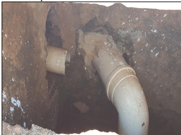
Figura 40. Ligação de esgoto no sistema de águas pluviais na Av. Mato Grosso
