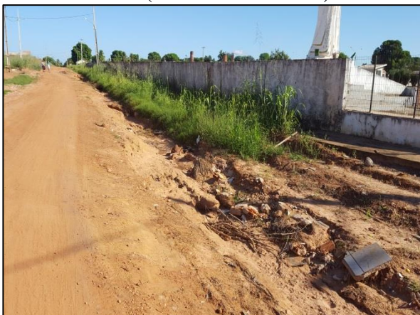
Figura 51. Processo erosivo na Rua Elizeu A. de Lima (ao lado do cemitério)
