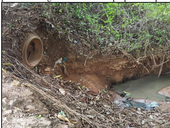
Figura 37. Desague da galeria da Av. Mato Grosso sem dissipador de energia na área de uma propriedade particular
