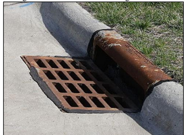
Figura 121. Boca de lobo com gradeamento
