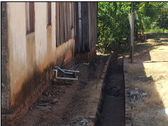
Figura 34. Lançamento de águas servidas no canal de drenagem de uma residência localizado na Av. Mato Grosso
