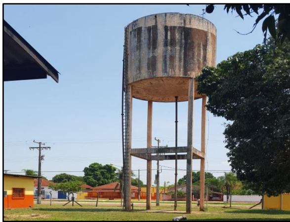
Figura 22. Reservatório REL-01 de 100,0 m 3 do Setor Centro
