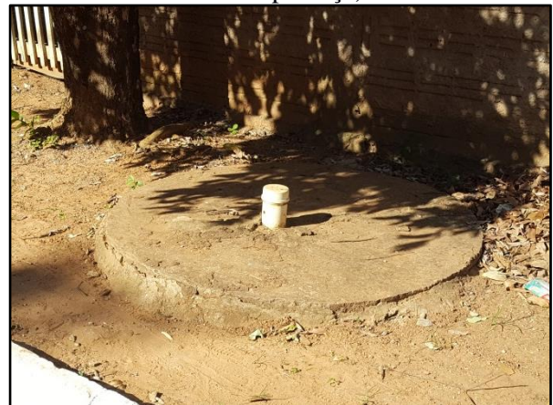
Figura 29. Fossa absorvente no passeio de uma residência localizada na Rua Seis de Maio (Setor Boa Esperança)
