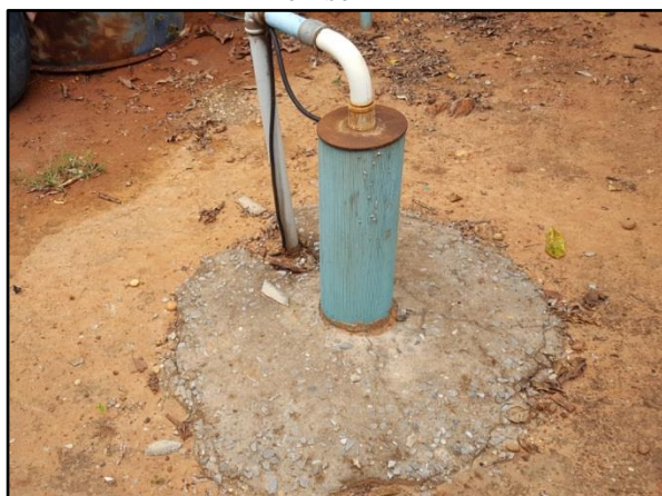
Figura 95. Poço tubular particular de uma propriedade na comunidade de Fátima, em Denise-MT
