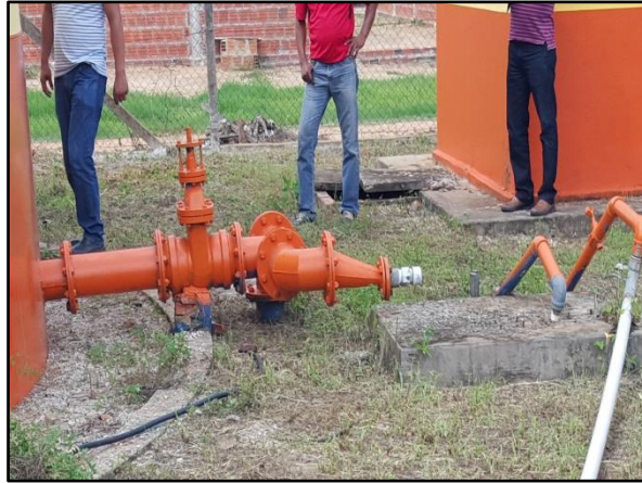
Figura 14. Barrilete para instalação de conjuntos motobomba para distribuição da água do reservatório do Recanto dos Pássaros
