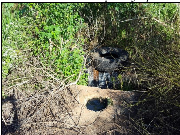
Figura 30. Área da ETE do loteamento Itamarati abandonada e tomada pela vegetação
