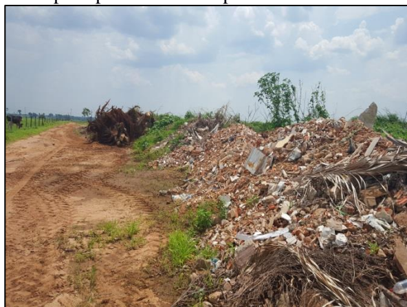
Figura 84. RCD depositado juntamente com resíduos da limpeza pública na área para resíduos inertes
