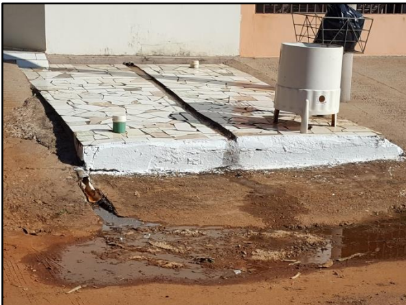
Figura 32. Lançamento de águas servidas na via pública de uma residência localizada na Rua Juscelino Kubitschek
