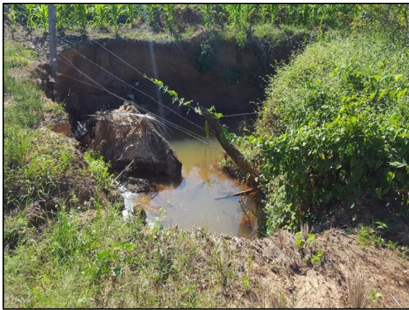
Figura 53. Processo erosivo no leito do corpo hídrico em um terreno na Av. Mato Grosso (8)
