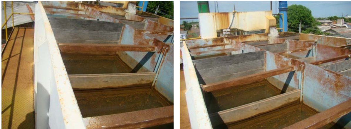
Figura 31. Flocculador hidráulico de fluxo contínuo
