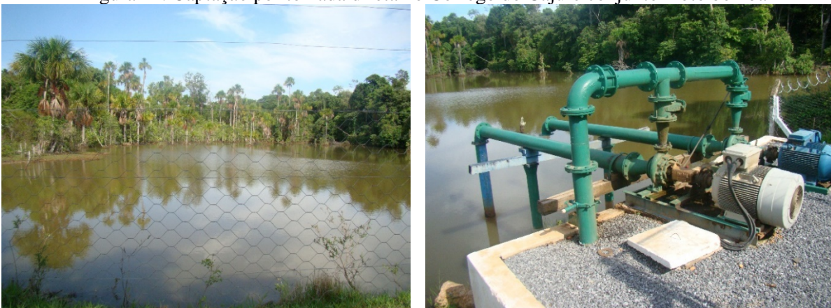
Figura 14. Captação por tomada direta no Córrego do Cajú-e conjunto moto bomba
