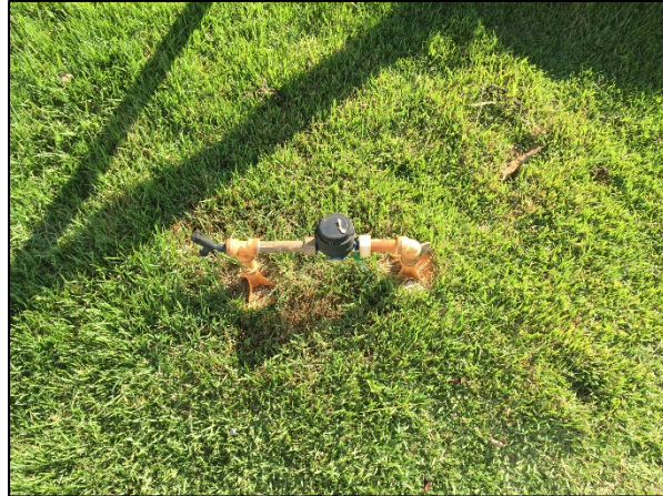
Figura 89. Ligação domiciliar com hidrômetro
