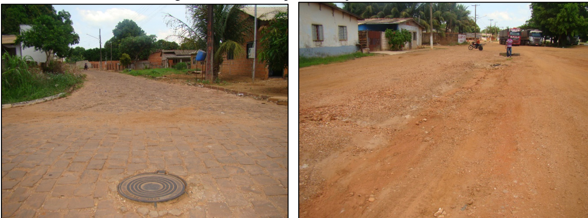
Figura 65. Ruas sem pavimentação e com PV.
