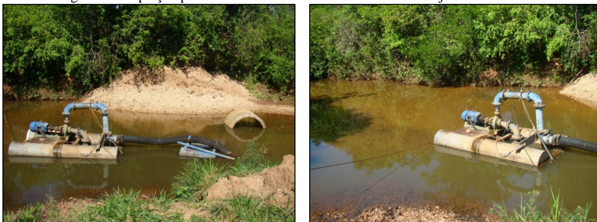
Figura 11. Captação por balsa flutuante no Rio Diamantino e conjunto moto bomba
