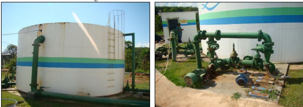
Figura 37. Reservatório Metálico de 200 m 3
