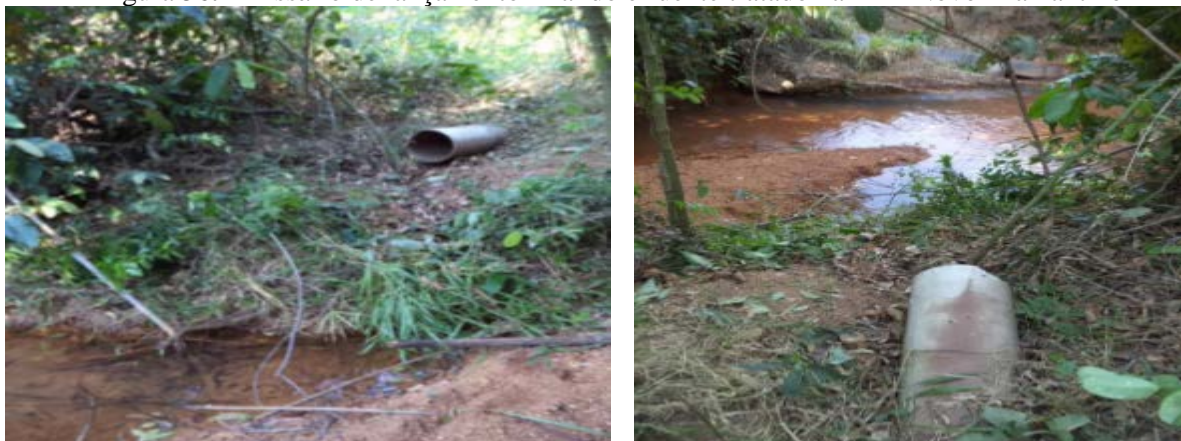
Figura 56. Emissário de lançamento final do efluente tratado na ETE Novo Diamantino
