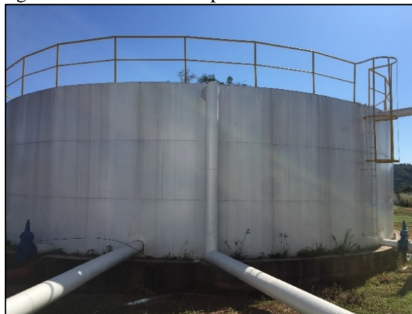
Figura 38. Reservatório apoiado metálico de 500m 3
