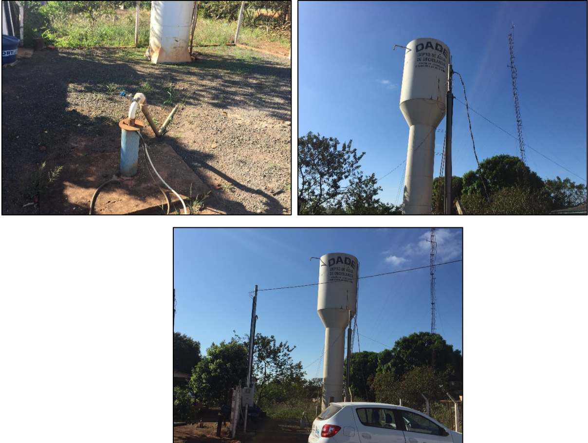
Figura 88. . Instalações do Sistema de Abastecimento de Água de Deciolândia.
