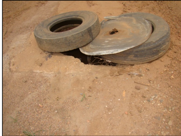
Figura 66. Poço de Visita sem tampão e manutenção
