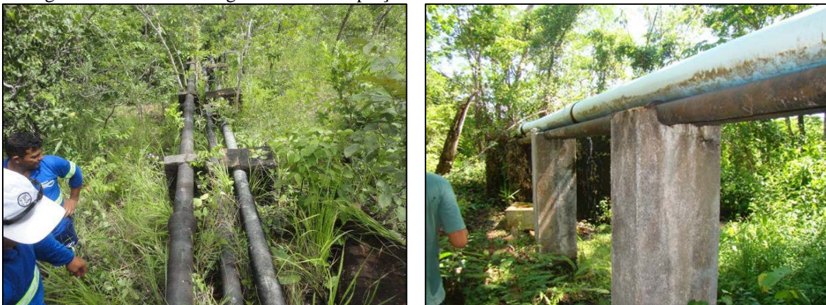
Figura 16. Adutora de Água Bruta da Captação da Mina do Areinha até a ETA Centro Histórico
