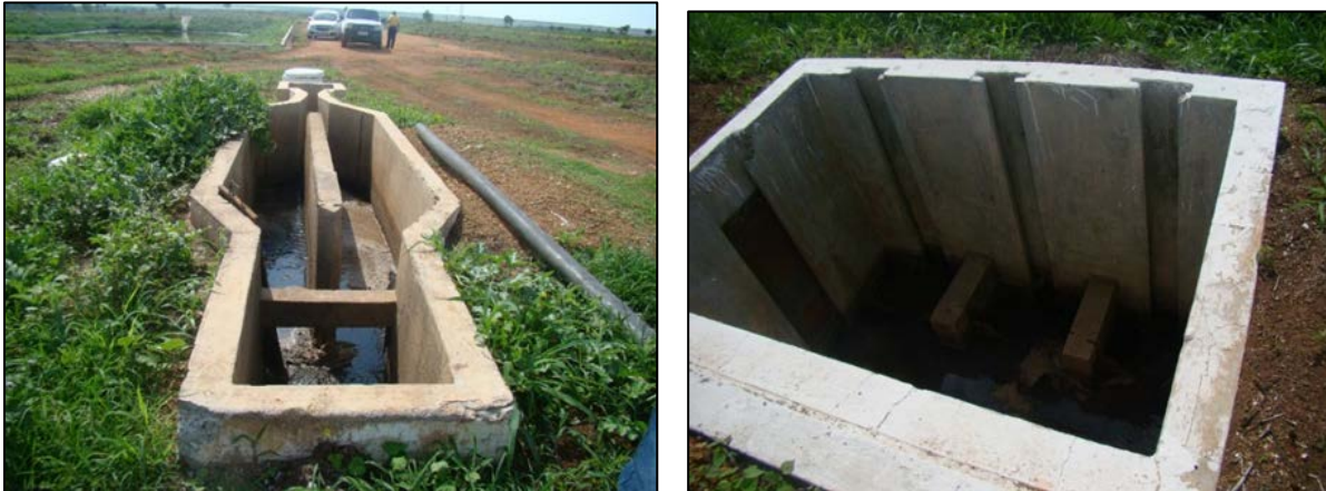
Figura 51. Tratamento preliminar com calha parshall e desarenador
