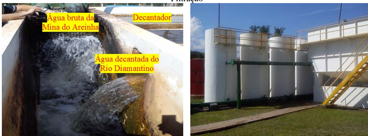
Figura 24. Processo de mistura da água do areinha e tratada do Diamantino para encaminhamento a Filtração
