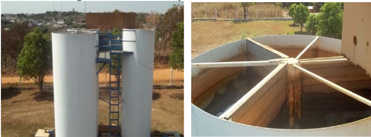
Figura 21. Câmaras de floculação e vista interna dos floculadores
