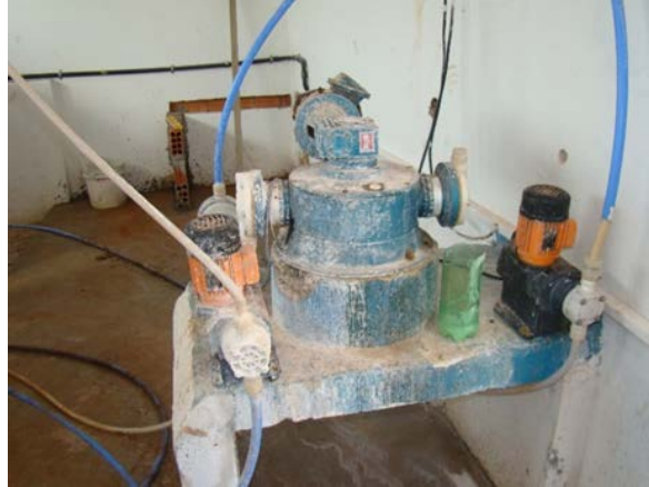
Figura 25. Bomba dosadora de hipoclorito de cálcio para os reservatórios
