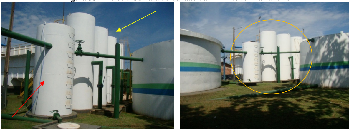
Figura 33. Filtros e Câmara de contato da ETA Novo Diamantino
