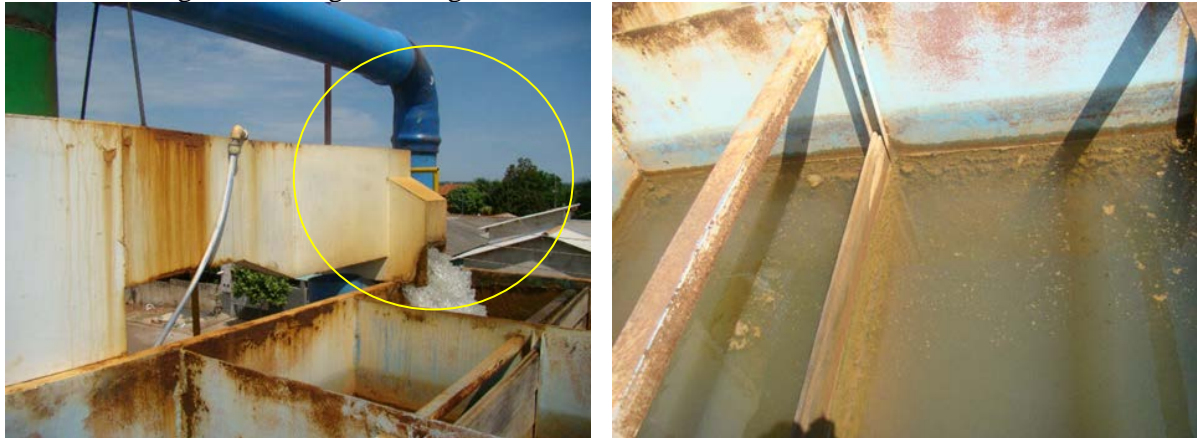
Figura 30. Chegada da Água Bruta na Calha Parshall- ETA Novo Diamantino
