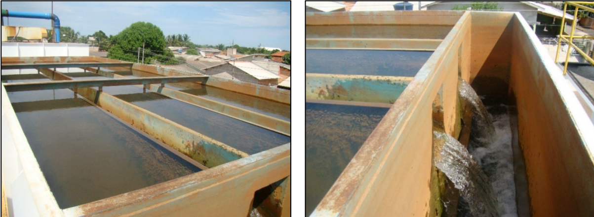
Figura 32. Decantador de placas de alta taxa
