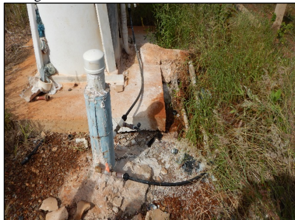
Figura 66. Clorador na base do reservatório.
