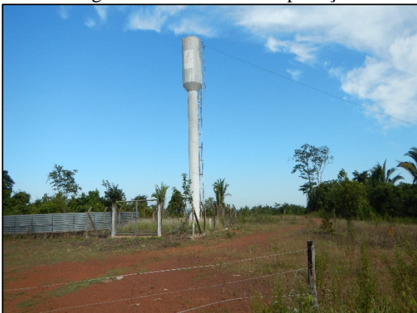
Figura 65. Reservatório tipo taça
