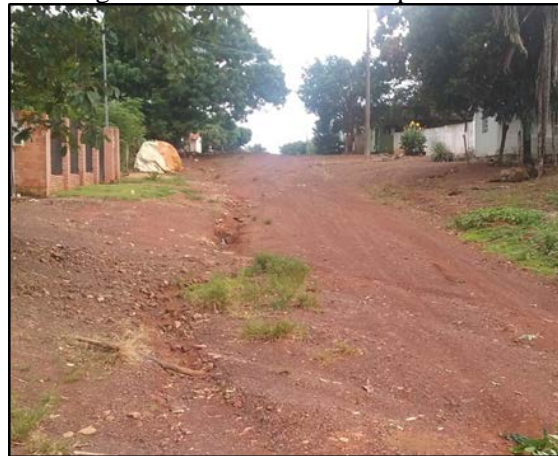
Figura 32. Erosão vias sem pavimento
