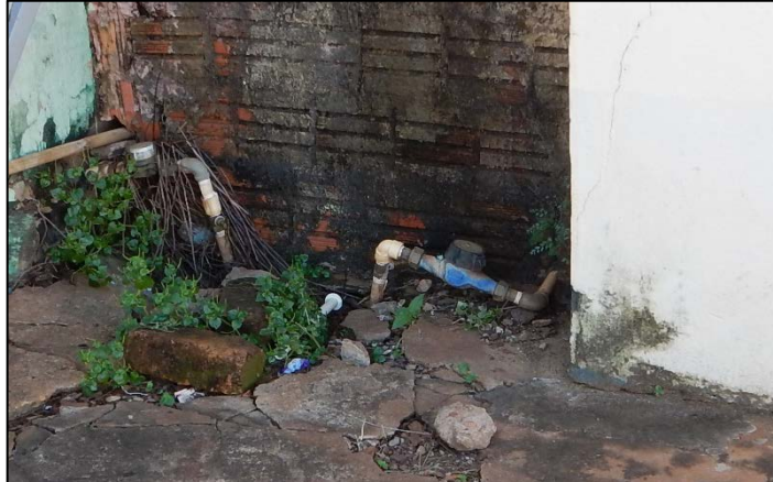
Figura 58. Vista exterior de ligação domiciliar e hidrômetro
