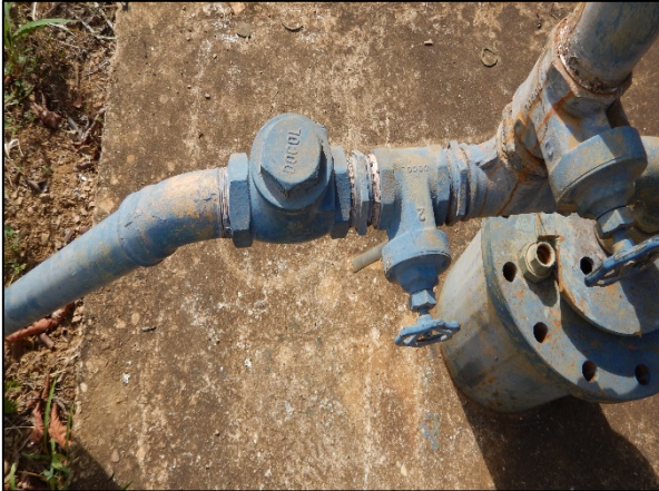
Figura 63. Cavalete de saída
