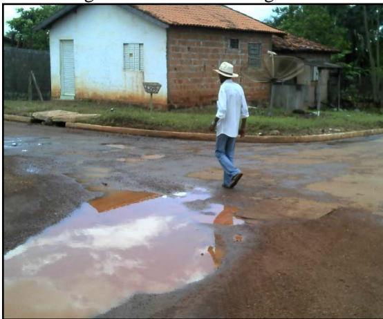
Figura 31. Pontos de alagamento
