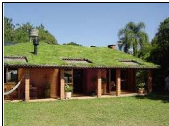
Figura 90. Telhado verde com plantas
