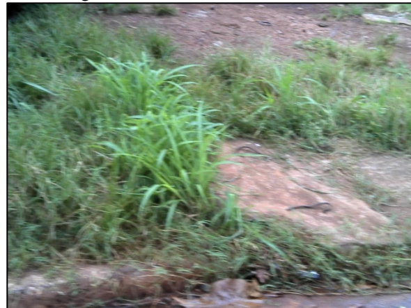
Figura 30. Boca de lobo obstruída
