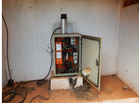
Figura 64. Quadro de comando.
