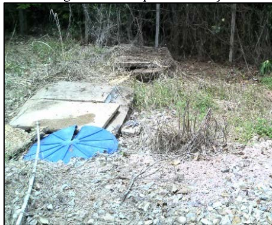
Figura 24. Tanque de Cloração
