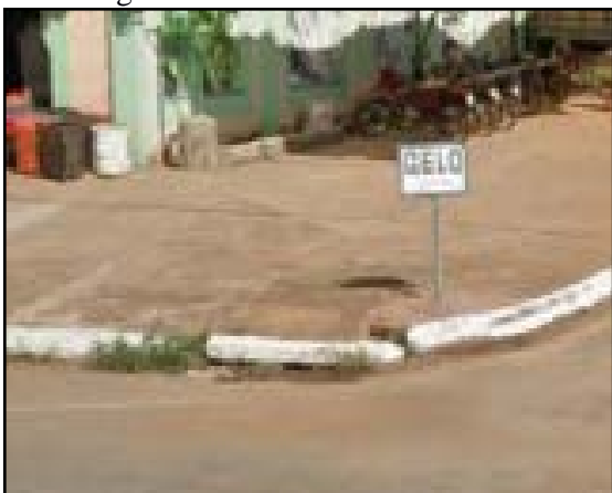
Figura 33. Boca de lobo obstruída
