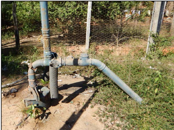
Figura 54. Cavalete de saída do poço
