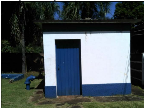
Figura 9. Abrigo do Quadro de comando
