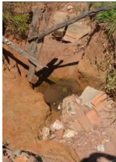
Figura 37 - Erosão causada pelo lançamento de águas pluviais (fim da microdrenagem) sem a dissipação de energia.
