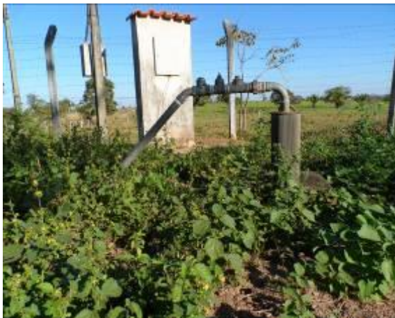
Figura 24 – Poço e quadro de comando.
