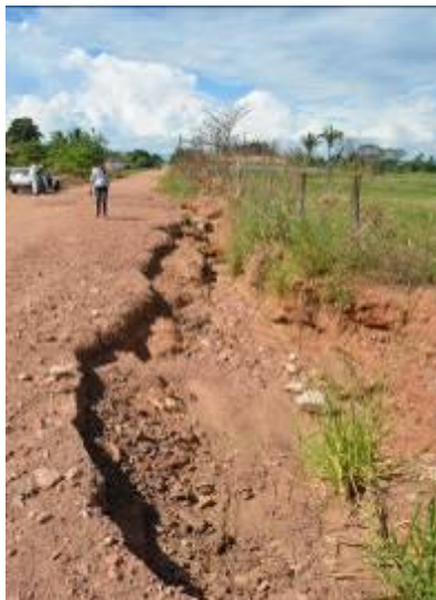
Figura 36- Erosão em via não pavimentada.
