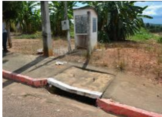
Figura 33– Boca de lobo com tampa cedendo.
