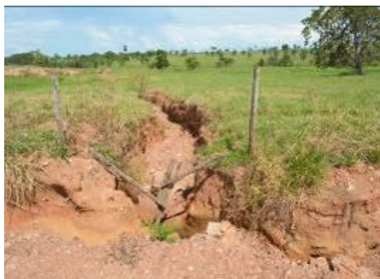
Figura 35 - Erosão causada pelo lançamento de águas pluviais (fim da microdrenagem) sem a dissipação de energia.
