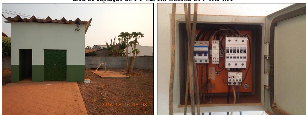
Figura 10. Quadro de comando elétrico da bomba localizado em um abrigo de alvenaria no interior da área de captação do PT-02, em Gaúcha do Norte-MT
