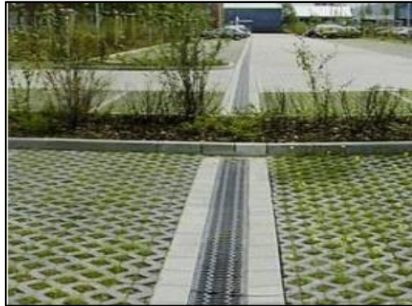
Figura 92. Trincheira de infiltração no estacionamento
