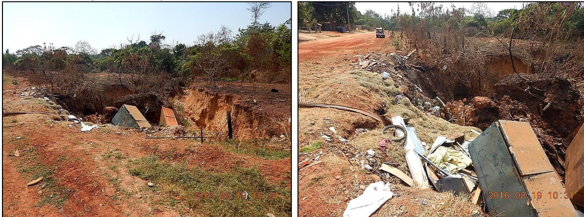
Figura 27. Voçoroca existente na Rua São Paulo, em Gaúcha do Norte-MT
