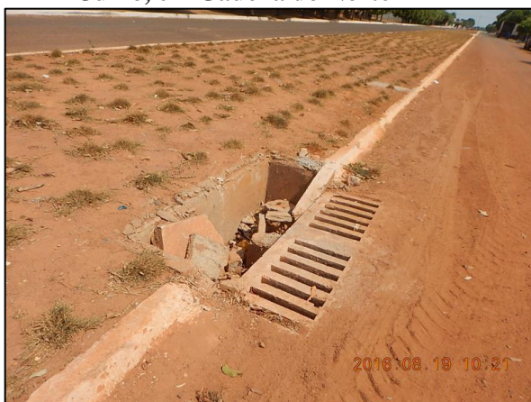
Figura 23. Boca de lobo com a estrutura física comprometida localizada na Avenida 13 de Julho, em Gaúcha do Norte-MT
