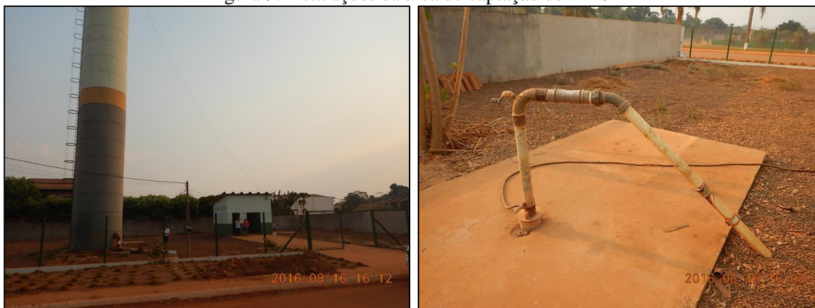
Figura 9. Instalações da área de captação do PT-02
