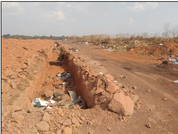
Figura 33. Vala localizada na borda direita da estrada interna do lixão de Gaúcha do Norte-MT
