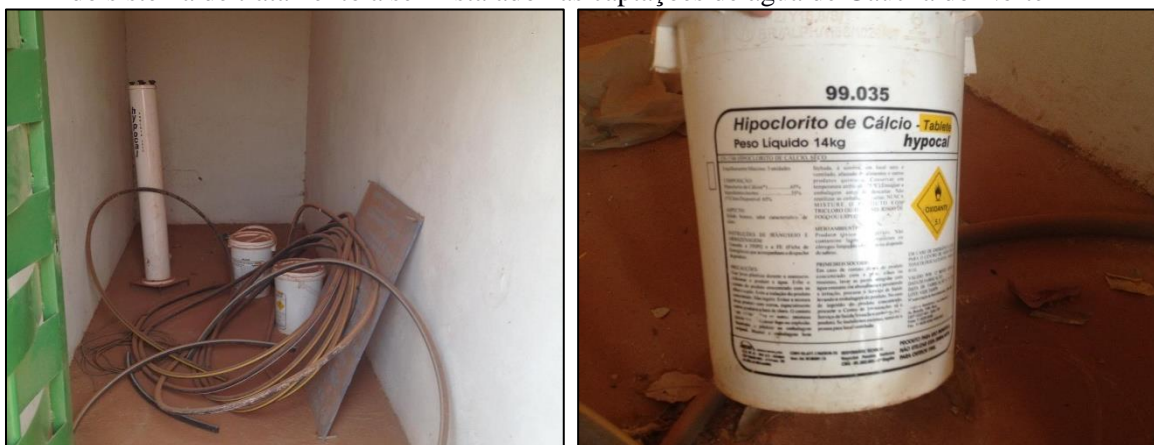
Figura 13. Dosadores e tabletes de hipoclorito de cálcio dispostos no chão das instalações para abrigo do sistema de tratamento a ser instalado nas captações de água de Gaúcha do Norte-MT
