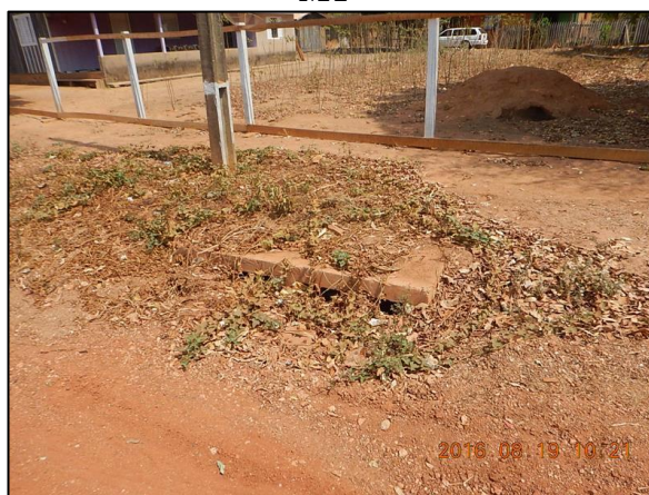
Figura 24. Boca de lobo obstruída pelo crescimento de gramíneas, localizada na Avenida 13 de Julho, em Gaúcha do Norte-MT
