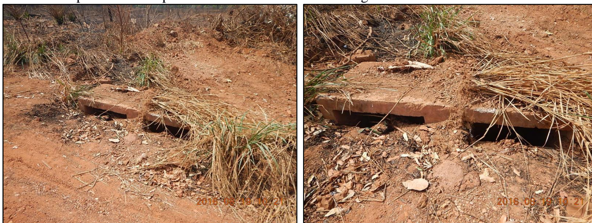
Figura 25. Boca de lobo localizada na confluência da Avenida 13 de Julho com a Rua São Paulo, representando o ponto final da rede de microdrenagem de Gaúcha do Norte-MT
